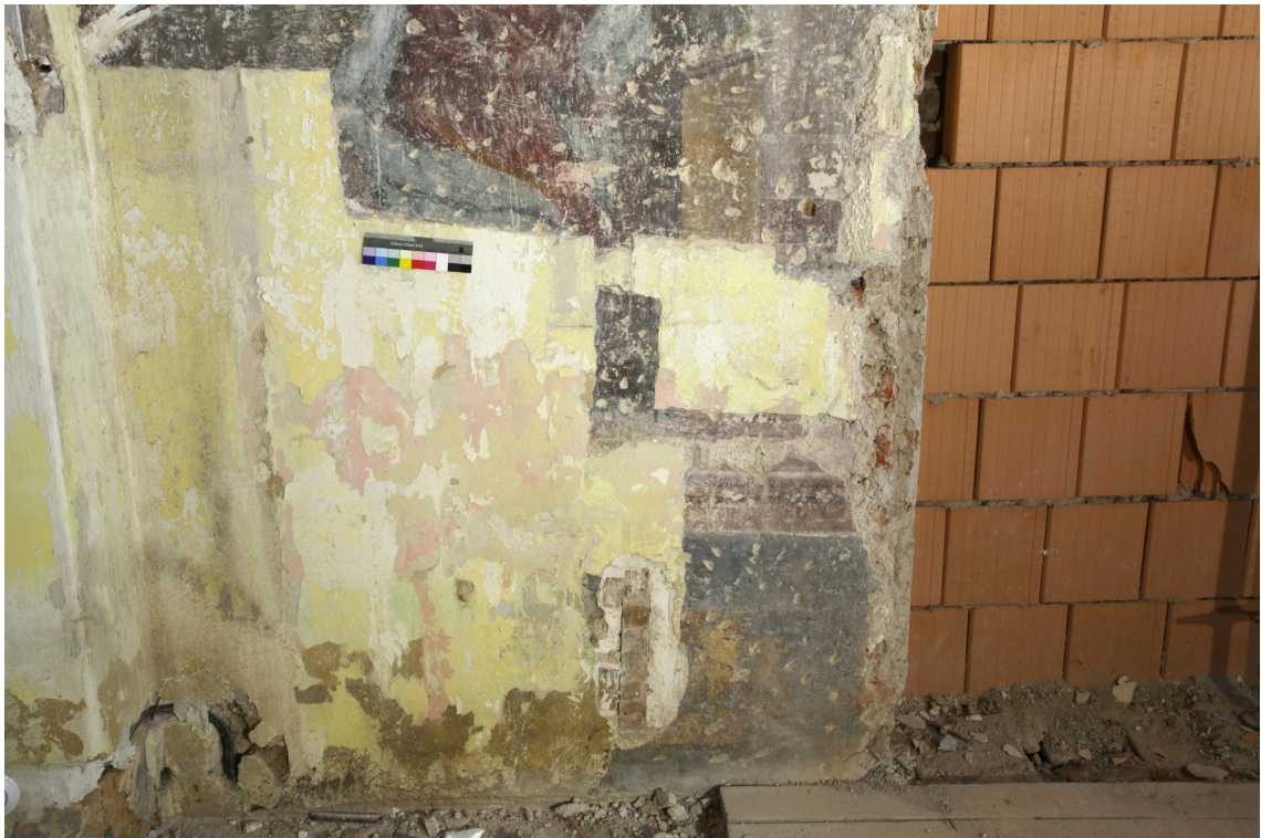
Obr. 15: Spodná polovica, sonda na konkrétnu vrstvu s Pannou Máriou z výjavu Zvestovanie . V soklovej časti sa nachádza obtmelené drevo. Stav pred reštaurovaním.
