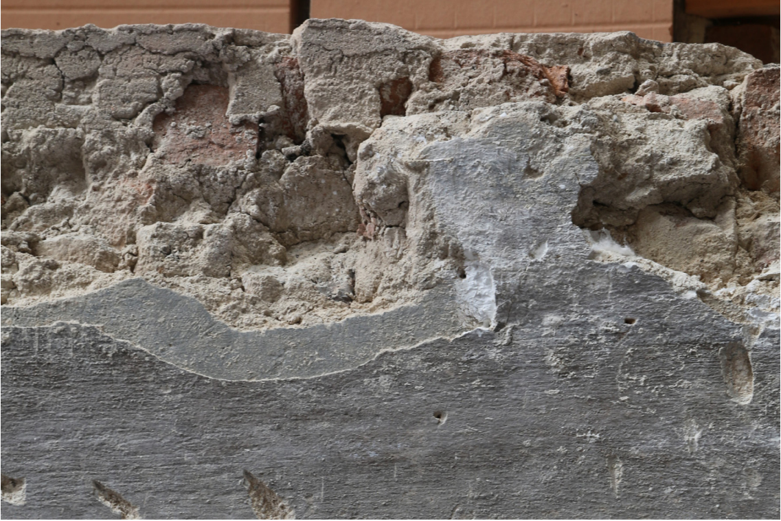
Obr. 20: Detail originálnej omietky s maľbou pod dorovnávacou omietkou a stopy vo forme odtlačku po dvernom ráme, ktorý kopíroval dverný otvor. Stav pred reštaurovaním.
