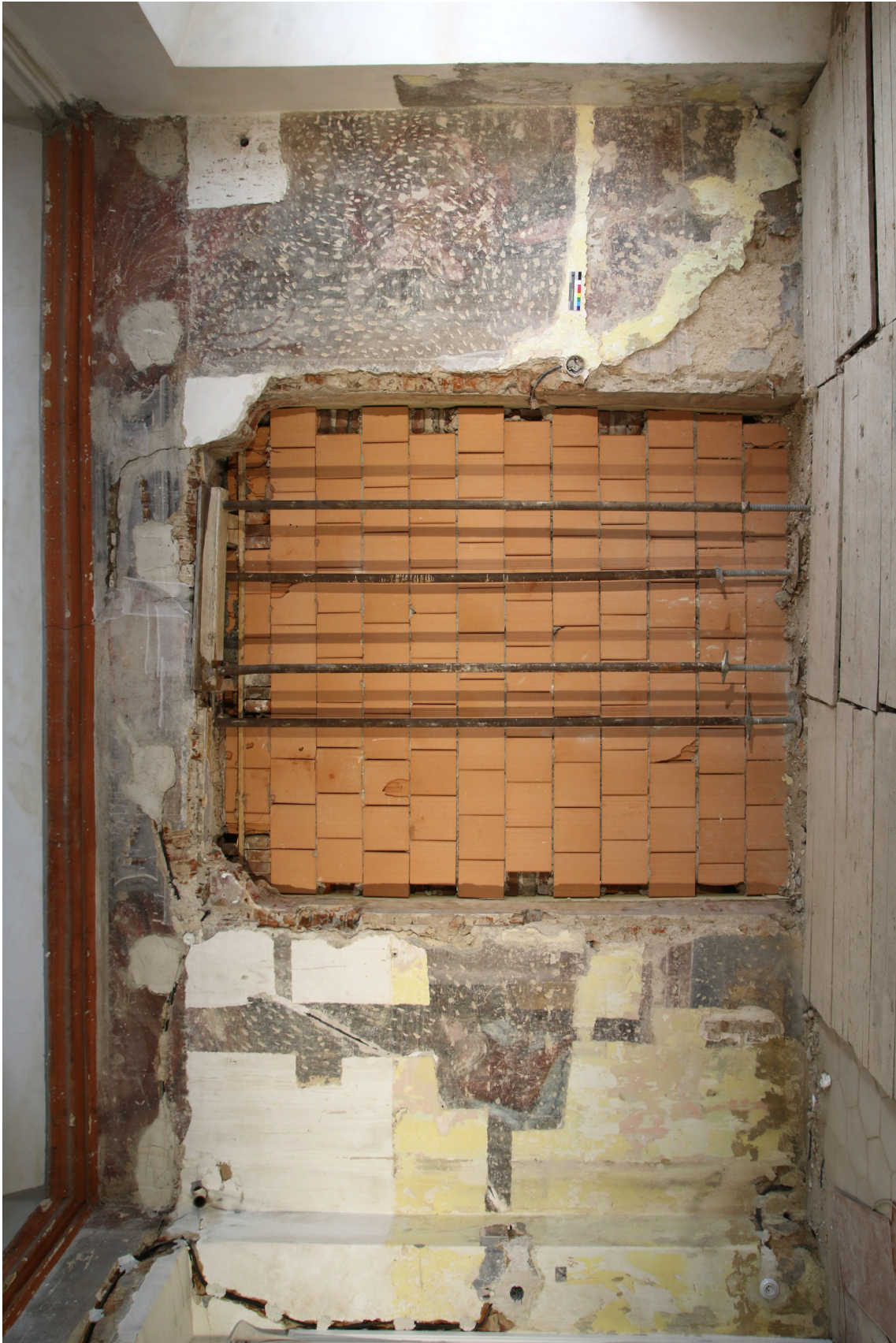
Obr. 13: Celok maľby Zvestovanie po čiastočnom výbúraní dverného otvoru. Stav pred reštaurovaním.
