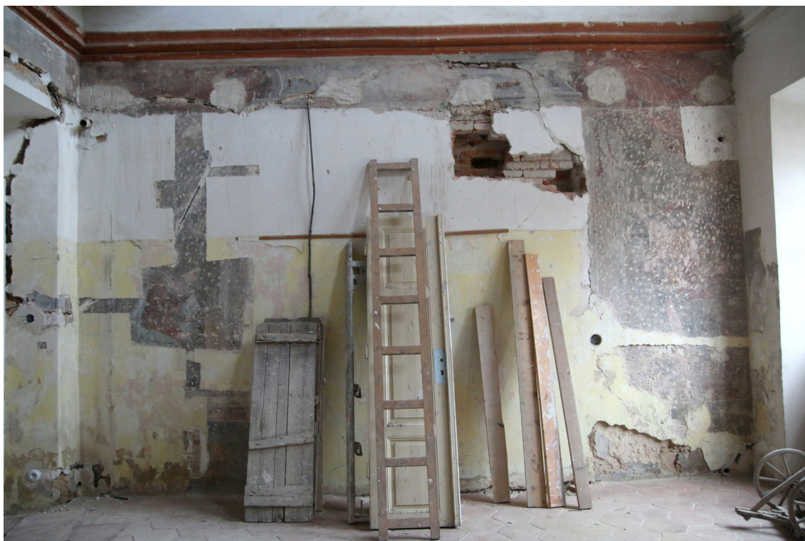
Obr. 12: Celok maľby Zvestovanie pred vybúraním dverného otvoru, ktorý sprístupňoval zámockú kaplnku. Stav pred reštaurovaním.
