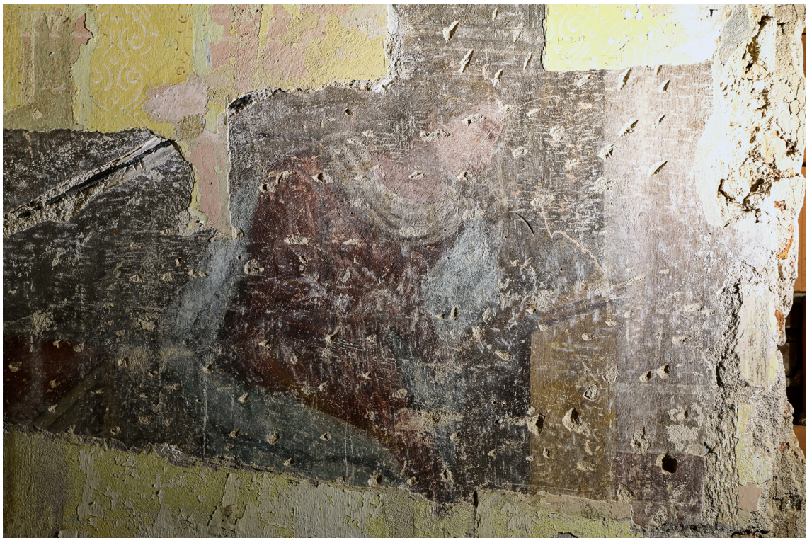
Obr. 24: Veľkoplošná sonda na konkrétnu vrstvu v ostrom bočnom nasvietení. Pri tomto nasvietení sa zviditeľnili poškodené miesta omietkovej vrstvy, akými sú mechanické poškodenia pekovaním, lokálne vrypy a elektroinštalácia. Stav pred reštaurovaním.
