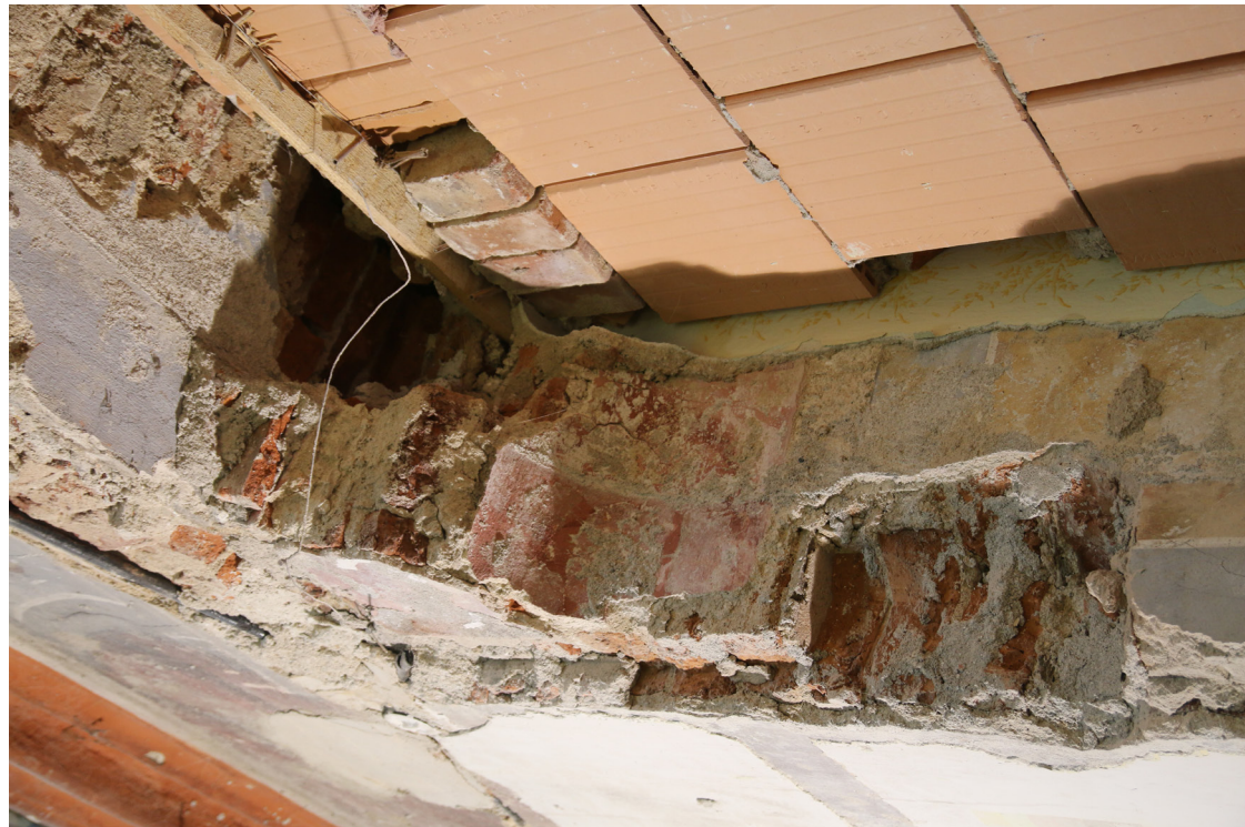
Obr. 19: Zárubňa dverného otvoru s fragmentami maľby. Stav pred reštaurovaním.
