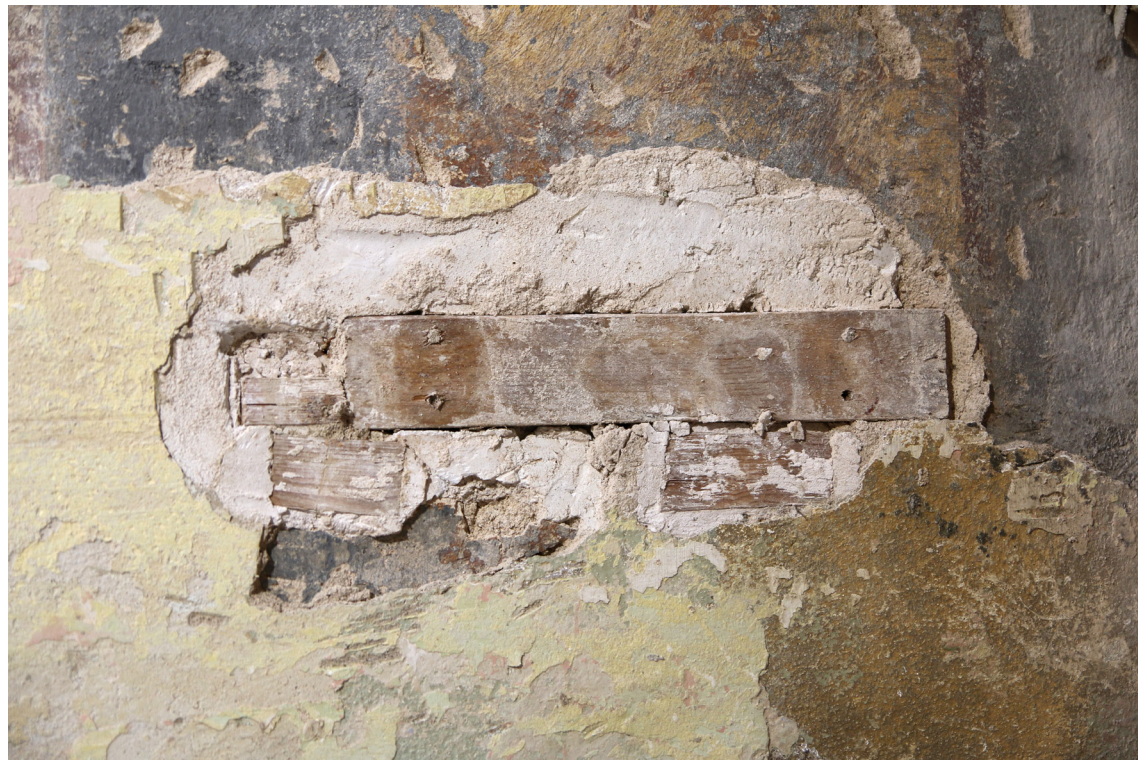
Obr. 21: Poškodenie v soklovej časti pridaním druhotných vrstiev a dreva do pôvodnej omietkovej vrstvy. Stav pred reštaurovaním.
