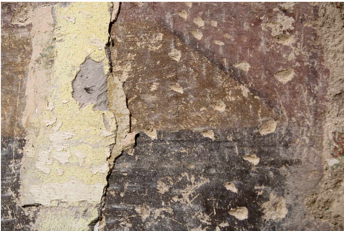
Obr. 22: Detail mechanického poškodenia pekovaním a povrchového poškodenia farebnej a omietkovej vrstvy na výjavu Zvestovanie. V miestach druhotných vrstiev je možné pozorovať použitie spojiva na báze cementu v škárovacej vrstve omietky. Stav pred reštaurovaním.
