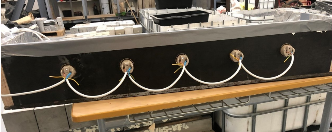
Obrázek 23: Elektrifikace kolejnicového reflektoru
