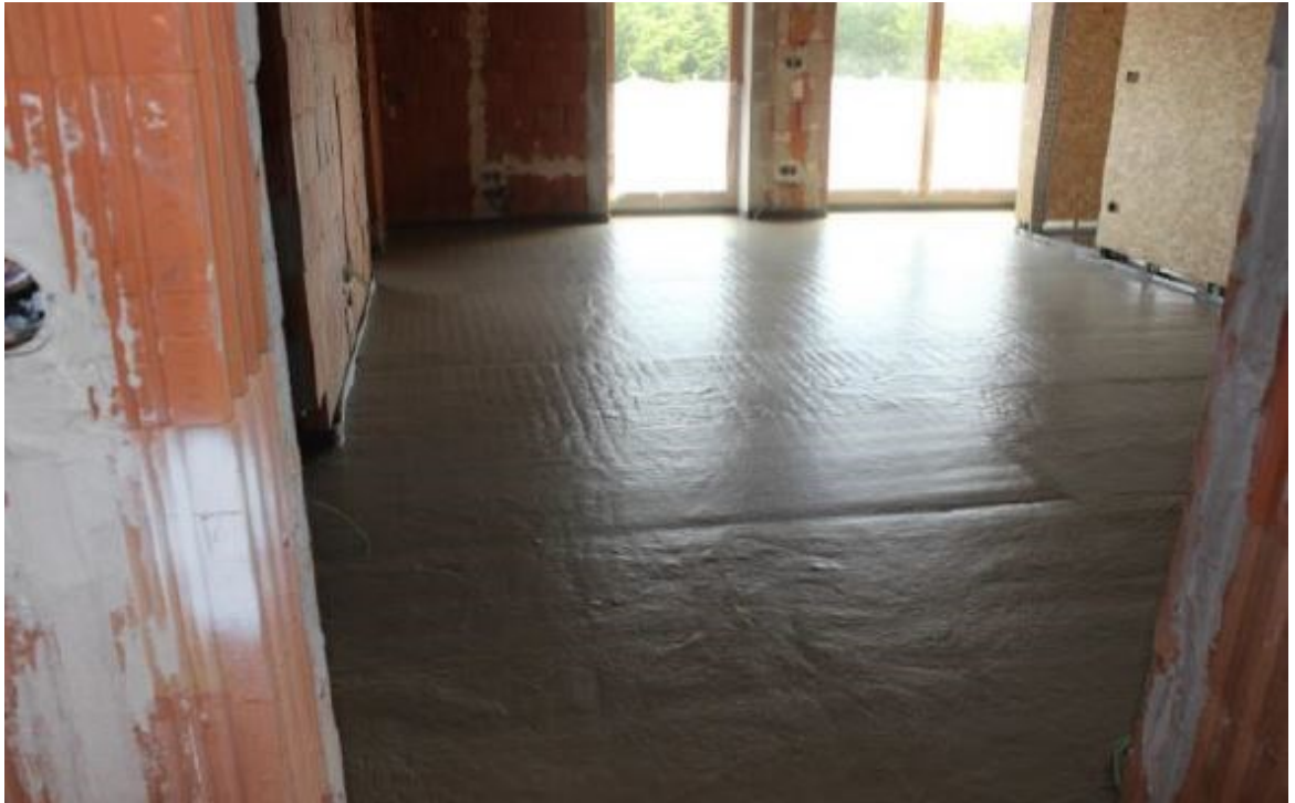
Obr. 14: Pěnobetonová podlaha v rodinném domě [8]
