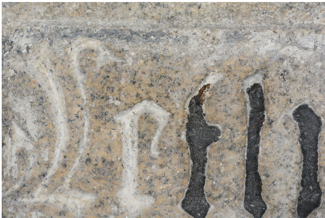
Obr. 50 Detail chýbajúcej a poškodenej časti výplne písma na nápisovej doske. Stav po odstránení druhotných vrstiev.
