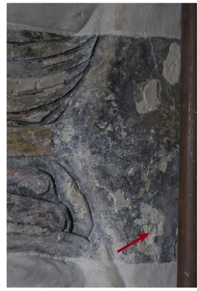
Obr. 11: Detail místa odběru vzorků V11 a V24 (S2). Pahorek, jádrová omítka s druhotnými nátěry (bez modeliční vrstvy).
