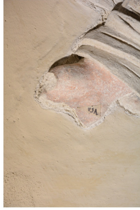
Obr. 5: Detail místa odběru vzorku V5A. Zděný sokl pod erbem Rosiny z Vartenberka. Cementová malta se svrchní omítkou/cementová malta s cihlou.
