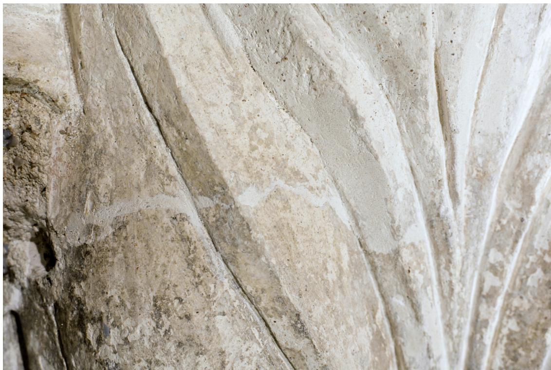
Obr. 76 Tmelenie prasklina po injektovaní a väčších defektov v úrovni pravej nohy ľavého anjela. Stav po odstránení druhotných vrstiev a injektovaní dutín.
