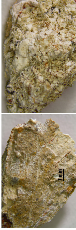
V15/I0171: tmel žuly s červenou barevnou úpravou a druhotným okrovým nátěrem Místo odběru vzorku: tympanon, pravá část
