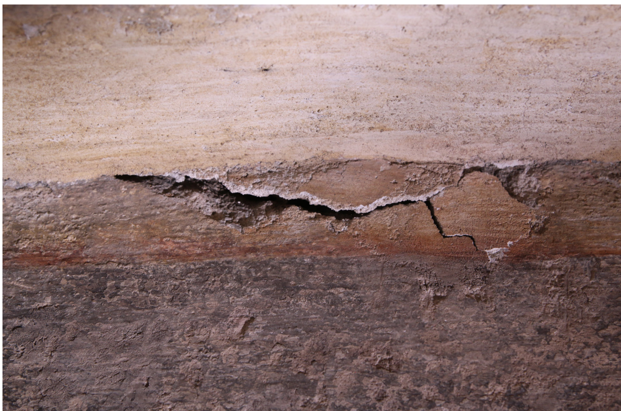
Obr. 12: Detail poškození. Prasklina v pravé horní části restaurovaného úseku v jihozápadním rohu místnosti. Fotografie v ostrém bočním nasvícení. Stav před restaurováním.
