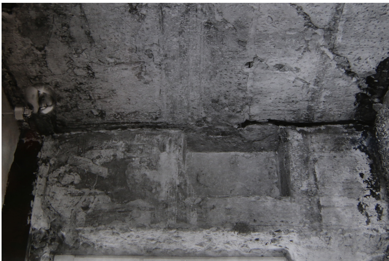
Obr. 03: Historická fotografie z r. 1980. Jihozápadní roh místnosti se zřetelnou částí malby allegorie Geometrie. Patrná je zde statická trhlina, četné pekování omítky. (Z archivu NPÚ ÚOP České Budějovice.)
