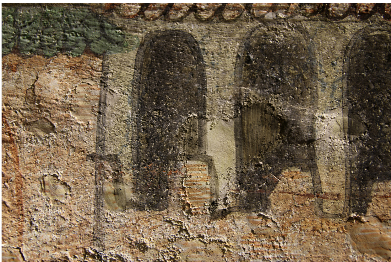
Obr. 15: Pohľad na veľký tmel, ktorý bol pritmelený k odpuknutej pôvodnej malbe a nezpracovaný okraj v ostrom bočnom nasvietení. Najmä na ľavej časti v oblasti rámu na reštaurovanom úseku. Stav pred reštaurovaním .
