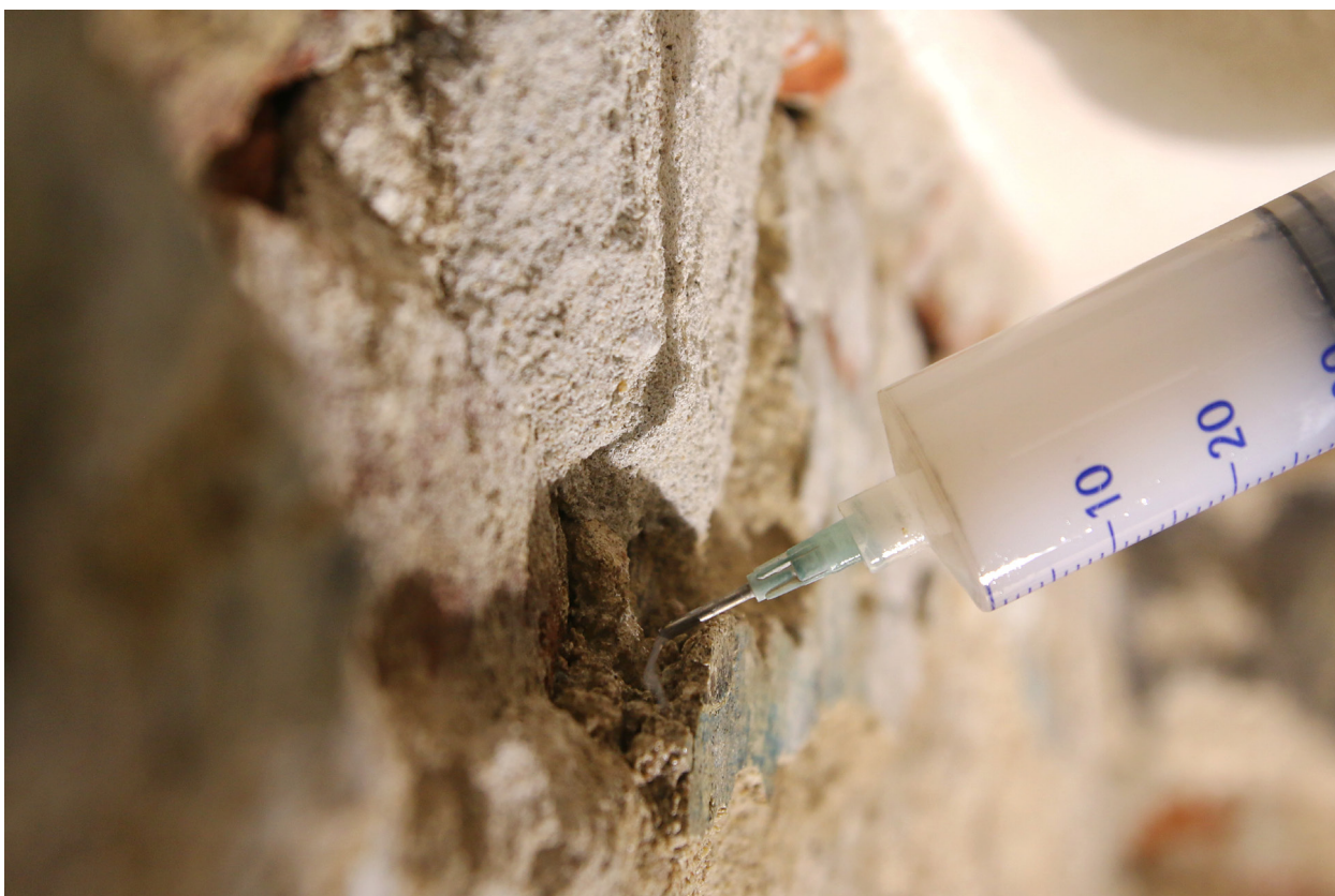
Obr. 33: Detail na prelep v hornej časti výjavu. Každá časť nájdených fragmentov si vyžadovala iný prístup podľa rozsahu poškodenia. Stav pred spevnením omietkovej vrstvy a po obtmelení v spodnej oblasti fragmentu.
