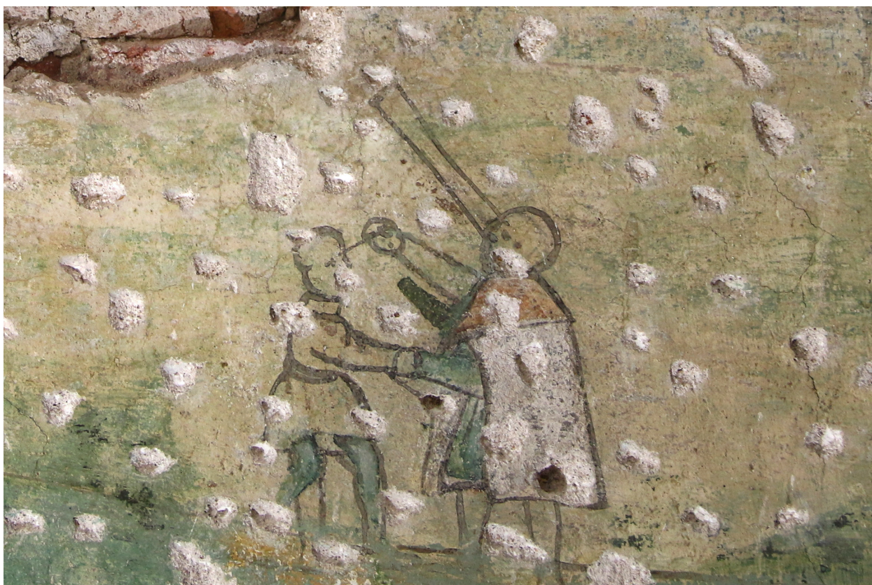
Obr. 25: Pohľad na ľavú vrchnú časť kde sa v minulosti nachádzal drevený trám. Na fotografii môžeme vidieť drevené laty (pravdepodobne slúžili ako podložka pod trám), taktiež sú tu viditeľné vepřovicové tehly (oranžovejšej farby). Stav po ostránení nevyhovujúceho veľkoplošného tmelu.
