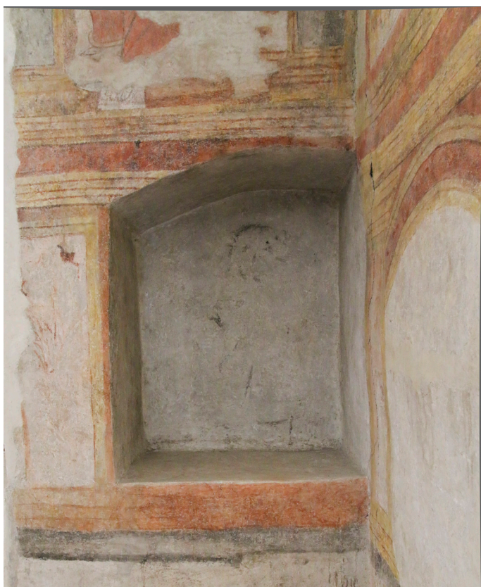
Obr. 10: Grafické znázornění velkoplošných tmelů na jižní stěně místnosti zdůrazňuje posun zdiva v zazděných nikách pilířového systému. Zdroj: Dokumentace restaurátorského průzkumu: Průzkum nástěnných maleb v 1. patře, nám. Míru čp. 480, 2018.
