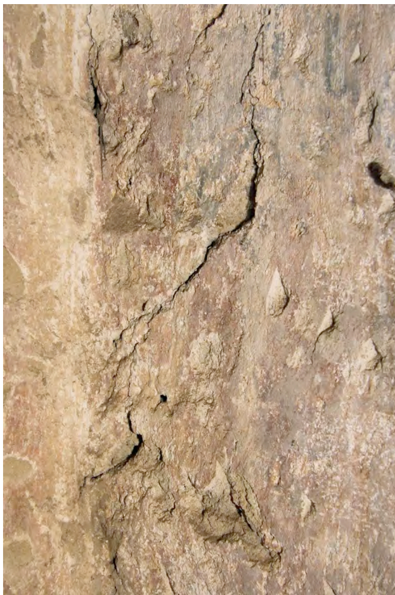
Obr. č. 92 Praskliny v blízkosti rohu mezi levou stranou vítězného oblouku a severní stěnou.
