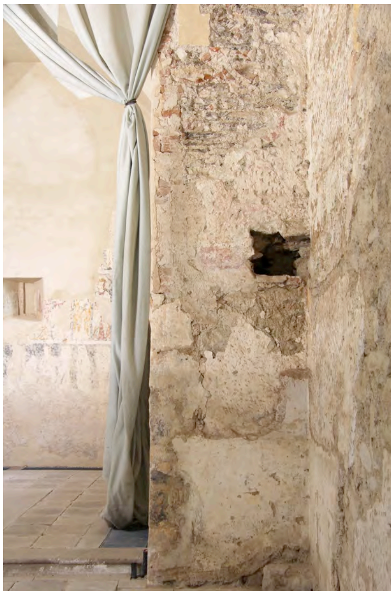
Obr. č. 84 Prává strana vítězného oblouku, stav před restaurováním.
