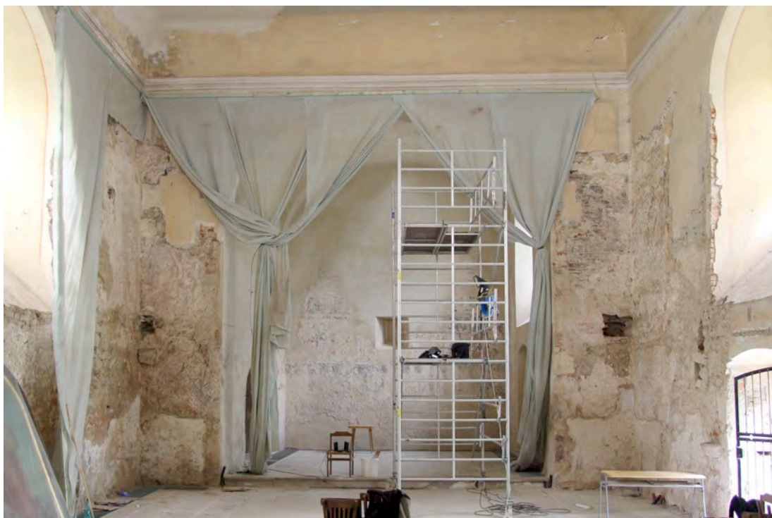
Obr. č. 83 Celkový pohled na vítězný oblouk, stav před restaurováním.
