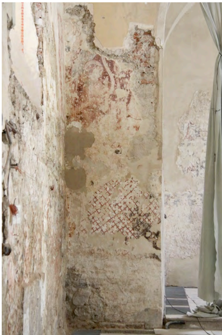
Obr. č. 121 Levá strana vítězného oblouku, stav po vytmelení.
