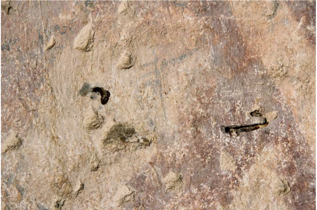
Obr. č. 93 Tvář archanděla Gabriela, stav před restaurováním. V malbě jsou zatlučeny železné skoby, na povrchu jsou pozorovatelné různé nečistoty, bílý zákal a mechanická poškození.
