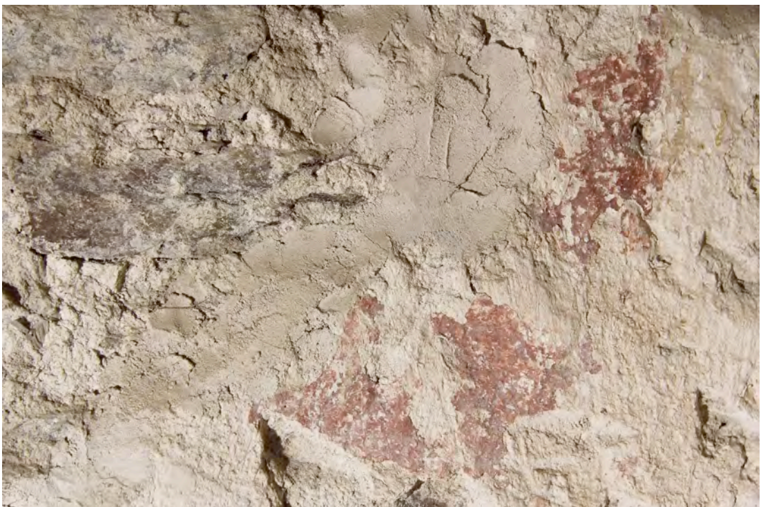
Obr. č. 97 Detailní snímek fragmentu na levé straně vítězného oblouku. Snímek dokumentuje vzhled zajišťovacích tmelů z let 1976 a 1984.
