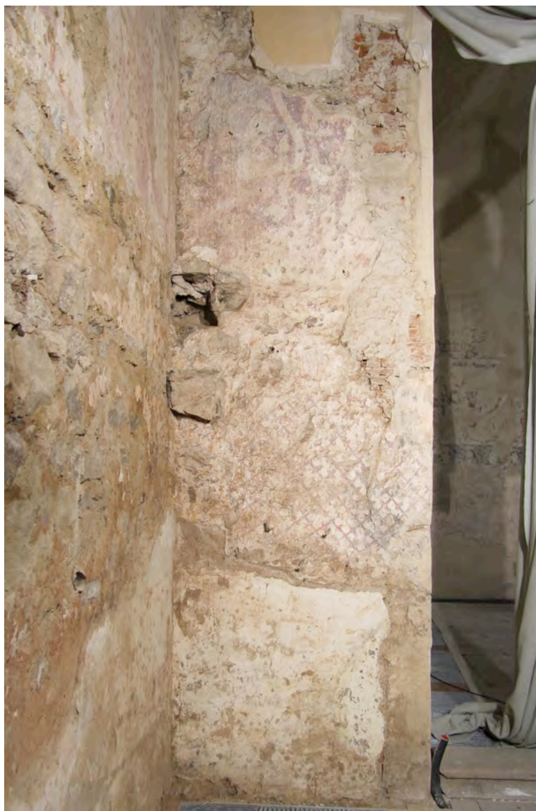
Obr. č. 85 Levá strana vítězného oblouku, stav před restaurováním.
