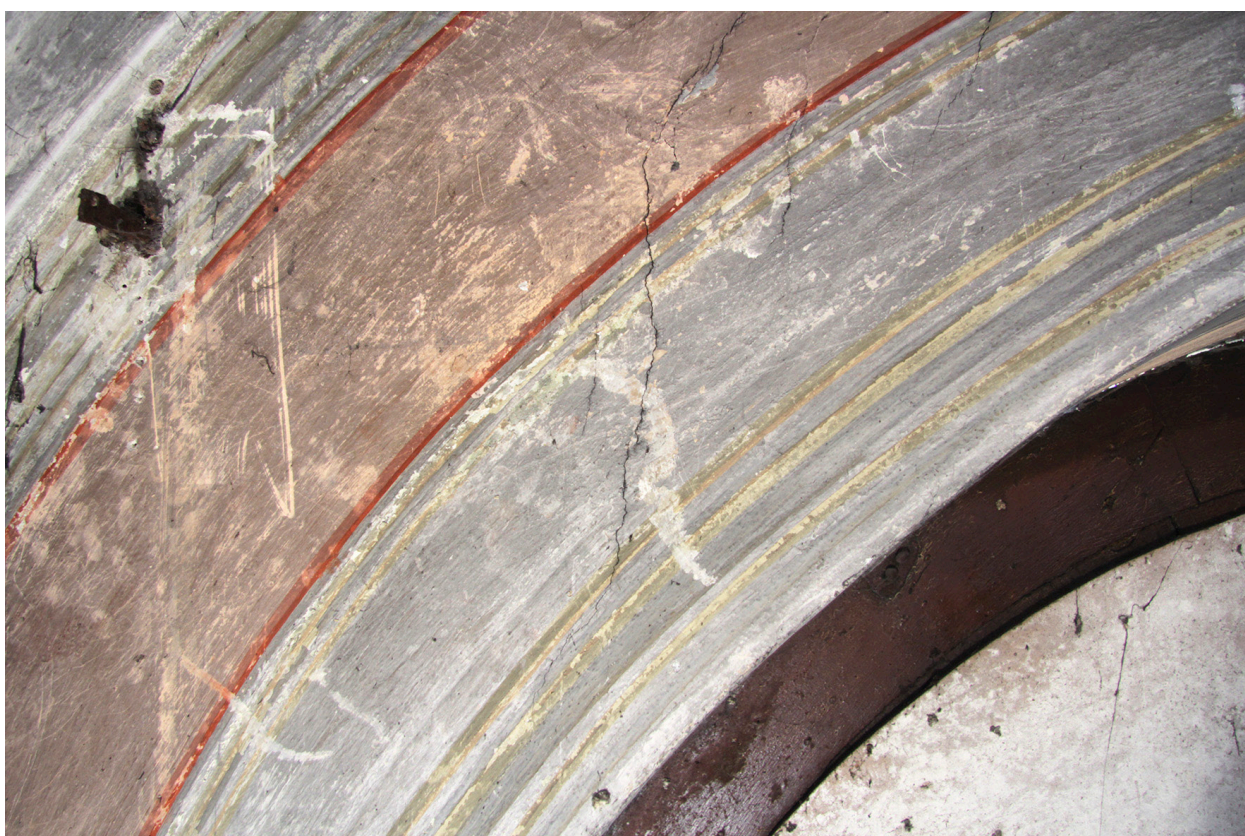
Obr. 37: Poškození přemalby v ostrém bočním nasvícení, ztráta adheze. Linky nad oknem SZ stěny. Stav před restaurováním.
