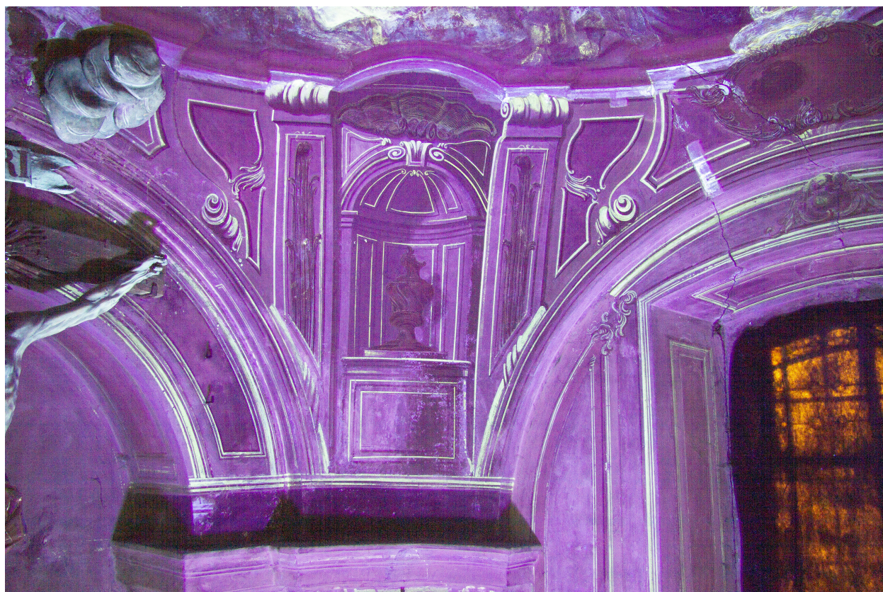
Obr. 15: Ztmavlá přemalba z 19. století. Pendentiv ve východním koutě kaple, část nad oltární nikou a část JV stěny. Stav před restaurováním.
