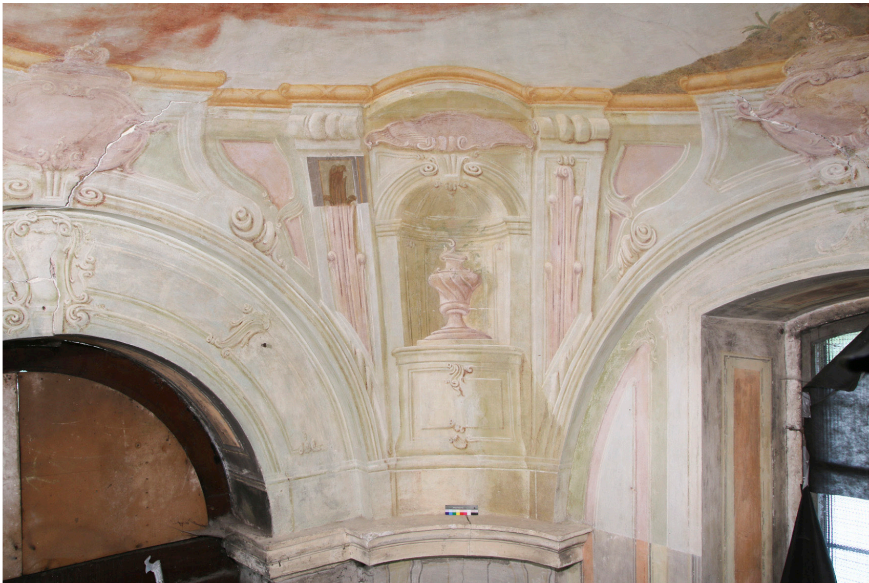
Obr. 75: Celkový pohled na západní kout kaple. Stav po sejmutí přemalby a očištění, v průběhu tmelení.
