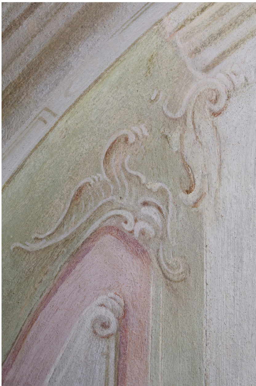
Obr. 88: Detail zobného prvku rá- mování polí vedle oken- ního otvoru na JV stěně kaple. Stav po restaurování.
