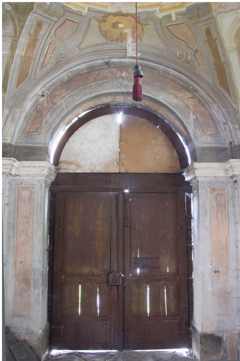
Obr. 09: Interiér kaple, JZ stěna. Stav před restaurováním.
