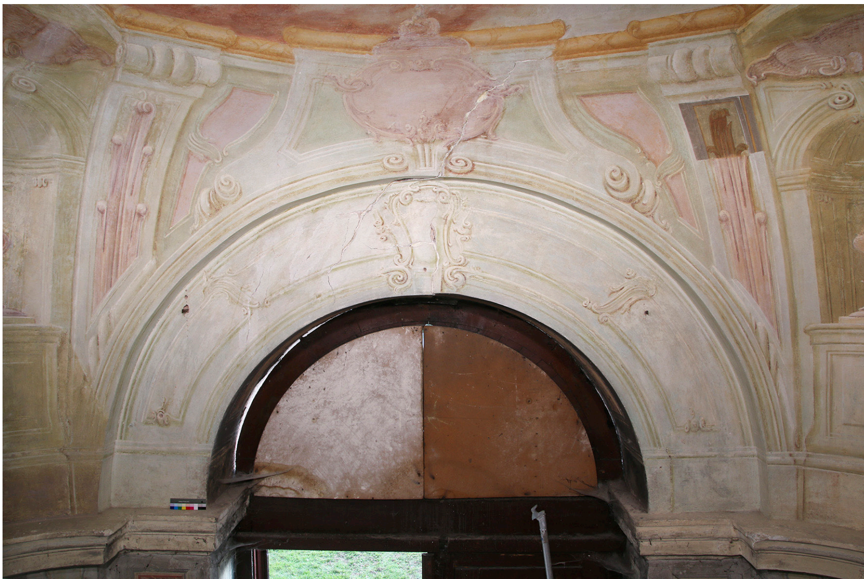
Obr. 74: Celkový pohled na JZ stěnu kaple. Stav po se- jmutí přemal- by a očištění, v průběhu tmelení.
