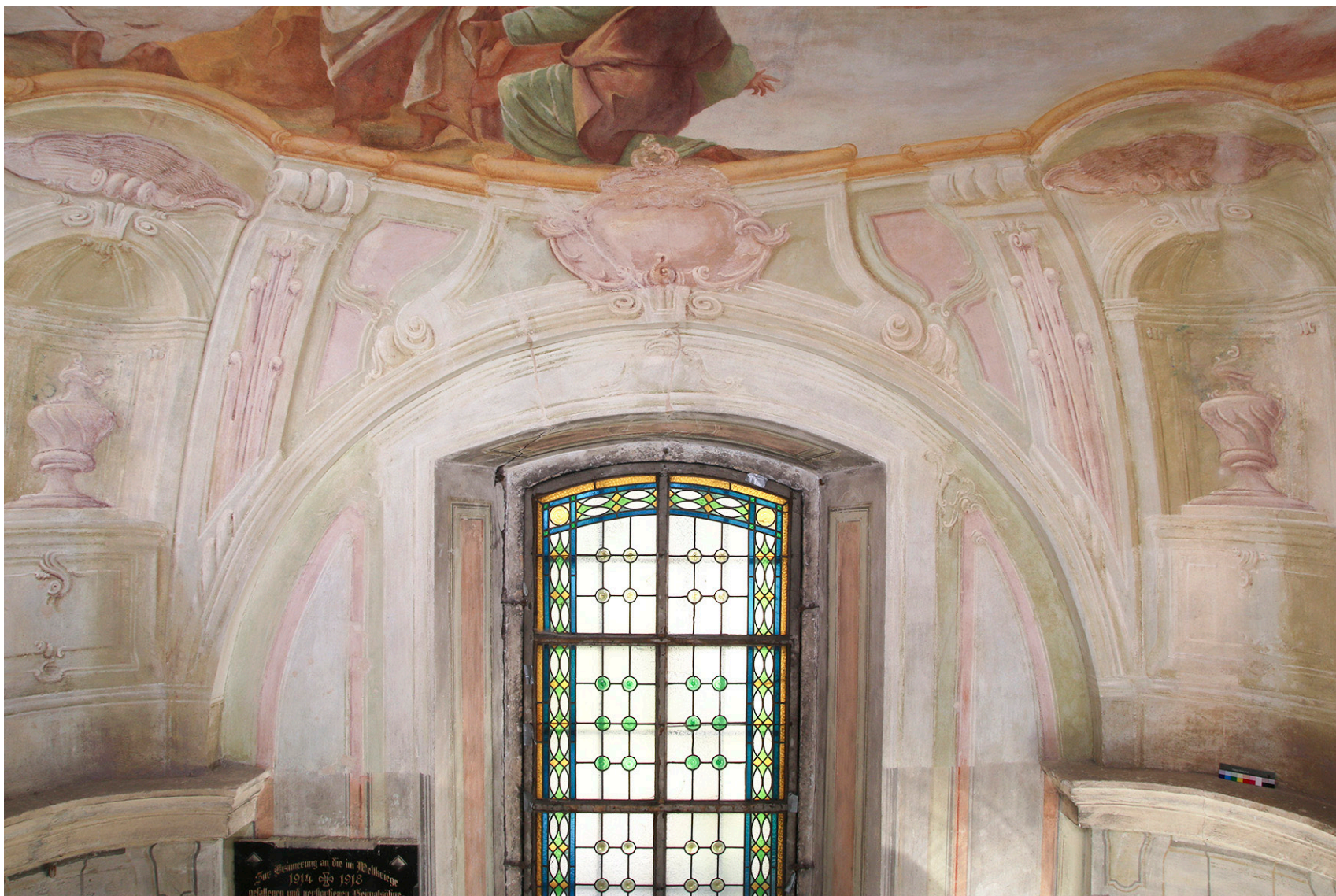
Obr. 72: Celkový pohled na JV stěnu kaple. Stav po se- jmutí přemal- by a očištění, v průběhu tmelení.
