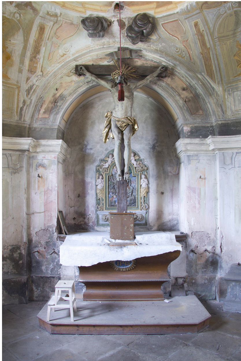
Obr. 05: Interiér kaple, SV oltární stě- na. Stav před restaurováním.
