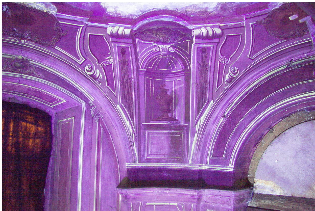
Obr. 19: Ztmavlá přemalba z 19. století. Pendentiv v jižním koutě kaple, část JV stěny a část oblouku nad vstupem do kaple. Stav před restaurováním.
