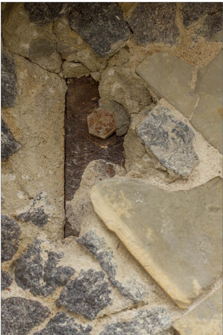
Obr. 12: Detail obnažené ocelové armatury v horní levé části mozaikového výjevu.
