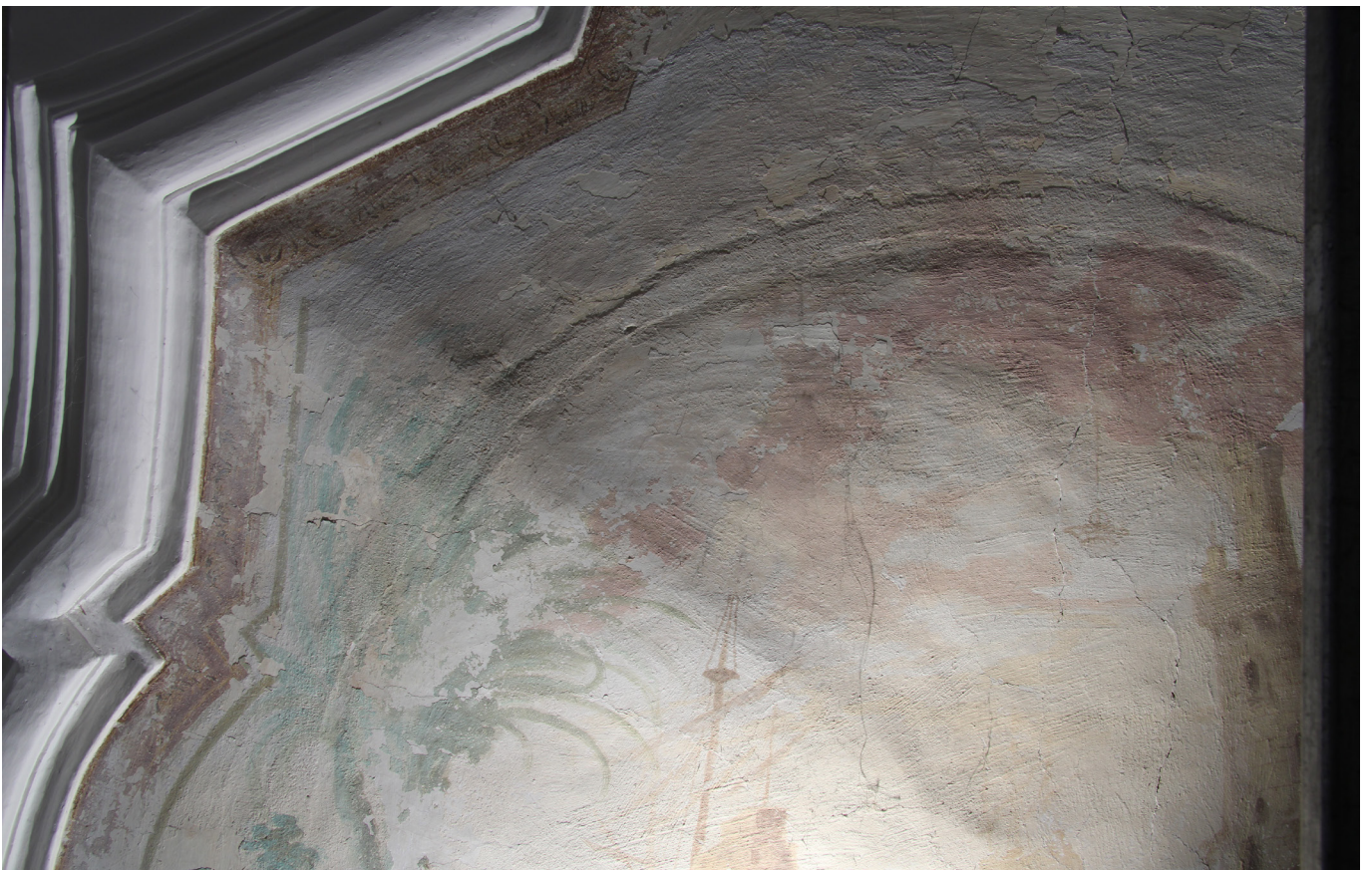
Obr. 23: Část nástropní malby. Fotografie v razantním bočním nasvícení. Na snímku je možné vidět tmel kruhového půdorysu, pravděpodobně po starším, později změněném, nedochovaném štukovém profilu.
