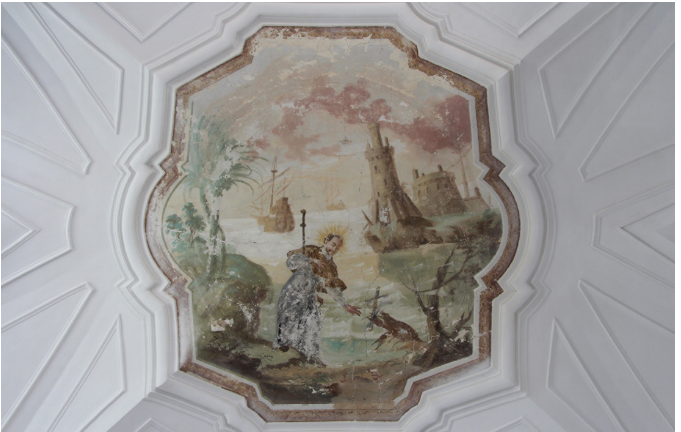
Obr. 22: Stav díla před restarurováním.
