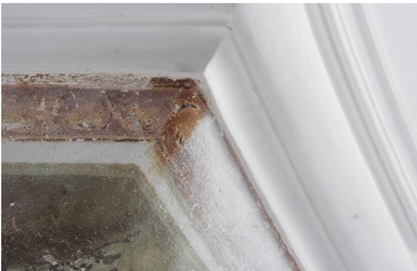
Obr. 14: Zkouška čištění bílého šlemu na stropní malbě v presbytáři.
