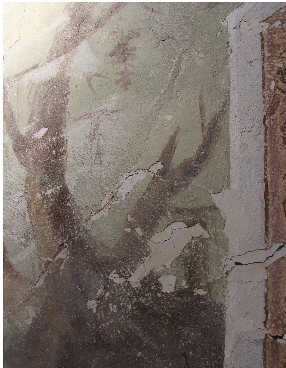
Obr. 27: Detail poškození v razantním bočním nasvícení. Světlo zvýraznilo defekty v barevné vrstvě a poškození prasklinami.
