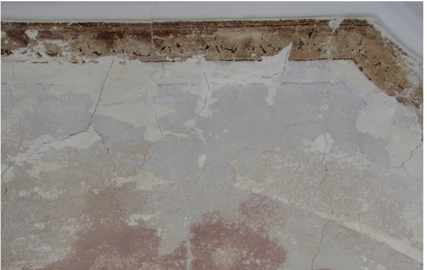
Obr. 53: Část malby oblohy a rámu před restaurováním.
