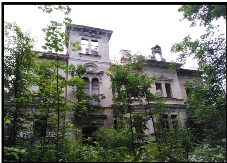
Obrázek č. 94 a 95 – Chodba prvního patra po požáru v roce 2018 a pohled už jen na zděnou kostru vily, stav z roku 2020 Autor: Michaela Koláčná
