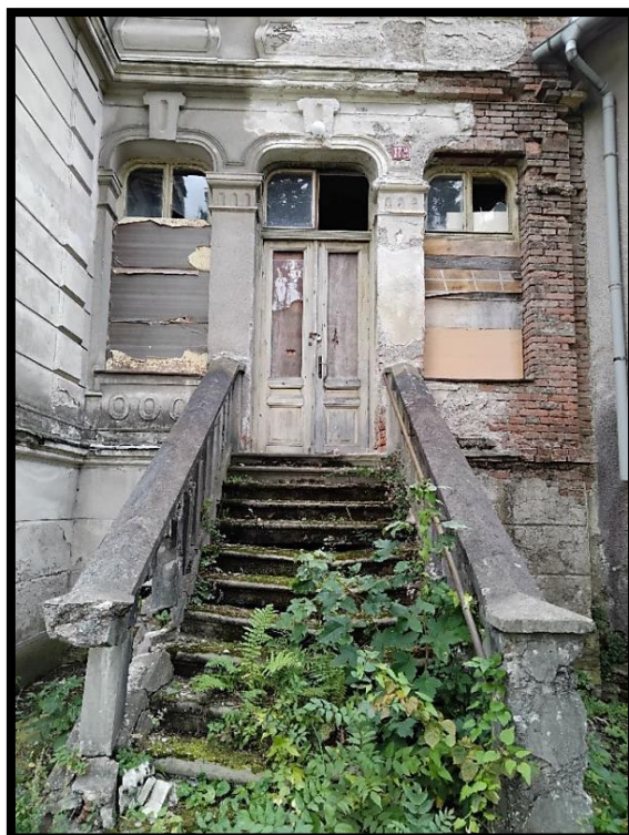
Obrázek č. 30 – Hlavní vstup s dnes již polorozpadlým schodištěm Autor: Michaela Koláčná
