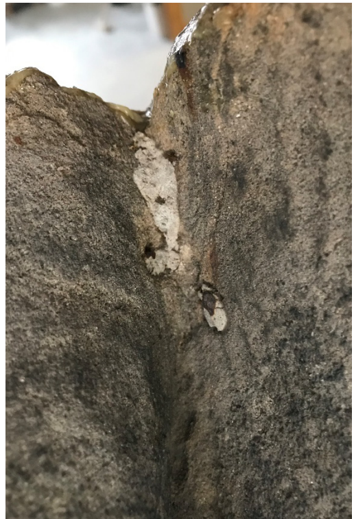
Obrázek 111 nalezené zbytky korodujícího kovu a tmel
