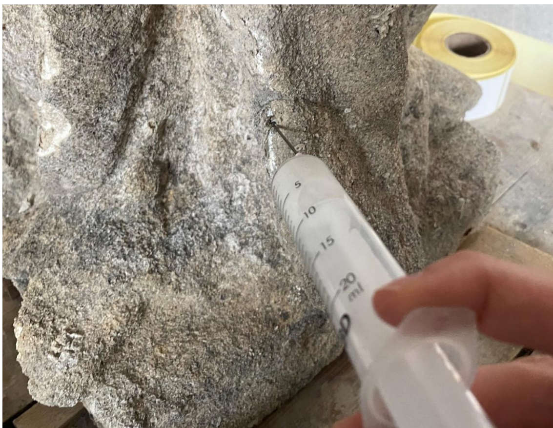
Obrázek 63 – Injektáž puchýřů injekční stříkačkou s použitím přípravku LEDAN TAI
