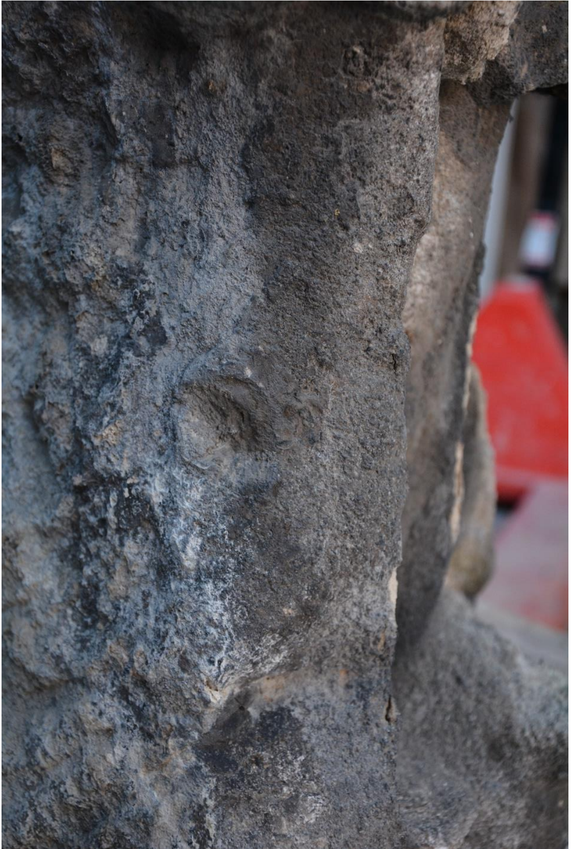
Obrázek 54 – Detail cementového šlemu na zadní části sochy s viditelným znečištěním černou barvou, sádrovcová krusta
