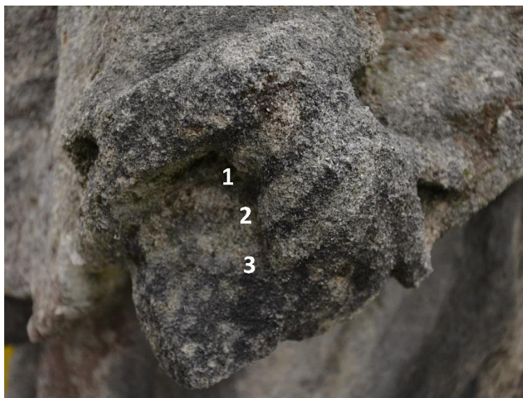
Obrázek 20 – Zkoušky čištění biologického napadení II.
