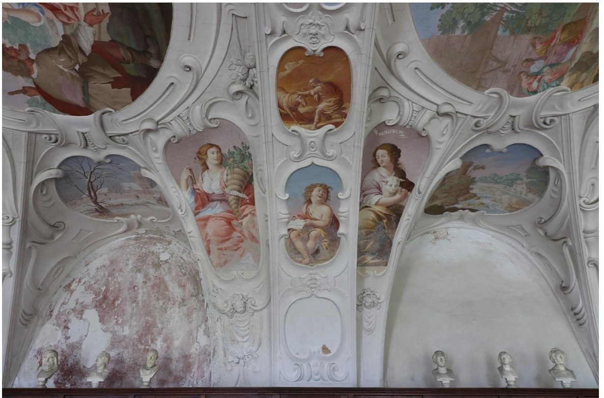
4. Východní část oblasti zasažené zatékáním.
