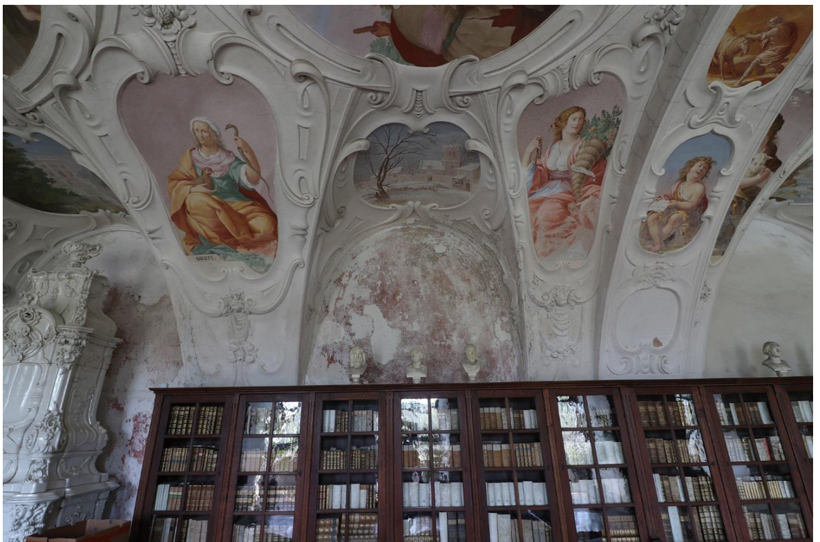
2. Pohled na část výzdoby severního náběhu klenby - oblast zasažená zatékáním.
