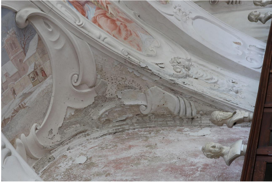
6. Pohled na klenební výseč v blízkosti výjevu Zimní krajina a Štědrost s poškozením štukové výzdoby vlivem zatekání.
