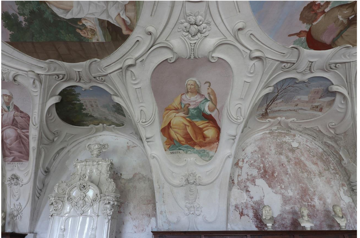
3. Západní část oblasti zasažené zatékáním.
