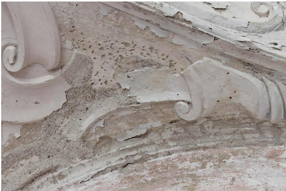
20. Detail štukové výzdoby v blízkosti výjevů Zimní krajina a Štědrost s poškozením štukové výzdoby vlivem zatékání.
