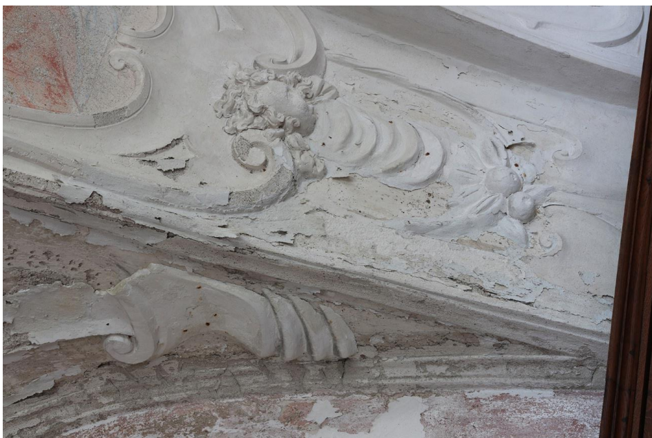
19. Detail štukové výzdoby v blízkosti výjevů Zimní krajina a Štědrost s poškozením štukové výzdoby vlivem zatékání.
