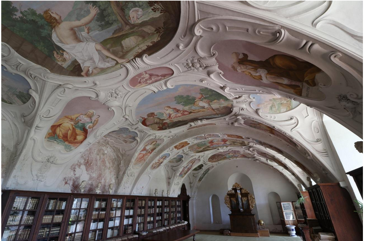
1. Pohled do východní části sály terreny od západu. V levé části pozorujeme oblast zasaženou zatékáním.
