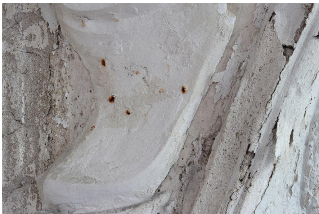
21. Detail starší opravy štukové výzdoby v blízkosti výjevů Zimní krajina a Štědrost – sádrová vysprávka je armována železnými výztužemi (snad hřebíky), které byly zasaženy korozi.
