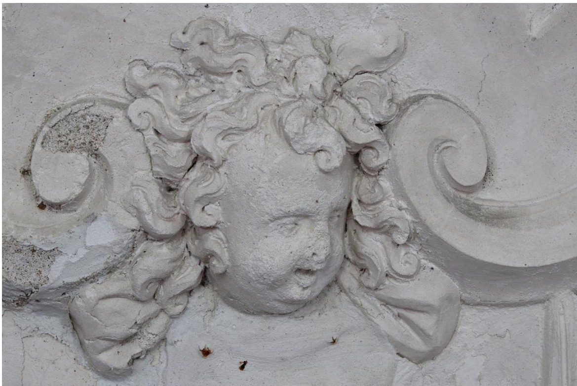
23. Degradace původní štukové výzdoby pod výjevem Štědrost.
