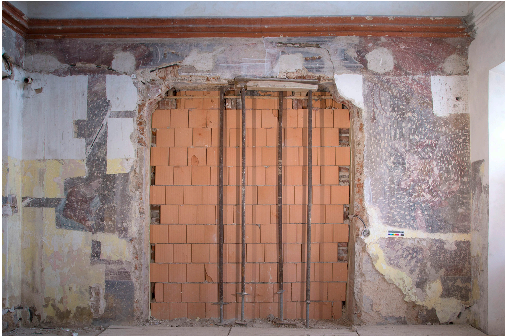
Obr. 57: Pohled na jižní stěnu s výjevem Zvěstování . Stav před restaurováním.
