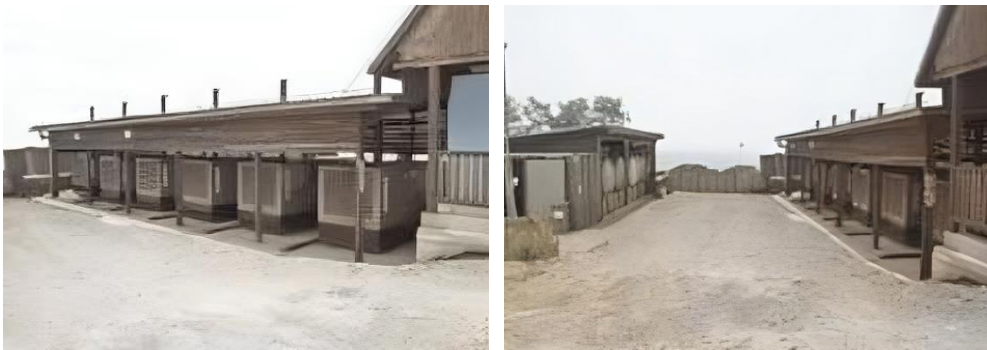
Obrázek 11 Energocentrum 6×250 kVA (Štoller a Zezulová, 2010)
