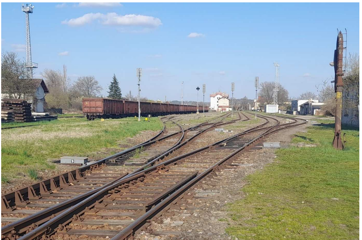
Fotografie 14 – výhybka č. 9 (vlevo), 10 (vpravo) a 11 (uprostřed), pohled na krahulovské zhlaví, rozvětvení sudých kolejí 6 – 18a
