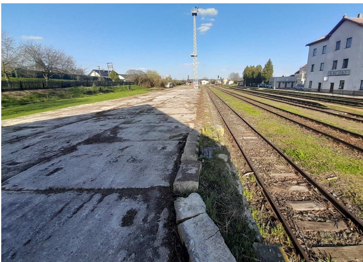
Fotografie 22 – poškozená hrana nákladní rampy u koleje 7
