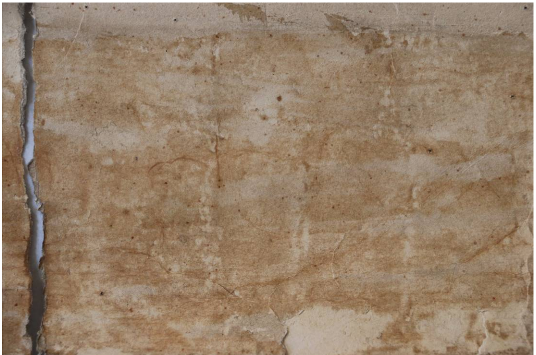
Obr. 25 Detail po sejmutí druhotných zásahů v podobě pásek
