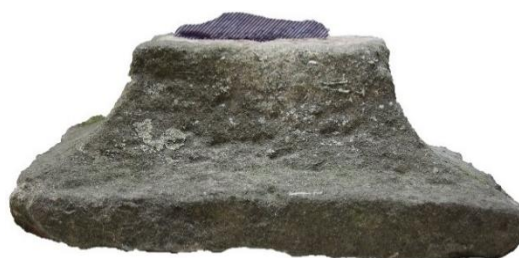
Obrázek 63 Levá strana hlavice, vyznačené poškození
