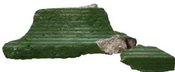
Obrázek 60 Zadní strana hlavice, vyznačené poškození
