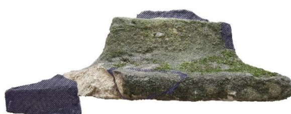
Obrázek 59 Pravá strana hlavice, vyznačené poškození
