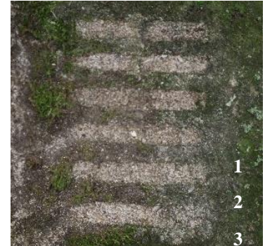
Obrázek 44 Zkouška čištění mechu a zelené řasy, hlavice
