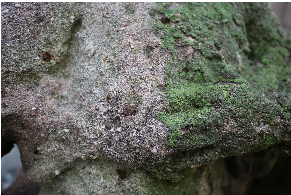
Obrázek 132 Detail čištění biologického napadení
