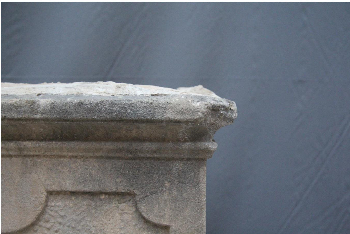
Obr. 69. Detail poškození v horní části římsy
