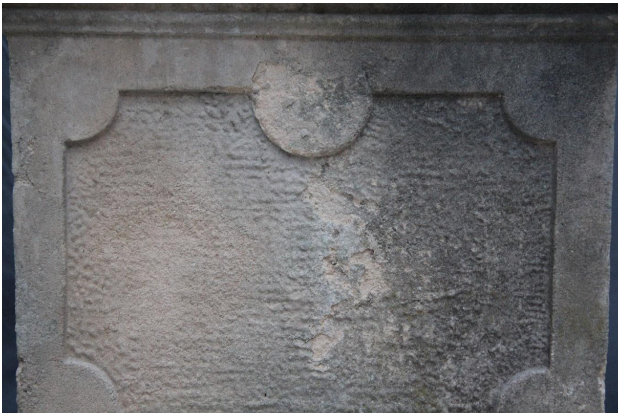
Obr. 71. Detail, degradace povrchu
