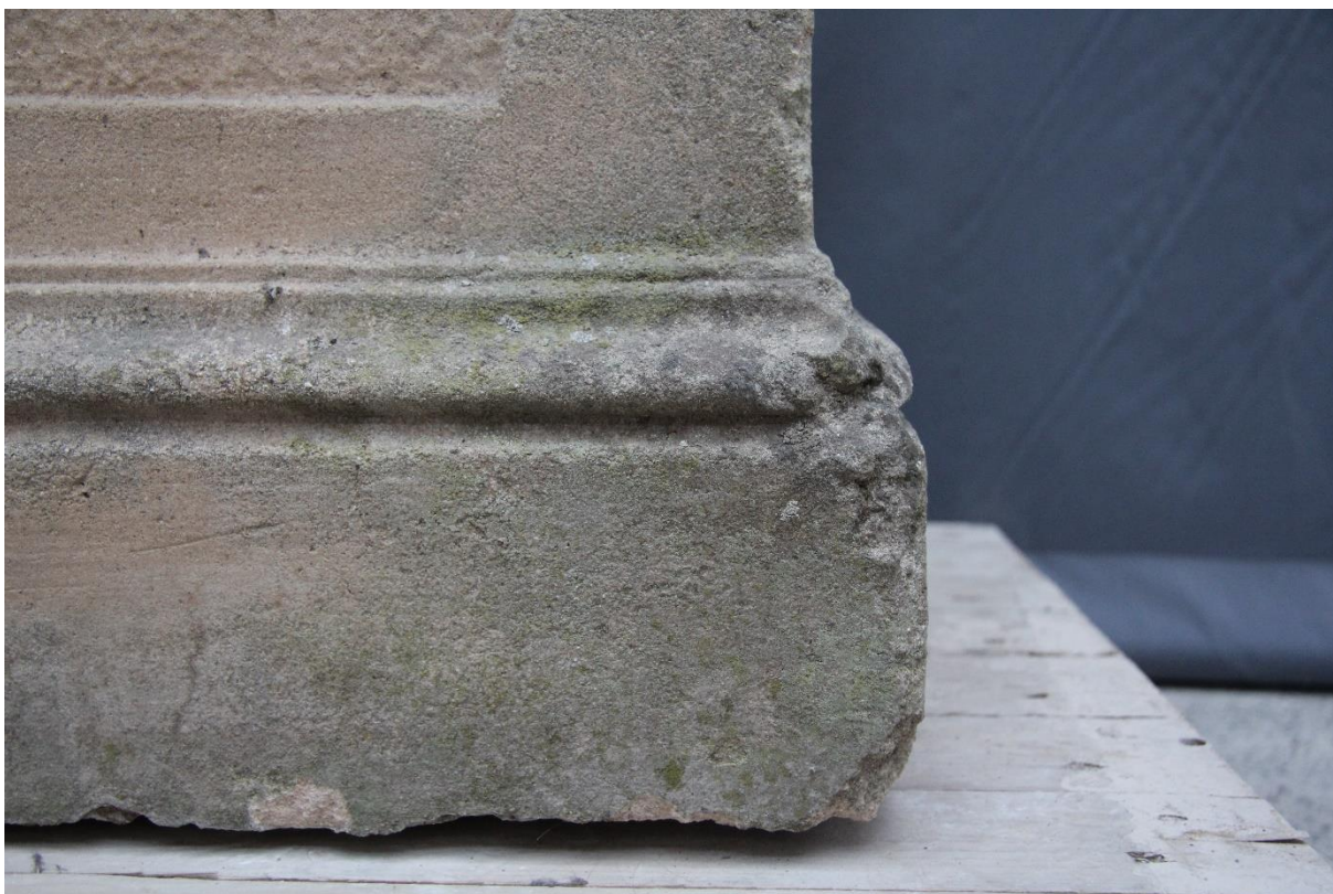
Obr. 70. Poškození spodní části profilace
