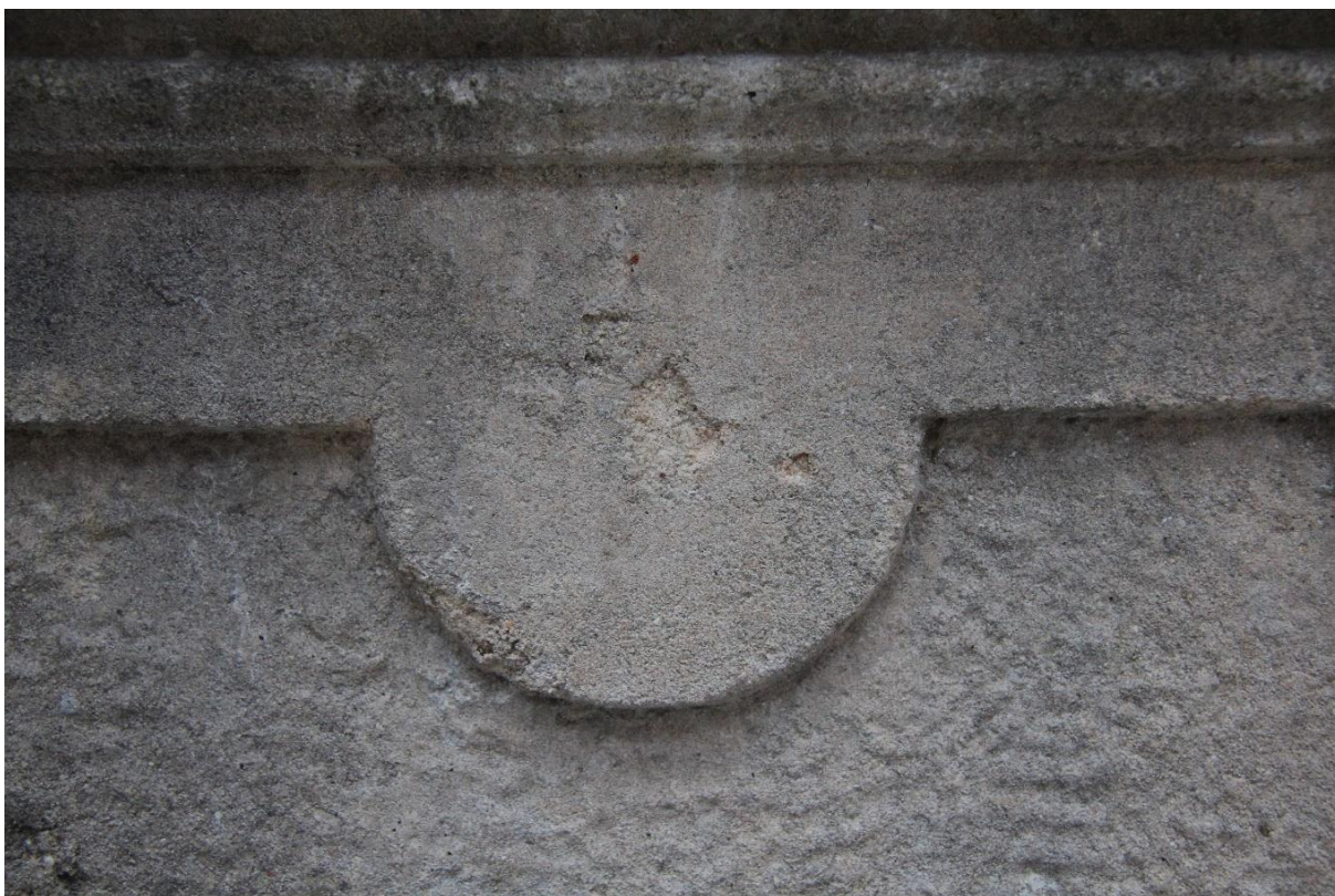
Obr. 72. Detail, degradace povrchu
