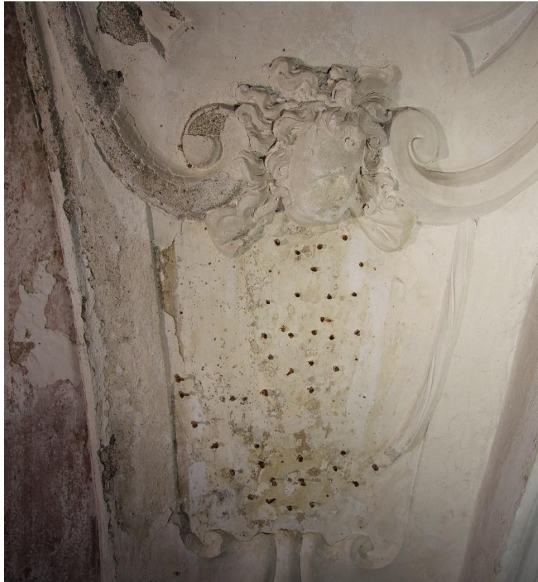
Obrázek 33 Klenební pas – po odstranění sádrových vysprávek
