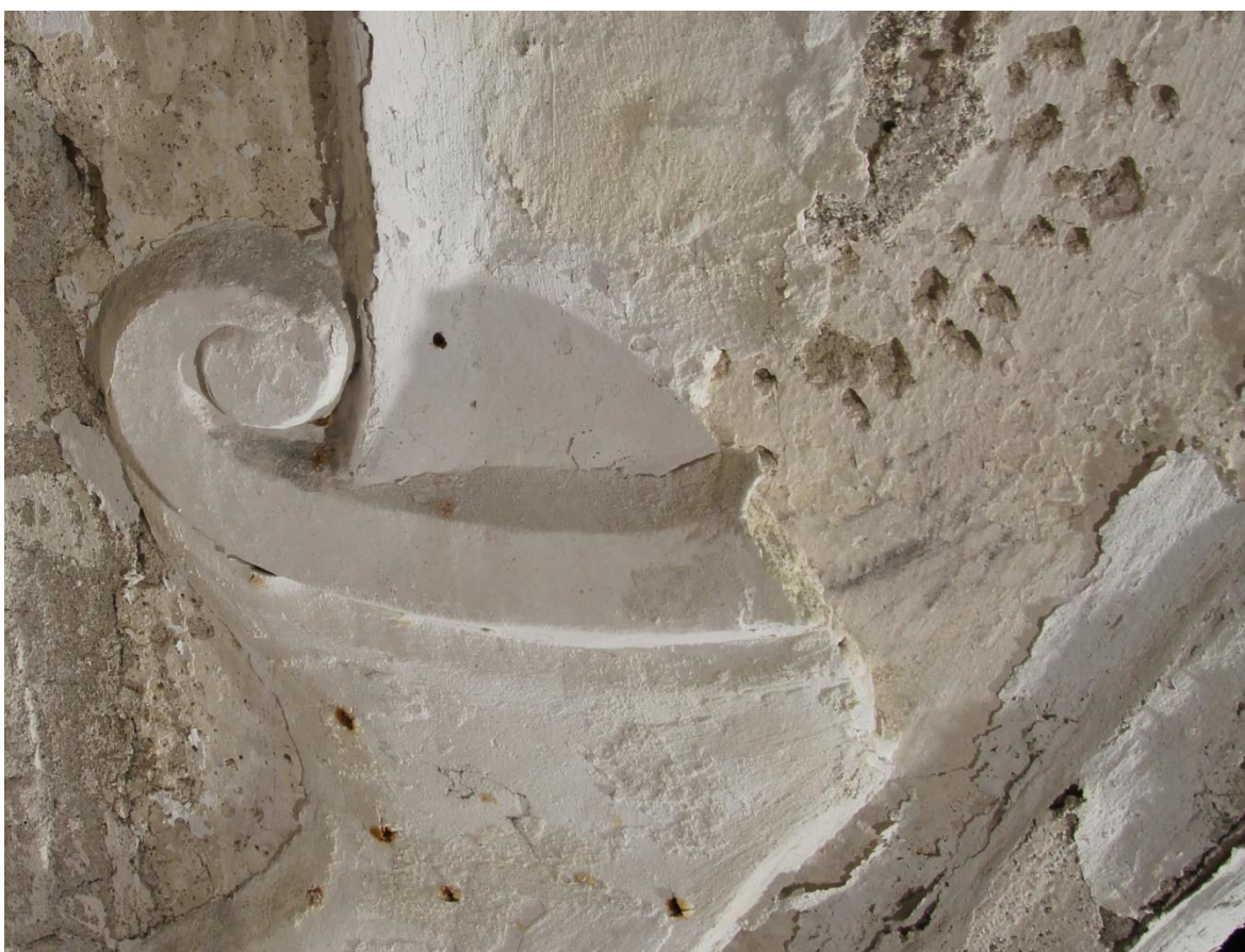
Obrázek 27 Detail sekundární sádrové vysprávky s podkresbou nacházející se na trojboké výseči
