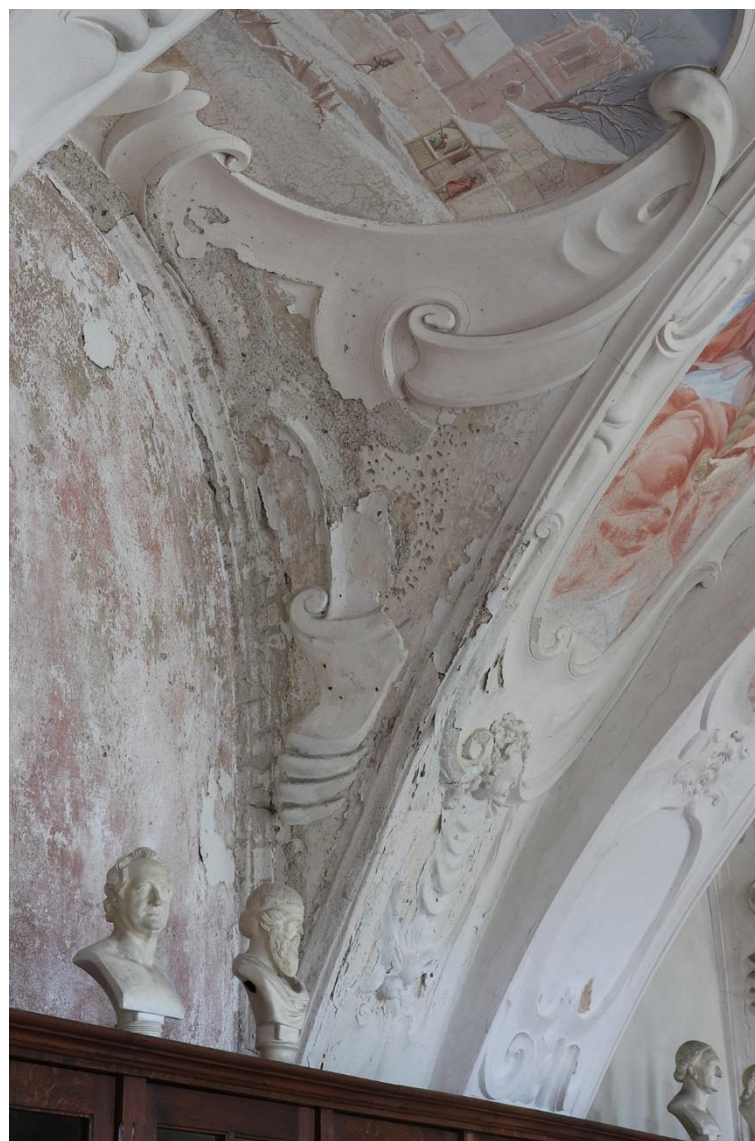
6. Pohled na klenební výseč v blízkosti výjevů Zimní krajina a Štědrost s poškozením štukové výzdoby vlivem zatékání.
