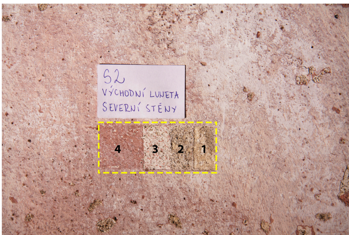
Obr. 38: Stratigrafická sonda (S1) provedená na lunetě pod výsečí s krajinou ve čtvrtém klenebním travě na severním čele klenby saly tereny, zobrazující původní omítkovou vrstvu s bílým nátěrem - 16. století anebo z 50. let 17. stol. (1), dále tenkou omítkovou vrstvou zřejmě -70. lety 17. století (2), a posléze iluzivní mramorování v růžové barvě, kterého původ souvisí s předchozí omítkovou vrstvou (3) - také zřejmě 70. lety 17. století.
