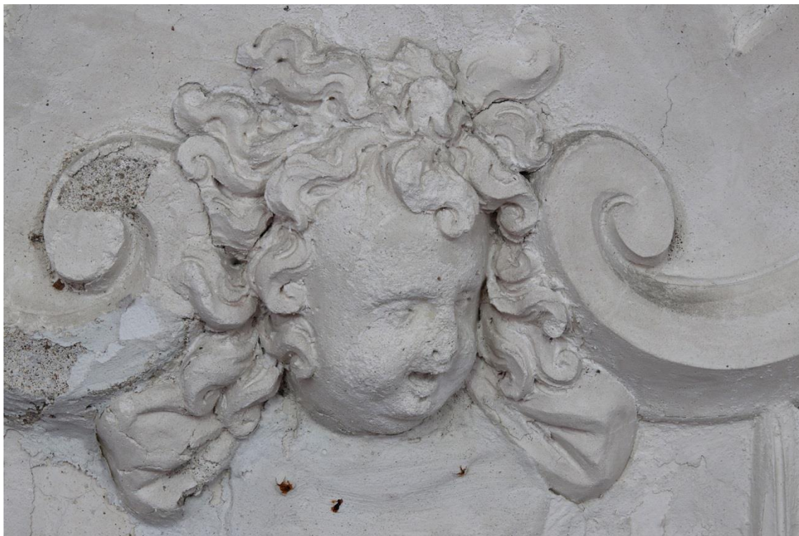
23. Degradace původní štukové výzdoby pod výjevem Štědrost .
