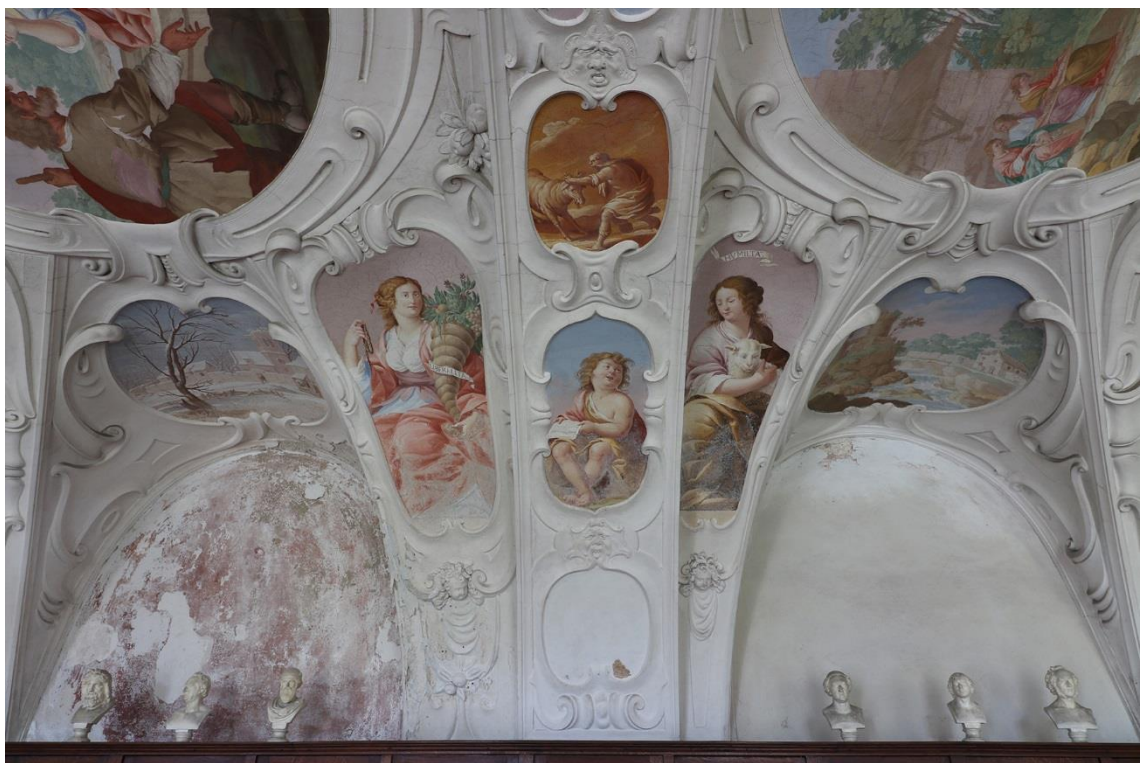
4. Východní část oblasti zasažené zatékáním.
