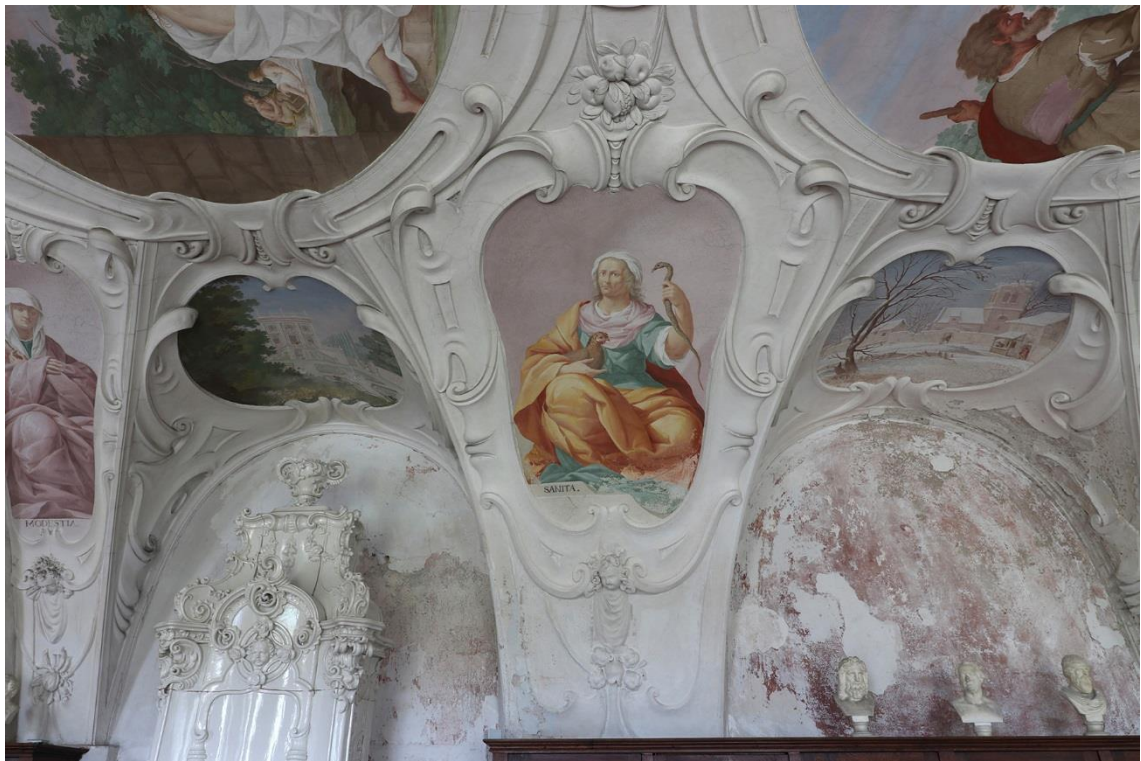
3. Západní část oblasti zasažené zatékáním.
