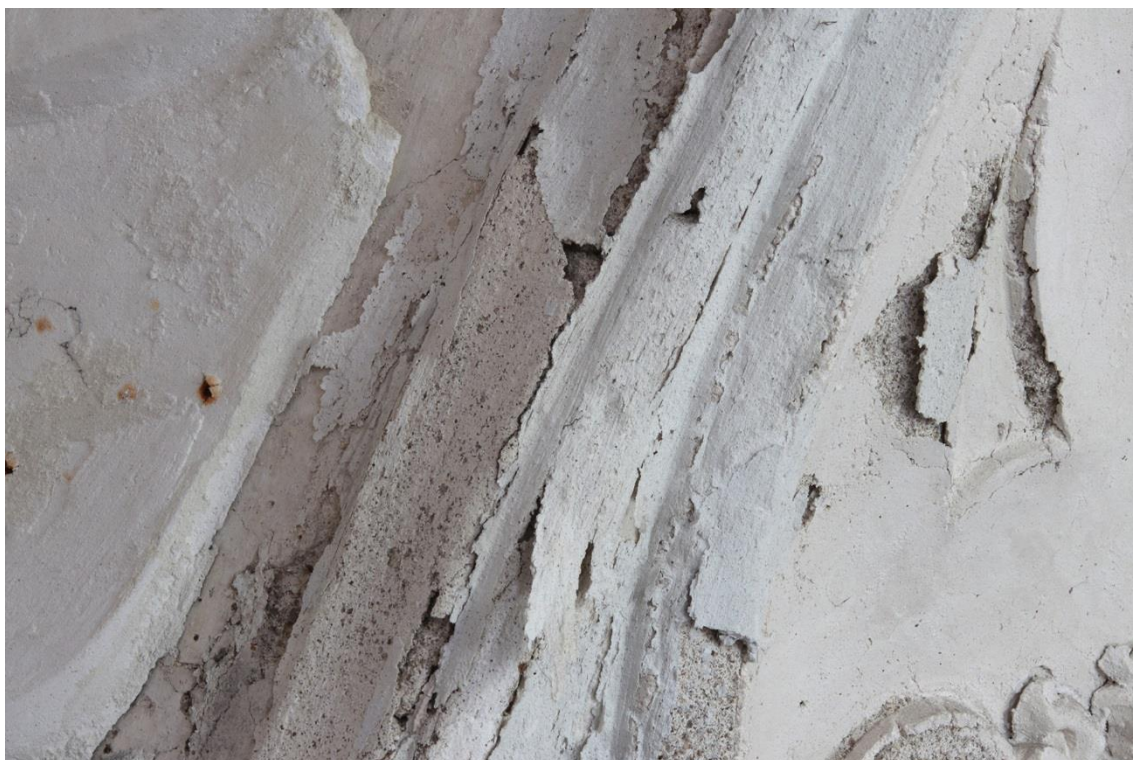
22. Degradace původní štukové výzdoby i následných vysprávek v blízkosti výjevů Zimní krajina a Štědrost .
