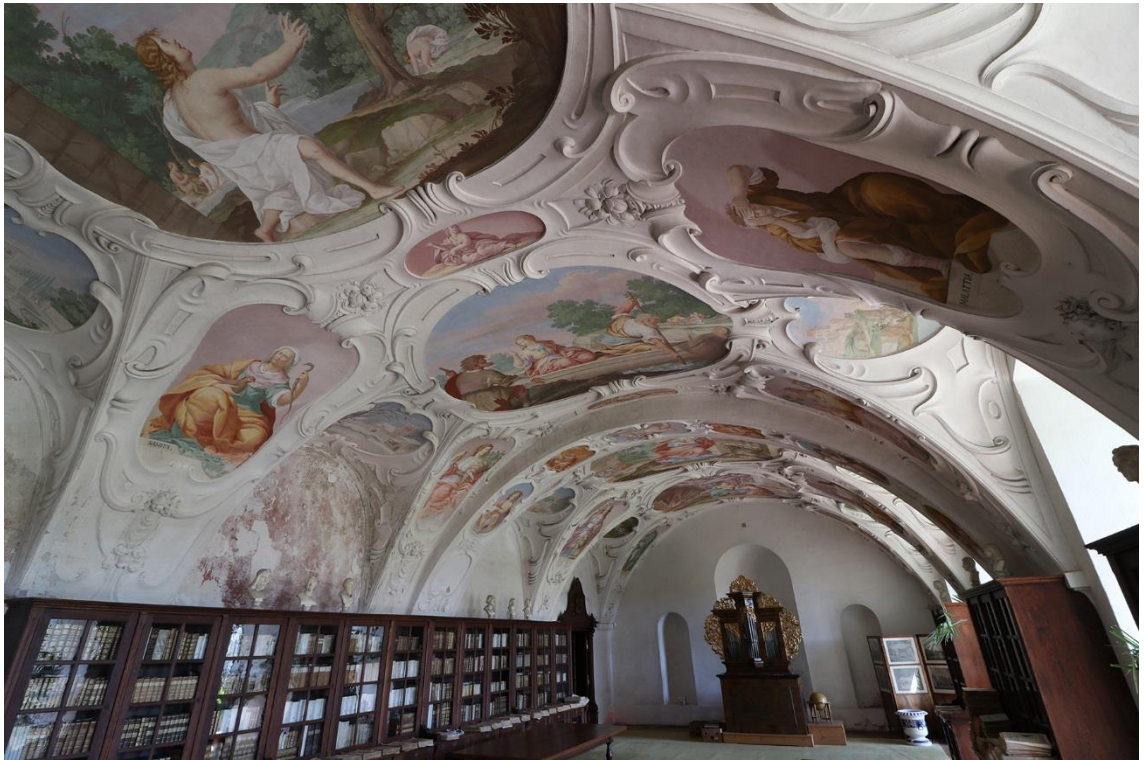
1. Pohled do východní části sály terreny od západu. V levé části pozorujeme oblast zasaženou zatékáním.
