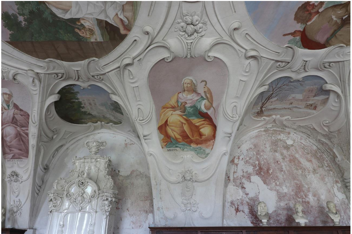
3. Západní část oblasti zasažené zatékáním.
