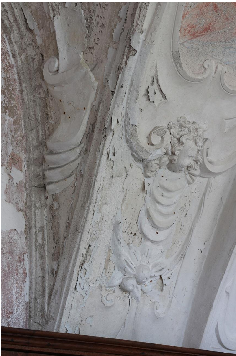
19. Detail štukové výzdoby v blízkosti výjevů Zimní krajina a Štědrost s poškozením štukové výzdoby vlivem zatékání.
