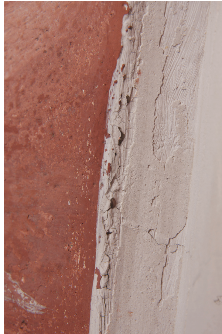
Obr. 25: Detail druhotného poškození, přesah druhotného štukového nátěru. Stav před restaurováním.
