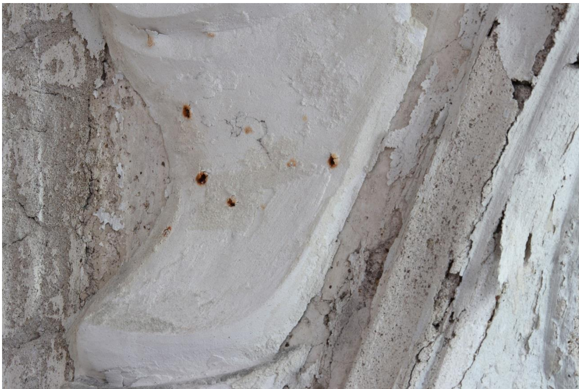
21. Detail starší opravy štukové výzdoby v blízkosti výjevů Zimní krajina a Štědrost – sádrová vysprávka je armována železnými výtuzemi (snad hřebíky), které byly zasaženy korozí.
