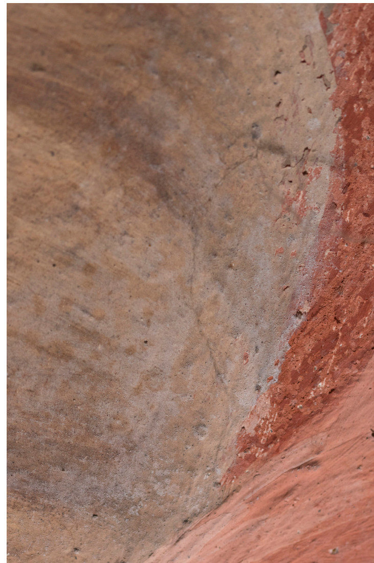
Obr. 23: Detail v ostrém bočním nastvícení. Plošný bílý povlak. Stav před restaurováním.
