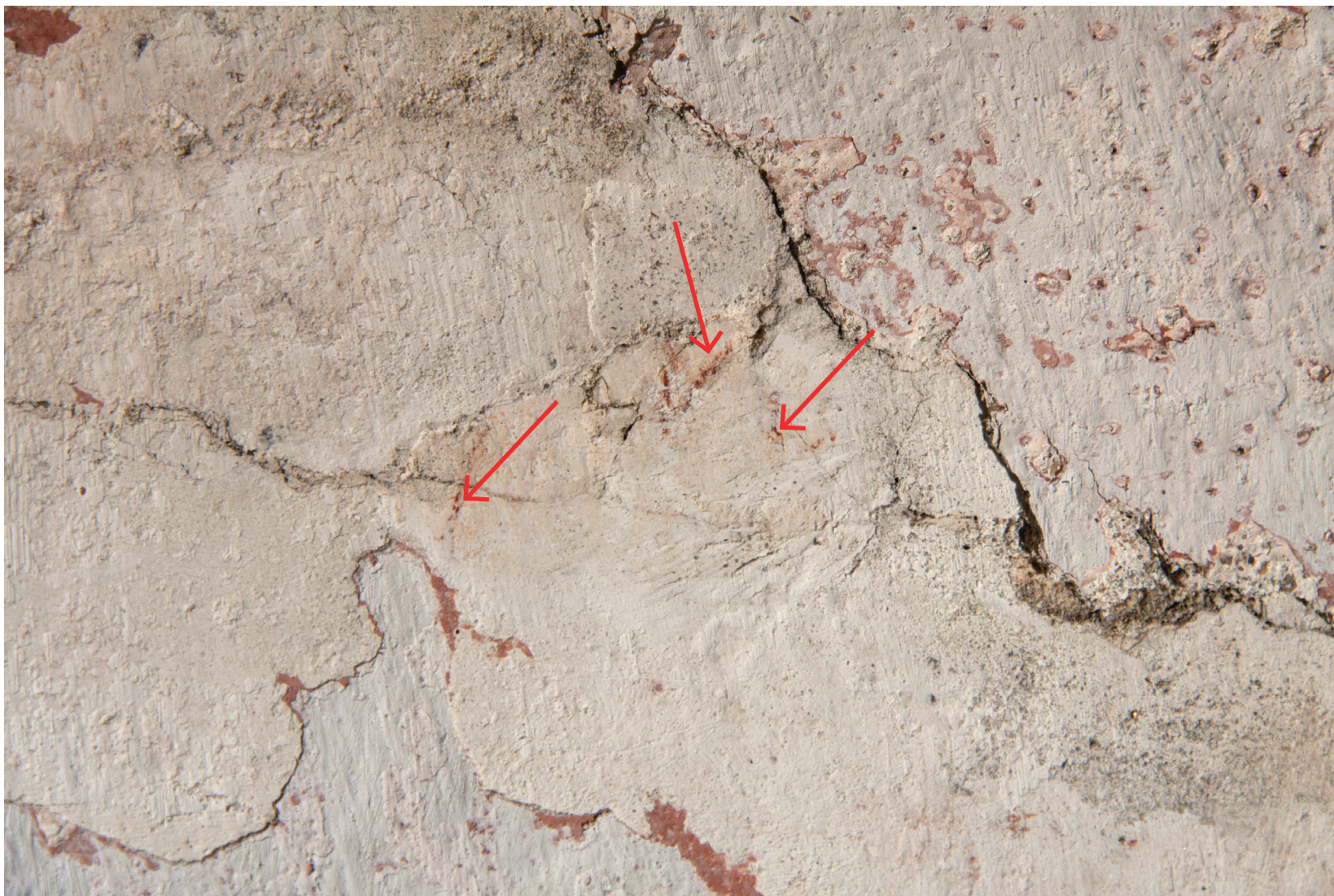
Obr. 35: Rozšířená sonda v okolí praskliny a narušené nátěrové vrstvy. Červené šipky poukazují na nalezené fragmenty nápísů.
