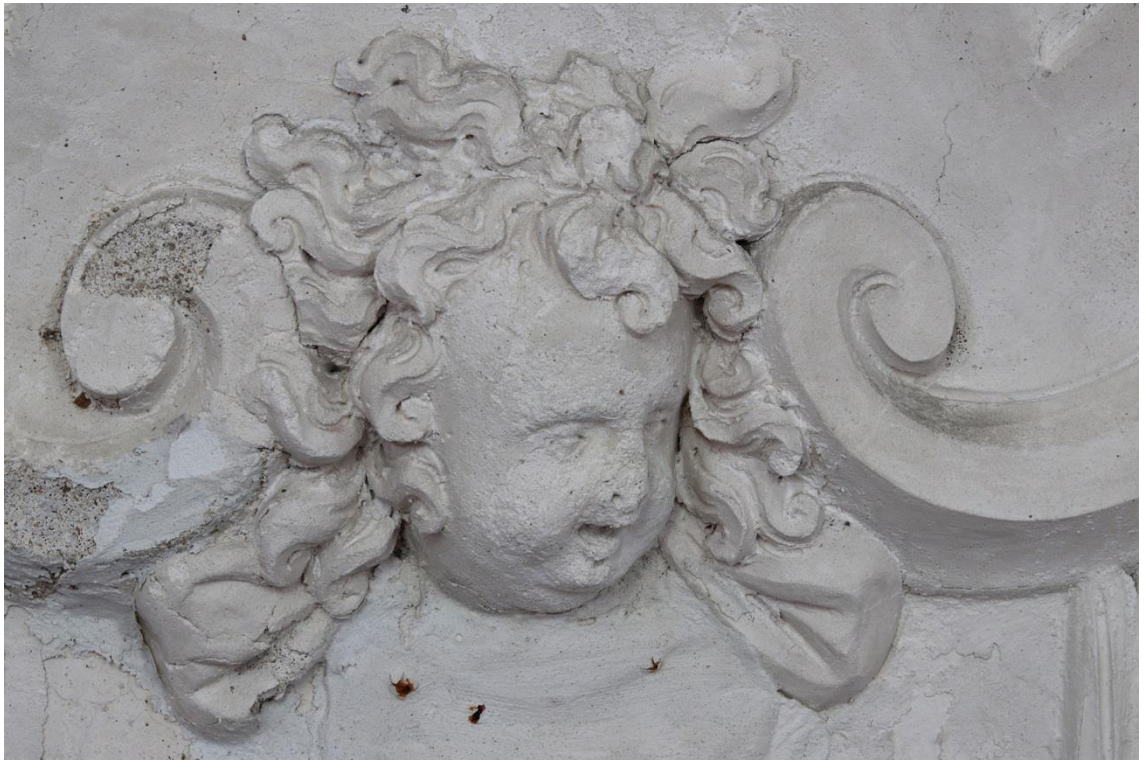
23. Degradace původní štukové výzdoby pod výjevem Štědrost.
