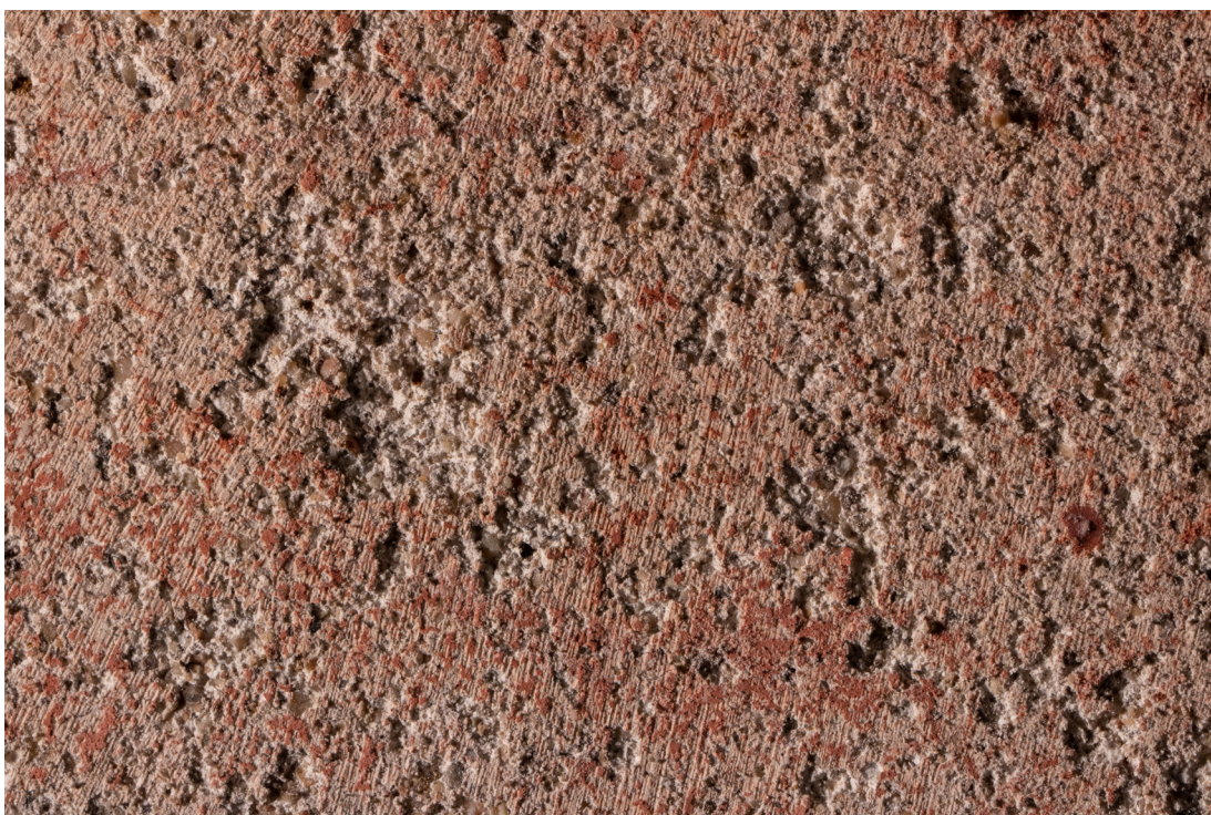
Obr. 12: Detail v ostrém bočním nastvícení. Zvýraznění rozvolnění a ztráty podkladové omítkové vrstvy. Stav před restaurováním.
