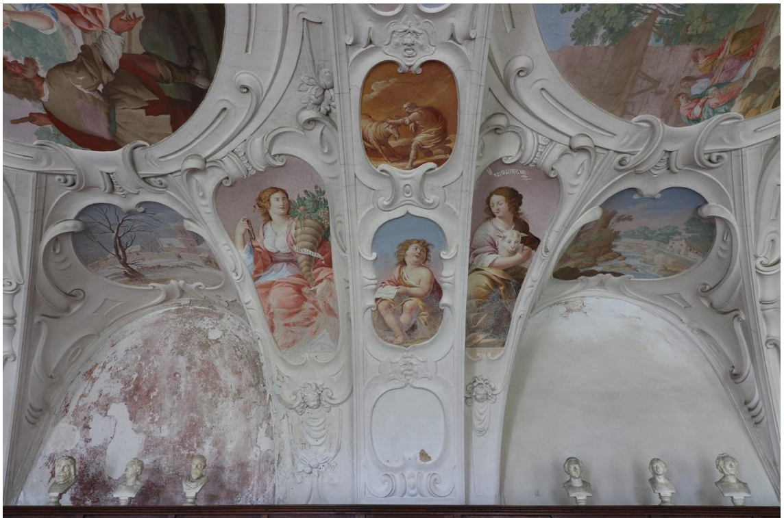
4. Východní část oblasti zasažené zatékáním.
