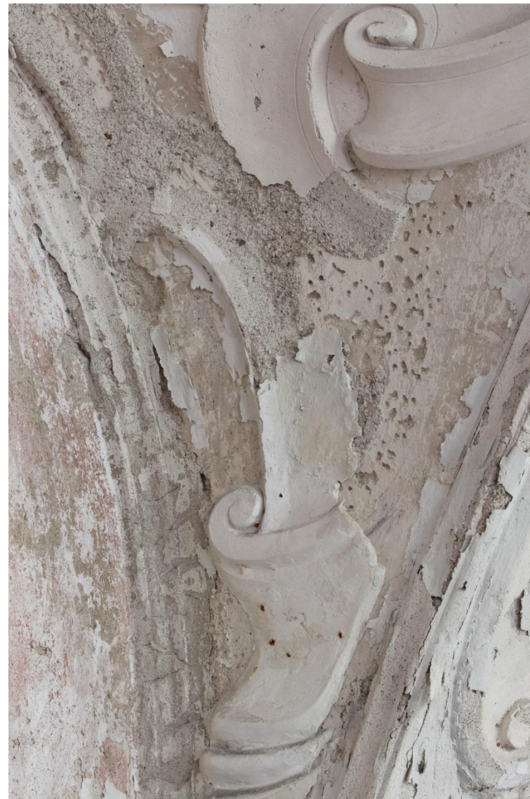
20. Detail štukové výzdoby v blízkosti výjevů Zimní krajina a Štědrost s poškozením štukové výzdoby vlivem zatékání.
