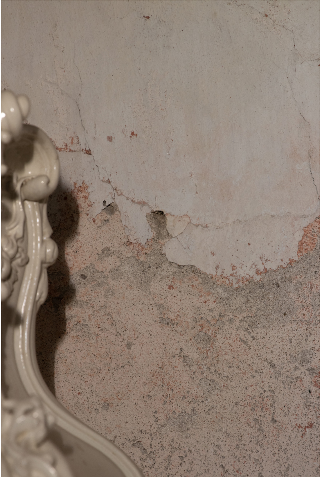
Obr. 26: Detail poškození lunety v pravé dolní části. Ztráta omítkové a nátěrové vrstvy s prasklinami. Stav před restaurováním.
