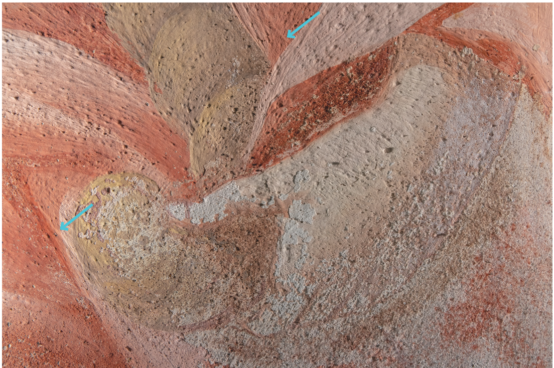
Obr. 21: Detail v ostrém bočním nastvícení. Zvýraznění povrchové textury omítky, barevných vrstev a poškození. Modré šipky ukazují na náznaky ryté kresby. Stav před restaurováním.
