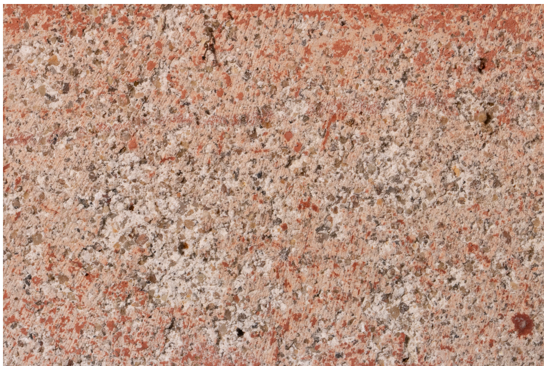
Obr. 11: Detail v rozptýleném denním světle. Složení omítkové/podkladové vrstvy v narušených částech. Stav před restaurováním.
