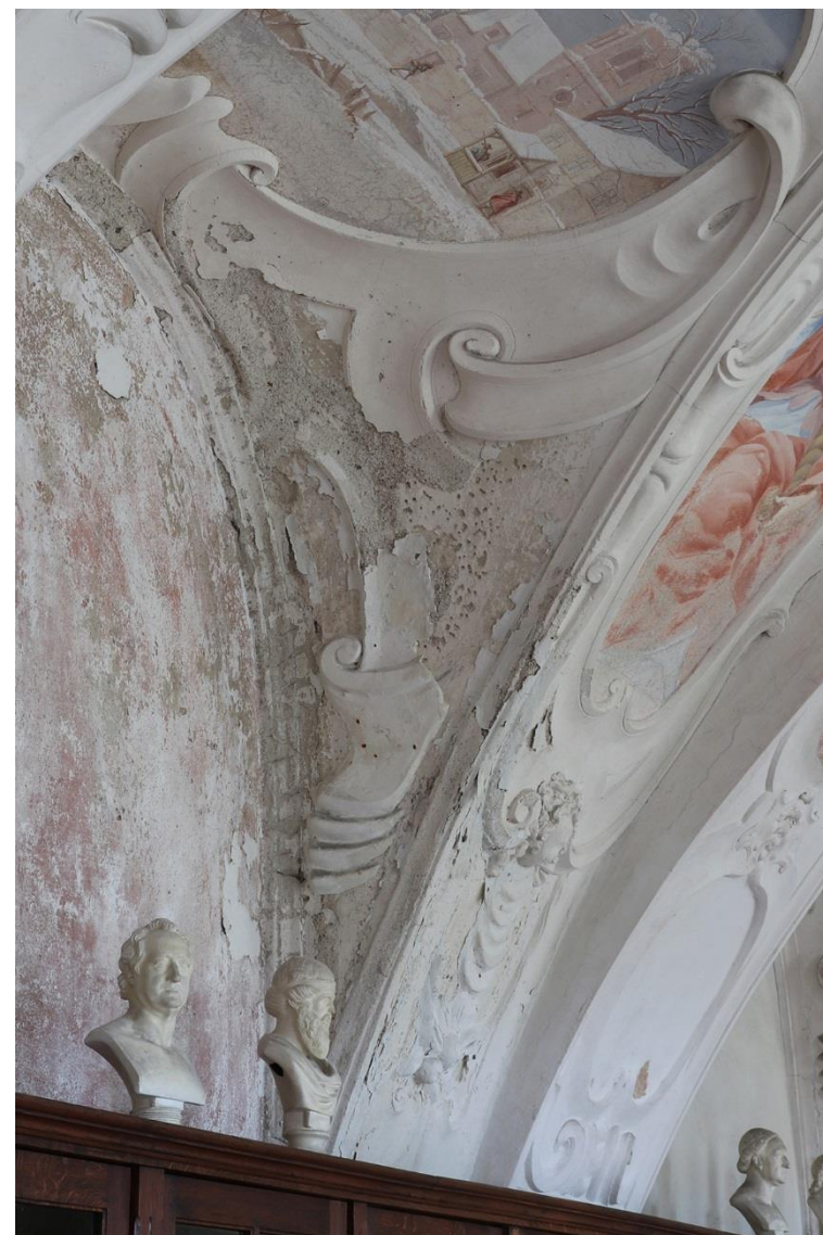
6. Pohled na klenební výseč v blízkosti výjevů Zimní krajina a Štědrost s poškozením štukové výzdoby vlivem zatékání.
