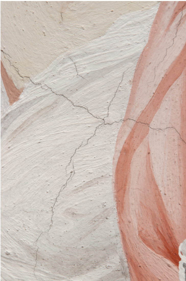
Obr. 24: Detail rozvětvené vlasové praskliny na hrudi figury. Stav před restaurováním.
