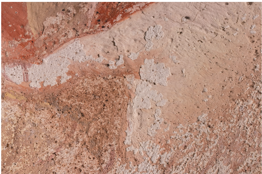
Obr. 16: Detail poškození v ostrém bočním nastvícení: zvýraznění přechodu mezi pastózní barevnou vrstvou a místem odpadnutých šupin. Dále můžeme pozorovat texturu zpráškovatělé barevné vrstvy. Stav před restaurováním.
