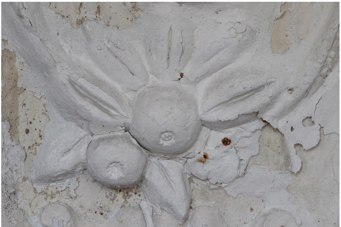
24. Druhotná sádrová vysprávka štukové výzdoby pod výjevem Štědrost.
