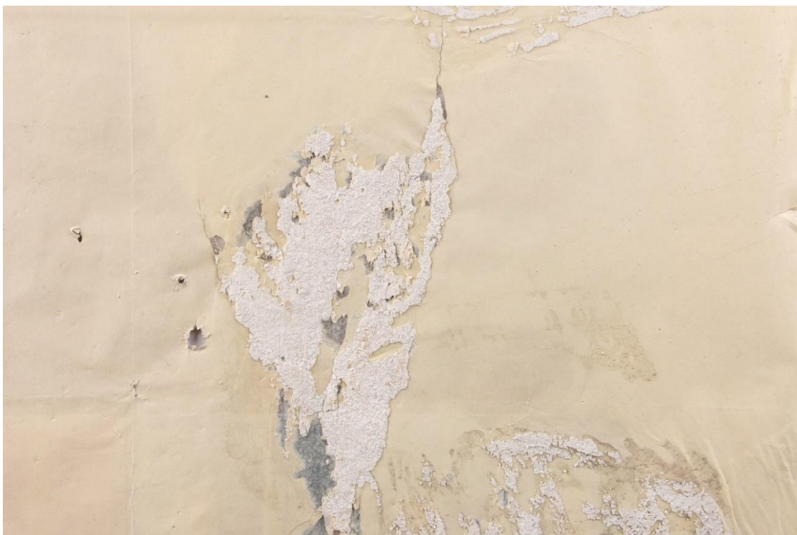
Fotografie č. 37 Detail poškození a omítky z rubové strany objektu před restaurováním
