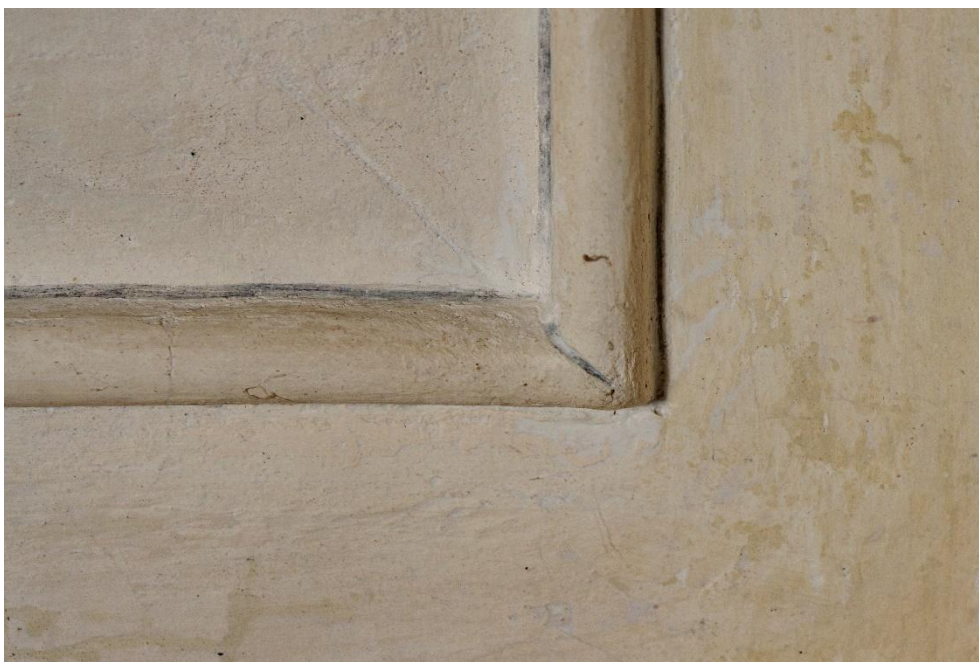
Obr. č. 85 Fotografie dokumentuje dva typy linek, a to incisione diretta v diagonálním směru uvnitř rámu a tmavou linku po vnitřním obvodu rámu, která má za cíl zvýrazňovat plasticitu rámu. Foto: Peter Majoroš. 2021
