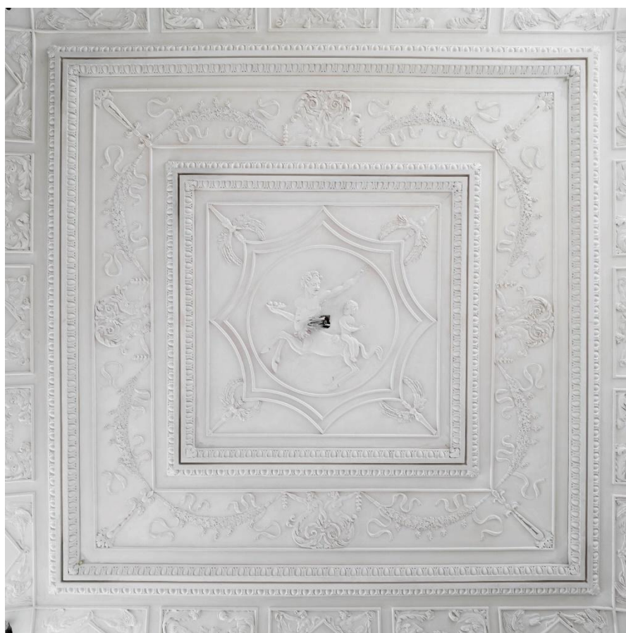
Obr. č. 237 Turmzimmer (rekonstrukce provedena na základě pražské předlohy) Residenzschloss Dresden. Foto: André Glauche
