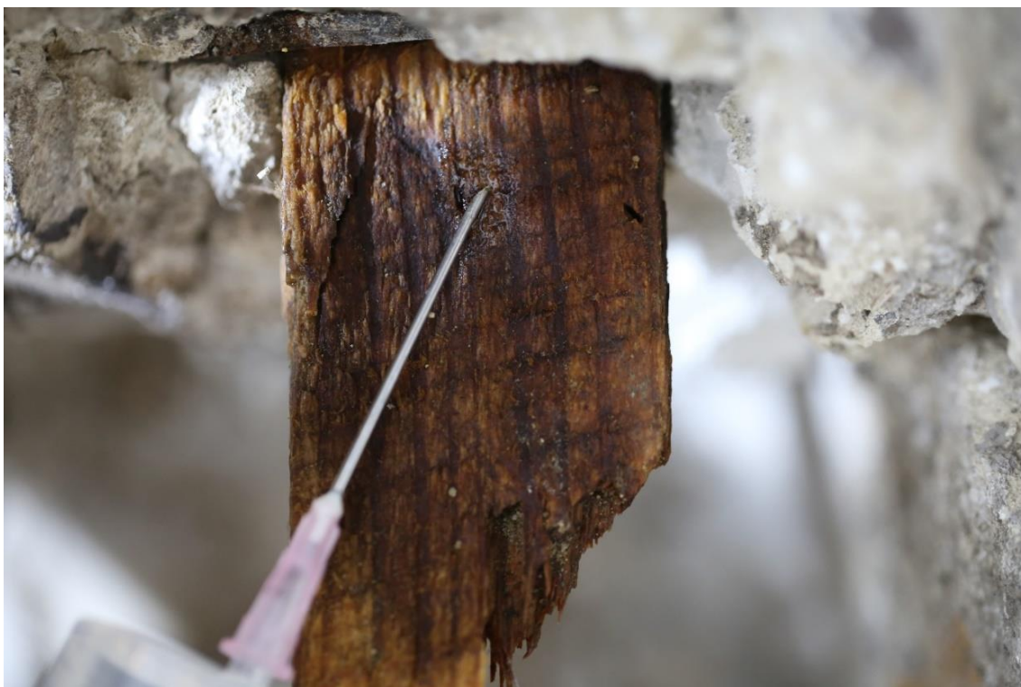
Obr. č. 178 Po demontáži hlavního kanonu z důvodu rozsáhlých trhlin byla podbalena vnitřní struktura – dřevěná armatura na kterou byla nanášena štuková hmota. Dřevěná část byla očištěna a petrifikována roztokem Paraloidu B72 o 15% koncentraci v Xylenu
