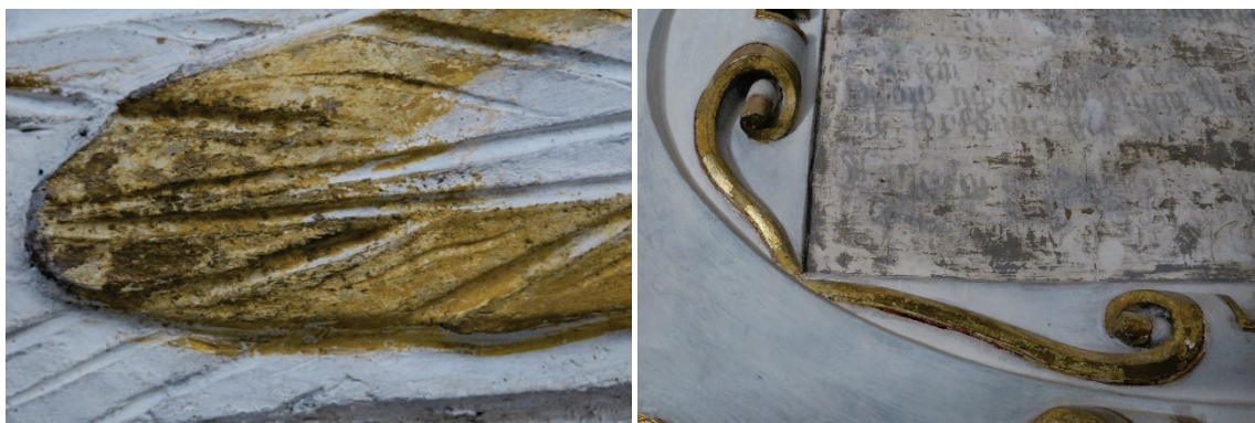
Obr. 61 – detail renesanční štukové dekorace s fragmenty původního zlacení. Zlacení bylo provedeno na širší okrově zbarvené malované pozadí
