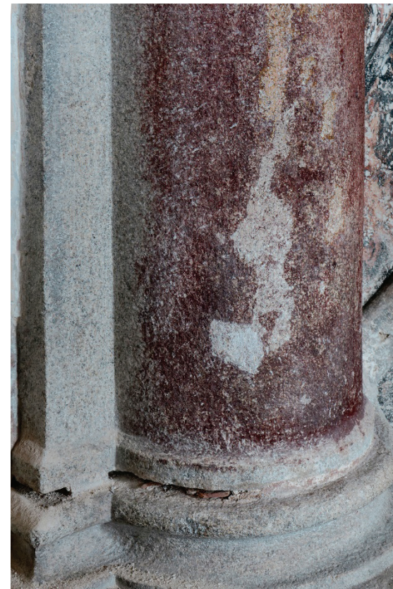
Obr. 18 – povrchová ztráta barevné vrstvy na žule
