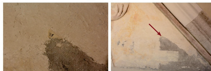
Obr. 4 a, b: Detail místa odběru vzorku V5 pro chemicko-technologický průzkum. Pozadí tympanonu, pravá strana, ztvrdlá vrstva druhotných nátěrů.
