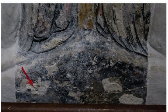
Obr. 11: Detail místa odběru vzorků V11 a V24 (S2). Pahorek, jádrová omítka s druhotnými nátěry (bez modelační vrstvy).
