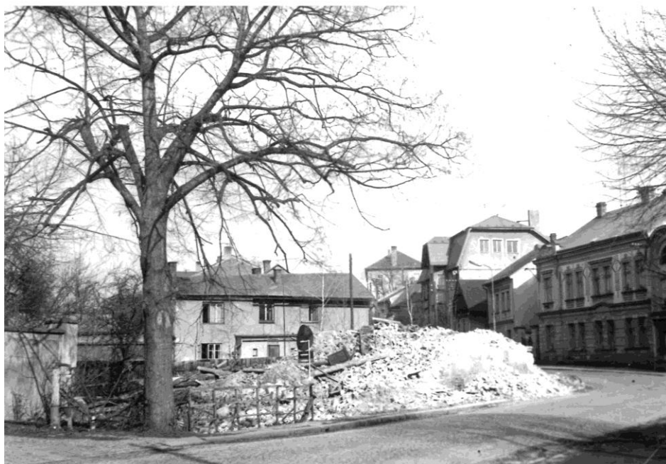
Obrázek 11 – Bourání domu barvíře a tiskaře Krištofa Hilbicha v dnešní Sladkovského ulici. Bez datace. Dnes se zde nachází parčík. 716
