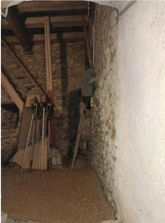
Nížkov, kostel sv. Mikuláše, pohled ze schodiště do patra věže, v rohu výklenek původního vstupu.
