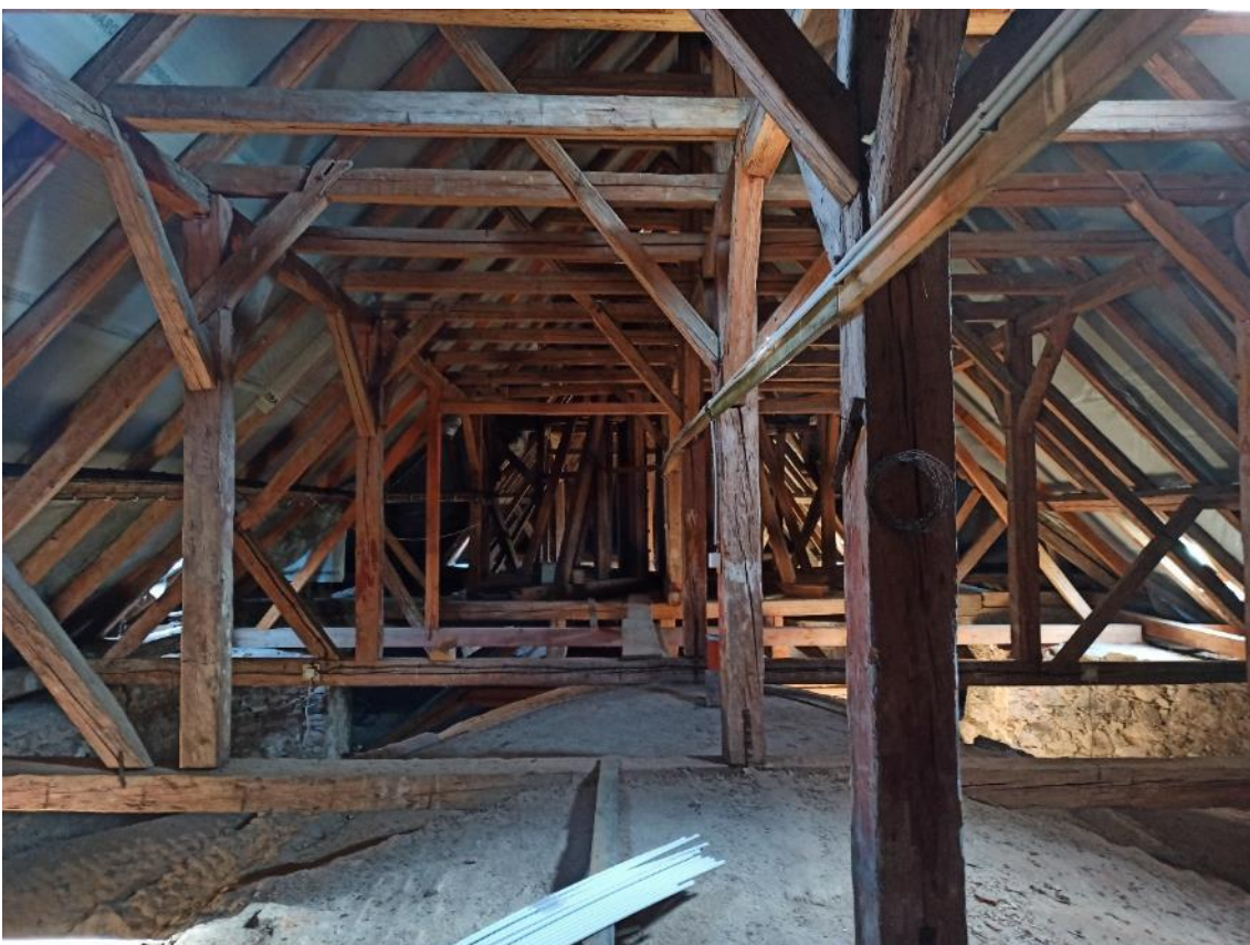
Přibyslav, kostel Narození sv. Jana Křtitele, hambalkový krov kostela se stojatou stolicí a středním sloupkem.
