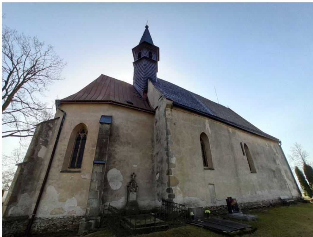
Polná, kostel sv. Kateřiny, pohled ze severu, stav střechy z února 2021.
