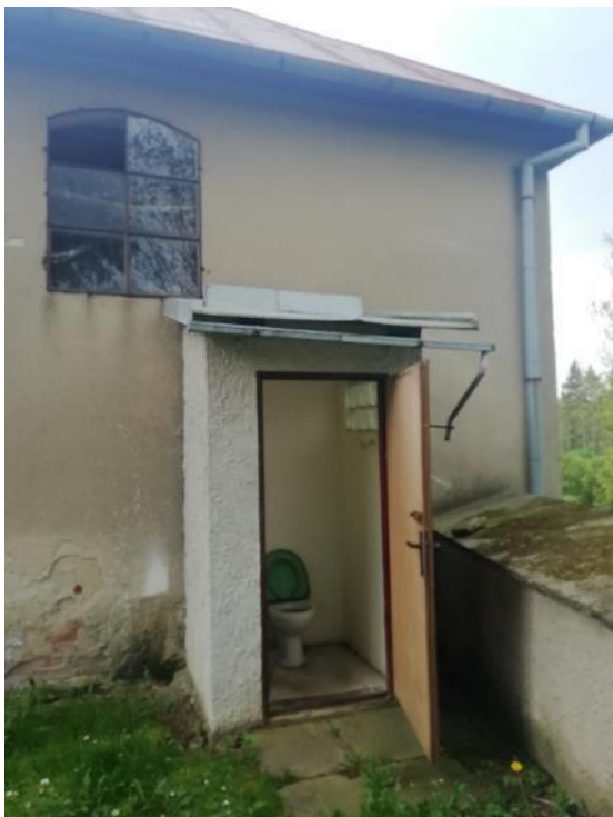
Nížkov, kostel sv. Mikuláše, nevhodný přístavek s WC u severní stěny kostnice.
