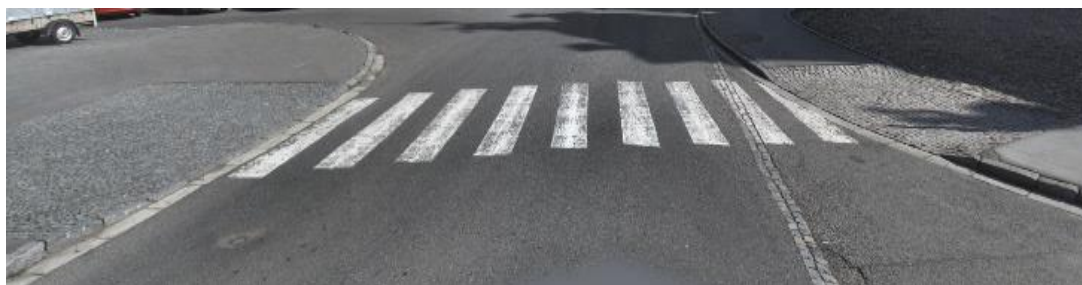
Obrázek 13: Přejchod pro chodce – silnice III/3424 u kostela
