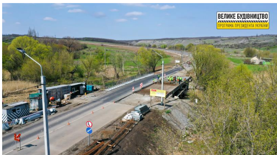
Obrázek 3 Oprava mostu silnice H-32 Pokrovsk – Bakhmut – Michajlovka (Foto z oficiálních webových stránek projektu «Velké stavění»)
