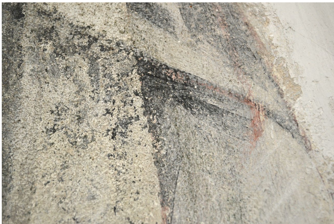
Obr. 84: Detail malby, kde je patrné poškození v podobě šupinatění a úplné ztráty barevné vrstvy.
