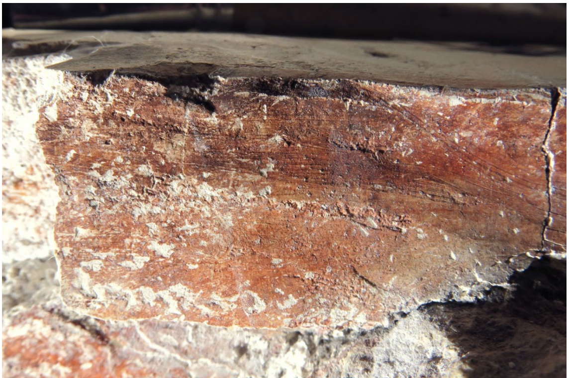
Obr. 135: Detail poškození štukového podstavce. Stav po očištění.
