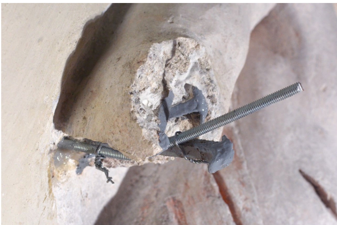
Obr. 145: Povrchová úprava odhalených zkorodovaných armatur a instalace nové armatury pro uchycení odděleného předloktí Krista.
