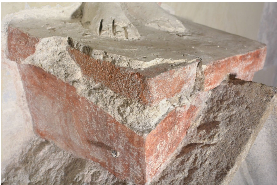
Obr. 132: Štukový podstavec pod postavou Vítězného Krista po očištění. Na snímku je patrné poškození v podobě ztráty modelačního a jádrového šuku, jež odhaluje cihlovou vyzdívkou podstavce.
