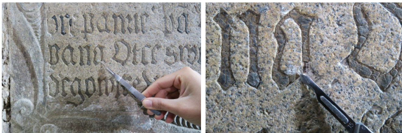
Obr. 23 a, b: Detail místa odběru vzorku V23 pro chemicko-technologický průzkum. Levá část nápisové desky, výplň písma.
