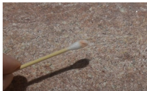
Obr. 9: Zkoušky míry práškovatění pomocí vatové tyčky.
