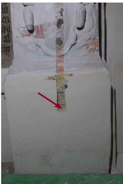
Obr. 7: Detail místa odběru vzorku V7. Zděný sokl pod erbem Rosiny z Vartenberka, opravná malta na cihlovém zdivu.
