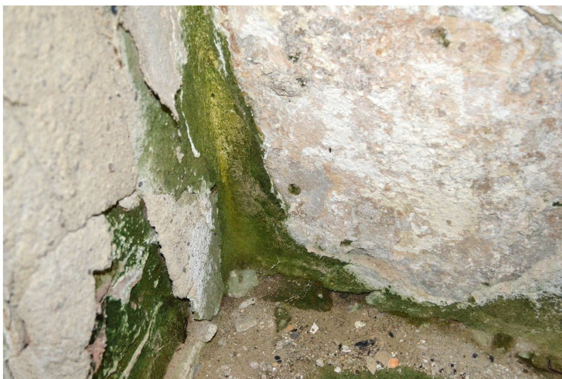
Obr. 85: Soklová část epitafu s okolní nástěnnou malbou, která se vlivem degradace omítek nedochovala. Na fotografii je též patrné masivní poškození v podobě biologického napadení způsobeného vlivem vzlínající vlhkosti.
