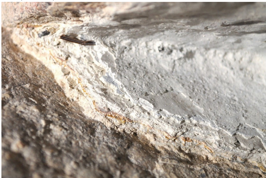
Obr. 106: Souvrství druhotných vrstev na žulových prvcích v průběhu odkryvu.
