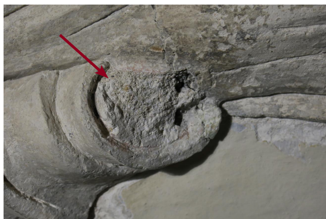
Obr. 10: Detail místa odběru vzorku V10. Pravá ruka anděla vlevo, v místě defektu, souvrství modelační a jádrové vrstvy štuků.
