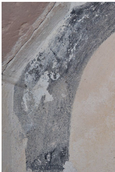
Obr. 40: Detail malovaného rámu. Poškození v podobě ztráty barevné vrstvy.
