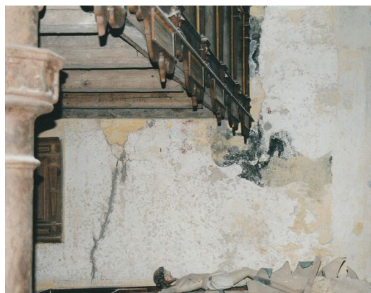
Obr. 65: Malovaný rám v levé části severní stěny, kde byl poškozen během renovace kůru v polovině 19. století.
