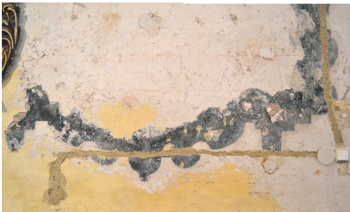
Obr. 70: Detail malovaného rámu poškozeného druhotnými zásahy, konkrétně v tomto případě rozvodem elektřiny a dalšími drobnými defekty.
