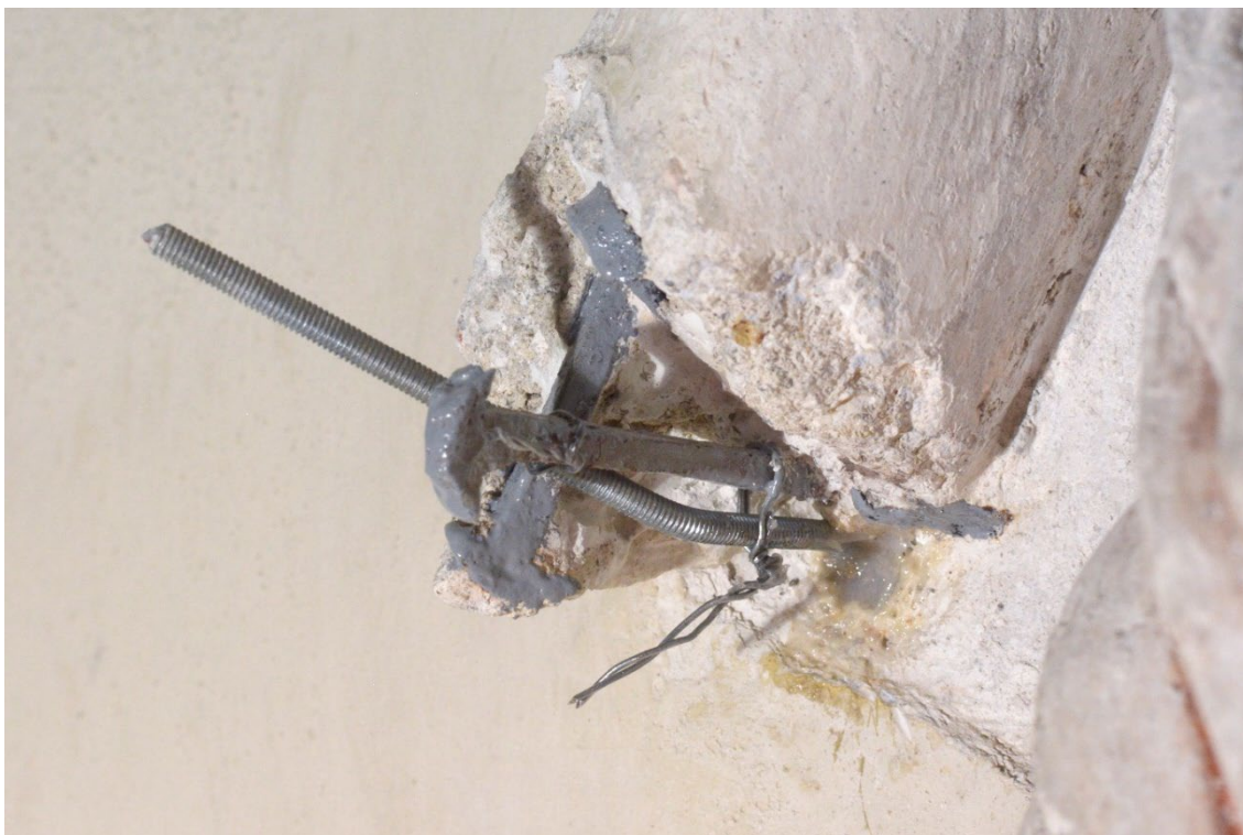
Obr. 144: Povrchová úprava odhalených zkorodovaných armatur a instalace nové armatury pro uchycení odděleného předloktí Krista.
