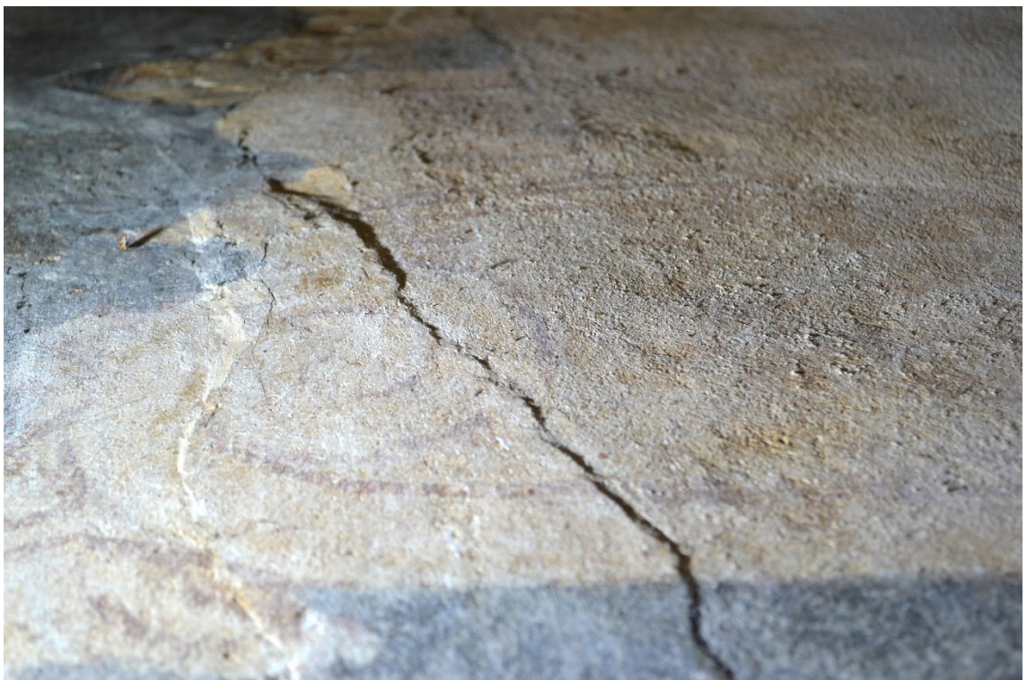
Obr. 83: Detail malby v ostrém bočním nasvícení, kde je jsou patrné trhliny způsobující výškový rozdíl omítky.
