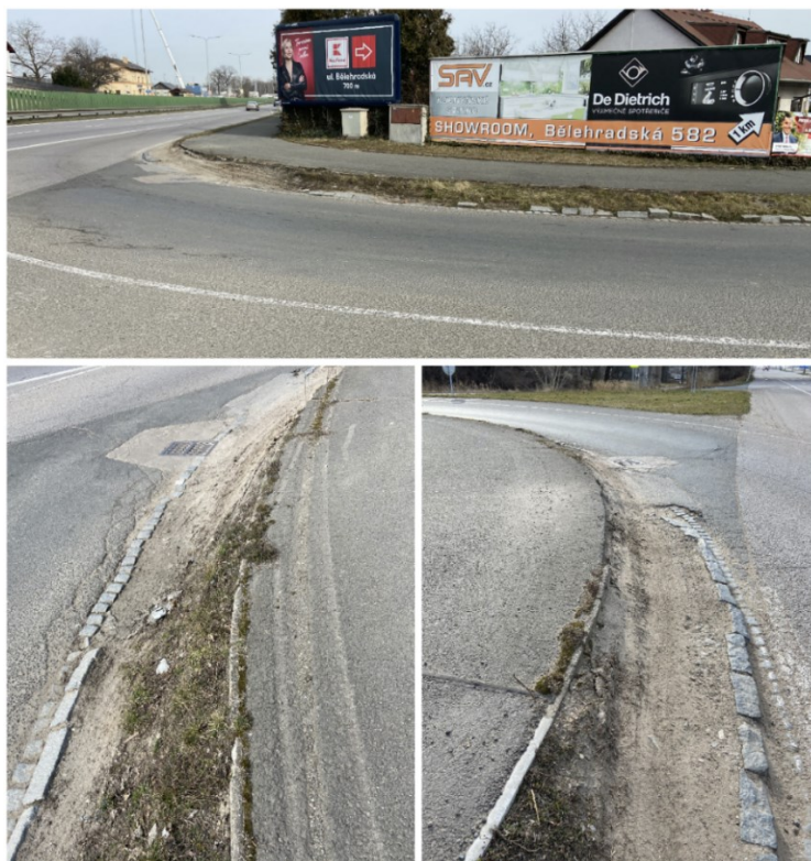
Obrázek 22 – Porucha na vnitřní straně oblouku
