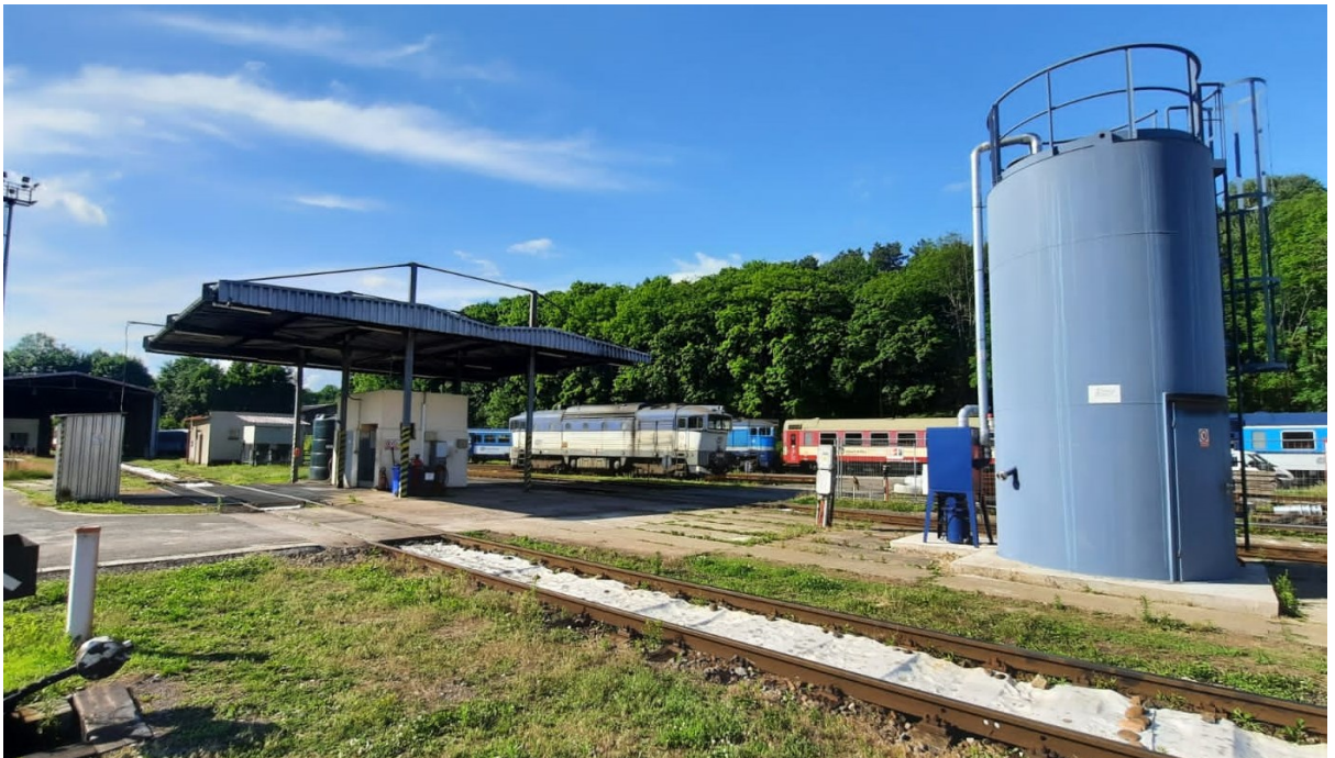
Obr. 2 Celkový pohled na čerpací zařízení Střediska údržby Trutnov
