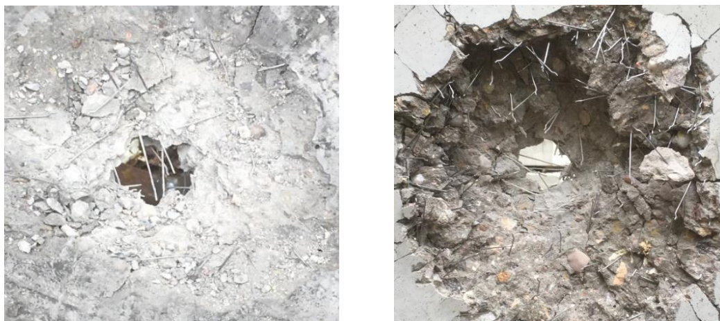
Obrázek 18. – Detail poškození po zkouškách desek na odolnost proti výbuchu viz příloha C.
