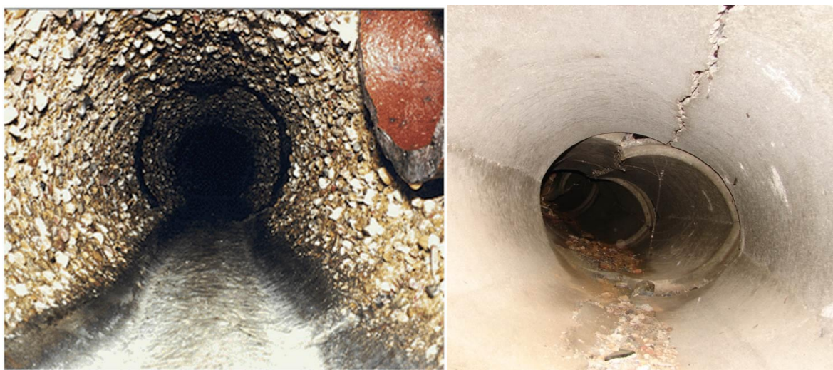
Obr. 4.25 Ukázky poškození betonového kanalizačního potrubí: (a) oslabení stěn v důsledku síranové koroze betonu a (b) prolomení potrubí (foto R. Schejbal).
