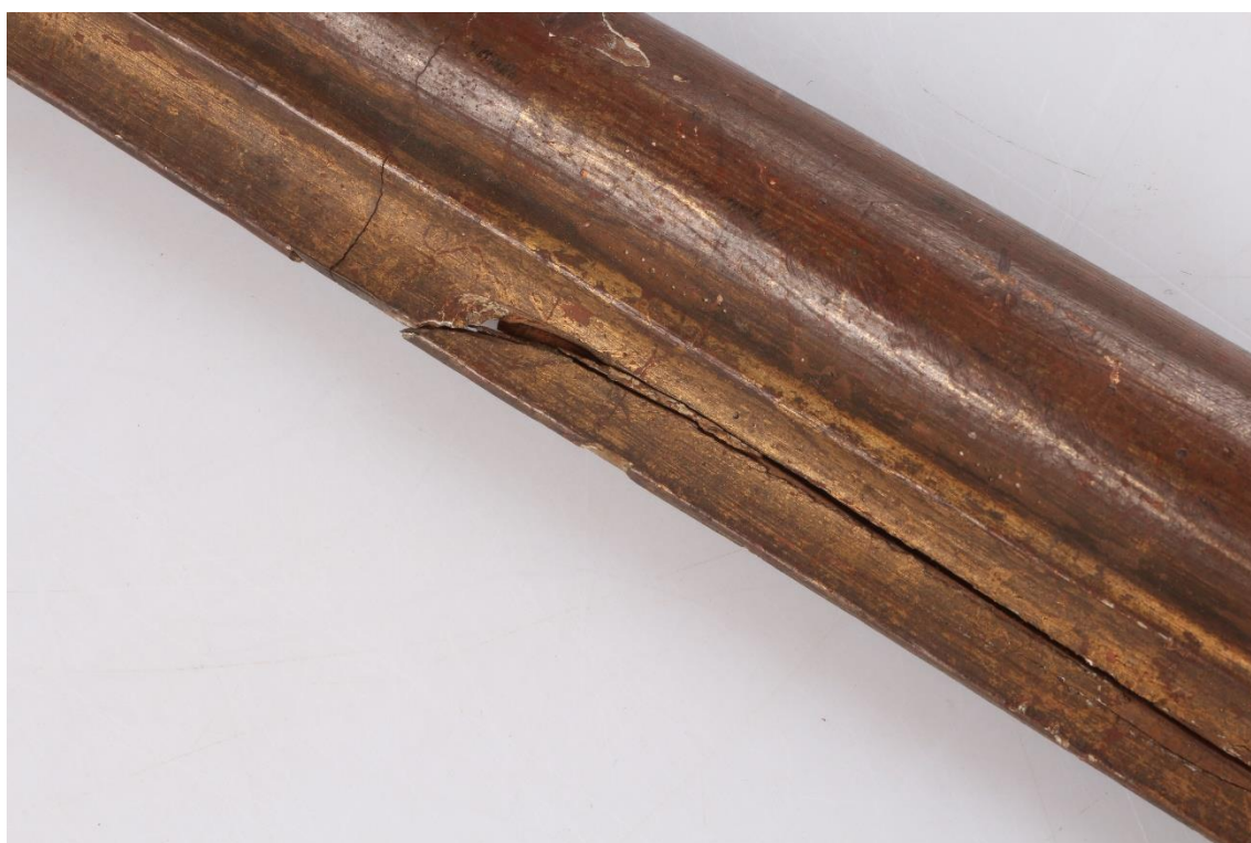
Obr. 26: Stav díla před restaurováním, detail poškození vnitřní lišty rámu, lícová strana, rozptýlené světlo
