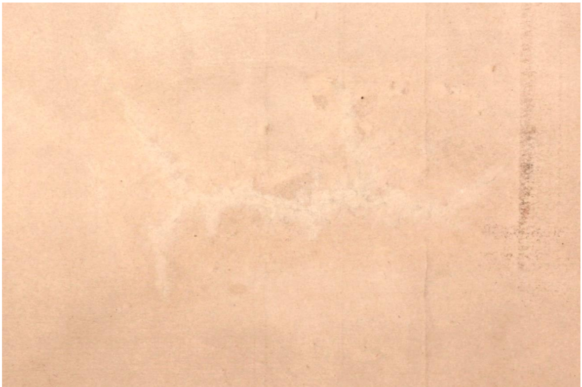
Obr. 44 Detail trhliny po procesu dolívání
