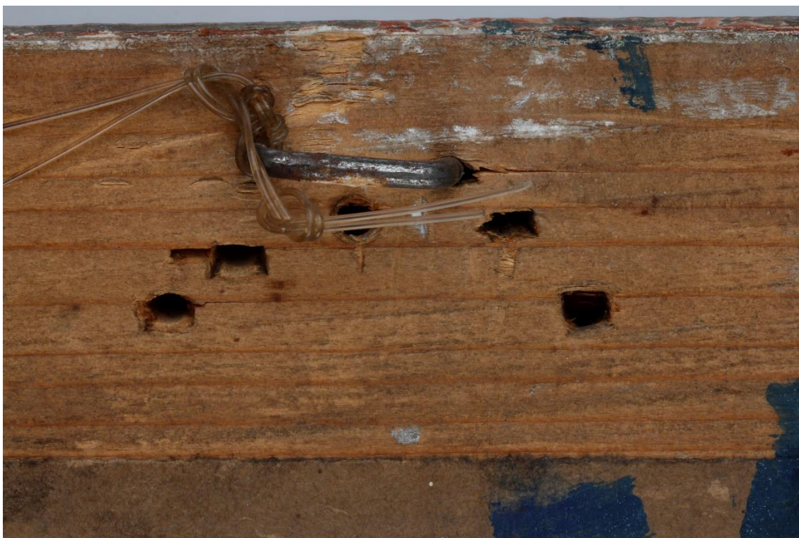
Obr. 48 Stav před restaurováním, detail závěsného systému a poškození rámu
