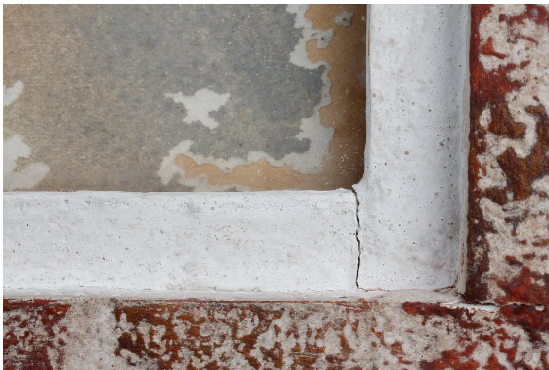
Obr. 36 Stav před restaurováním, detail poškození
