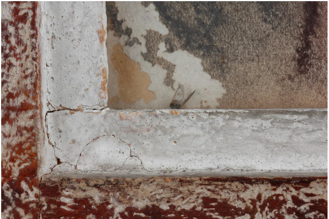
Obr. 34 Stav před restaurováním, detail poškození
