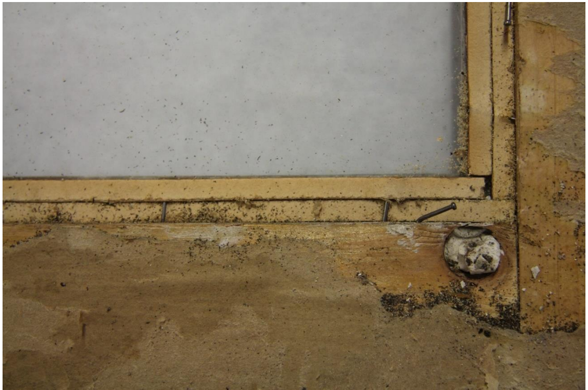
Obr. 46 Stav před restaurováním, detail znečištění, poškozená distanc
