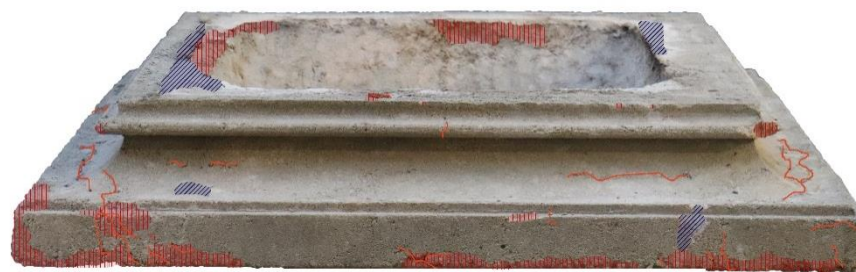
Obr. 176. Grafická dokumentace poškození hlavice strana c
