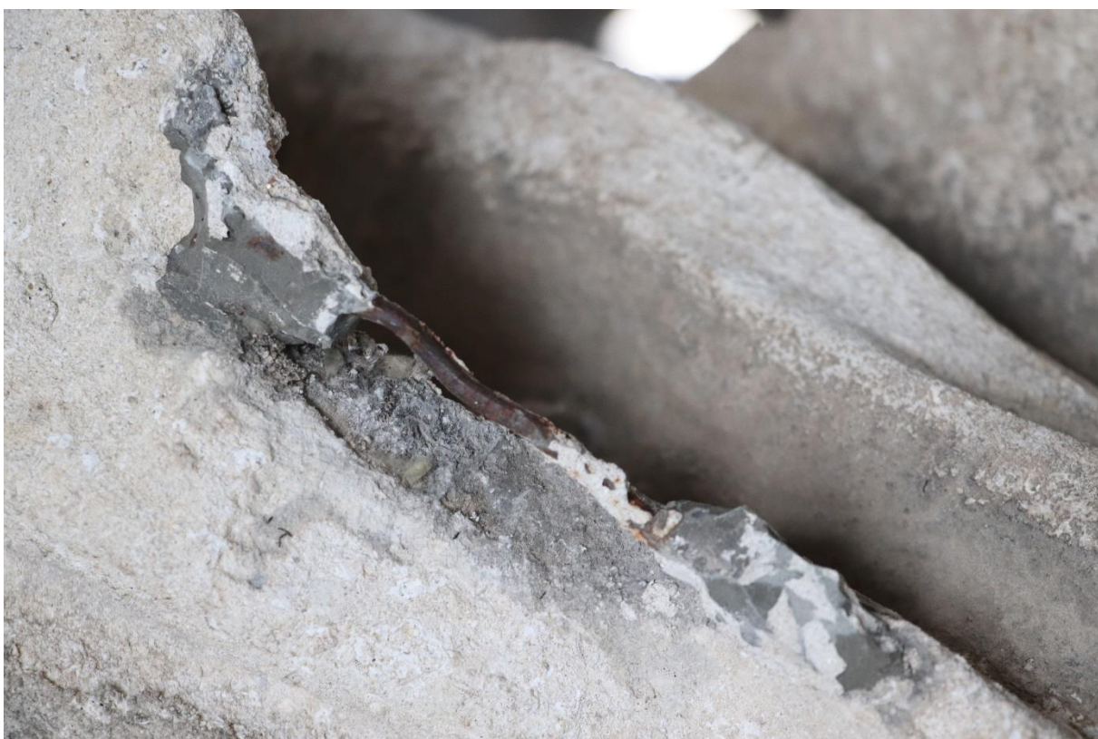
Obr. 39 Detail kovových armatur na tmelené části z předchozího restaurátorského zásahu
