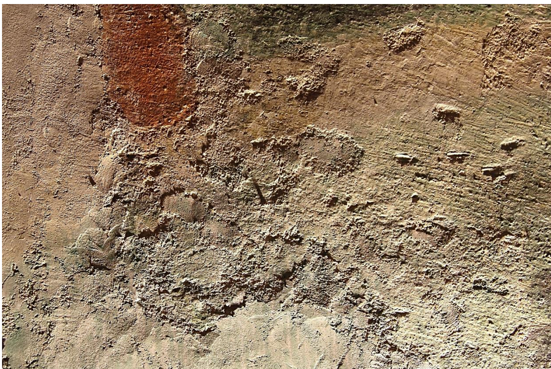
Obr. 33: Detail sekundárních tmelů v ostrém bočním nasvícení. V pravé části fotografie jsou viditelné stopy nejspíše po restaurátorském kladívku. Stav před restaurováním.
