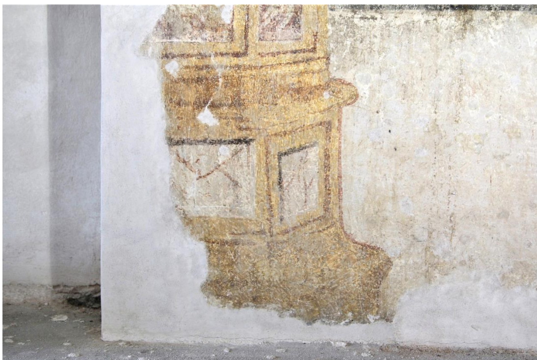
Obr. 94: Detail patky pravého ostění západního portálu. Stav po vytmelení.
