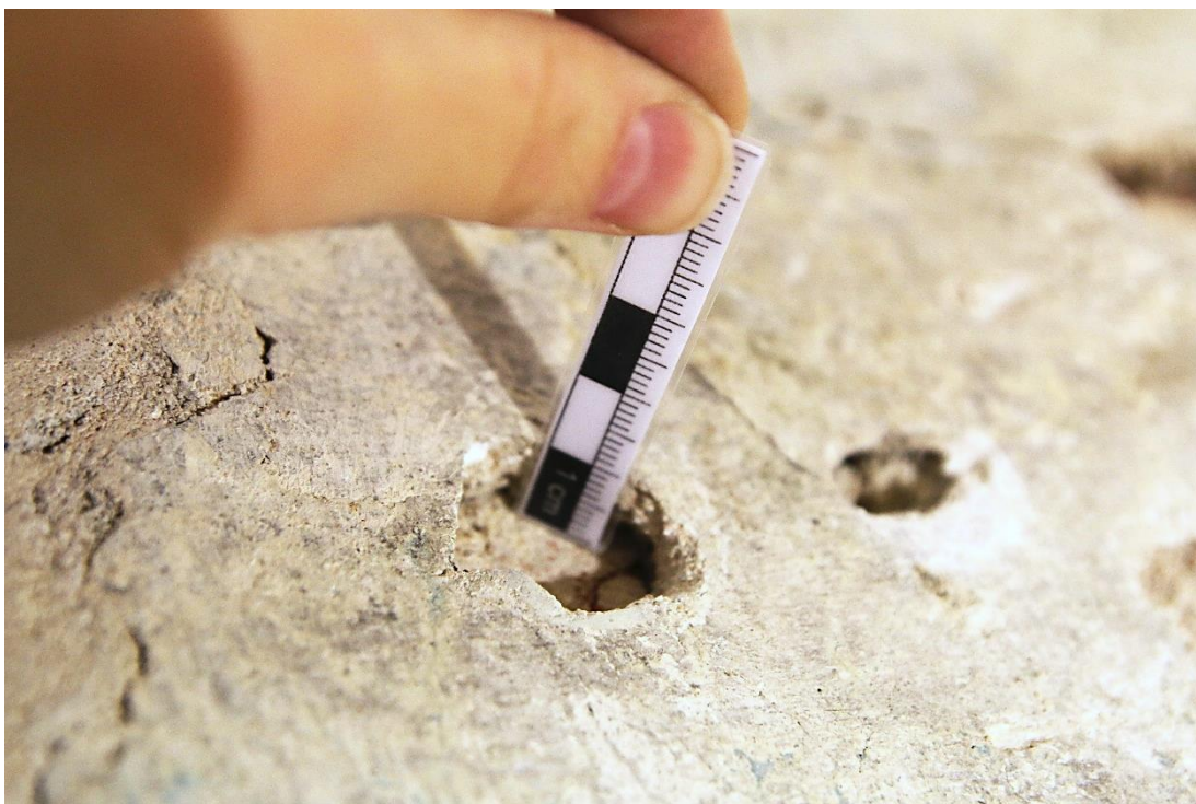
Obr. 41: Tloušťka původní omítkové vrstvy (1 cm) v horní části restaurovaného výjevu. Stav po odstranění tmelů.
