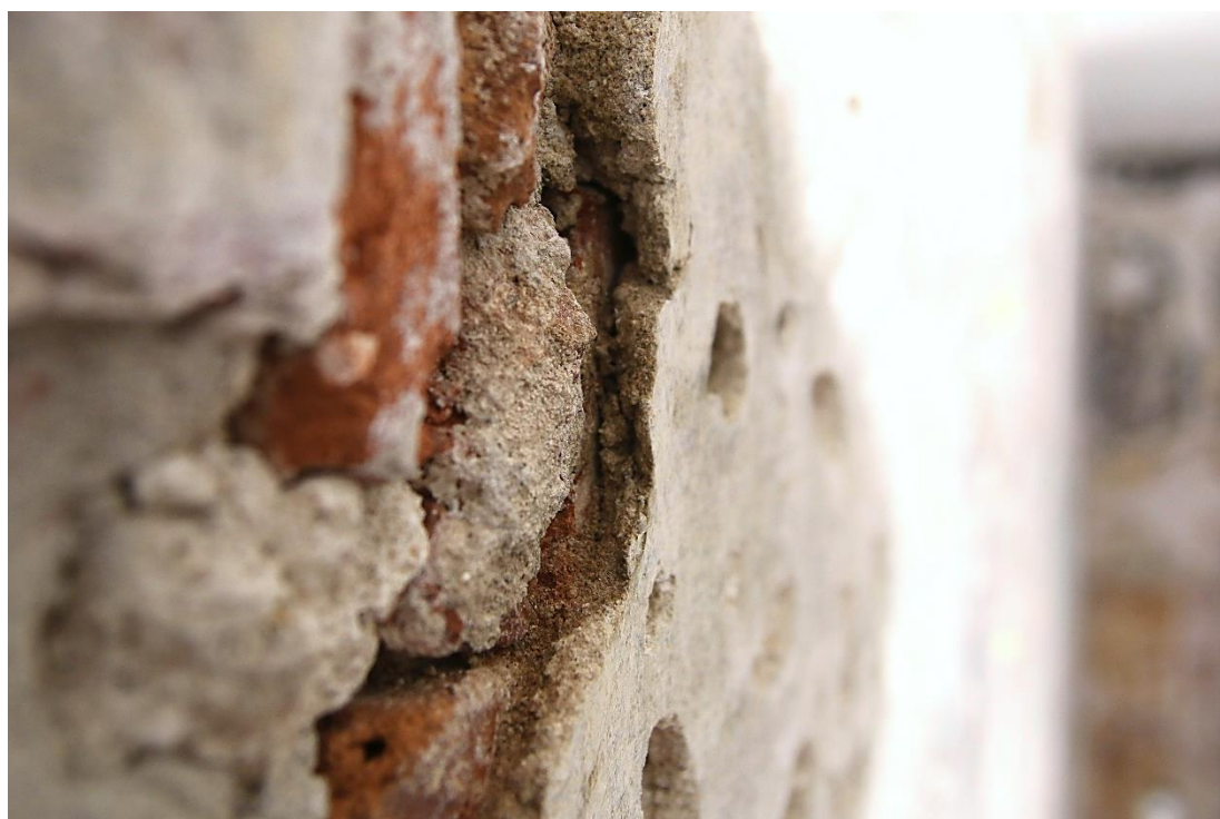
Obr. 46: Vrchní část výjevu v oblasti oblohy po odstranění velkoplošných tmelů. Na fotografii je patrná špatná adheze originální omítkové vrstvy vůči zdivu.
