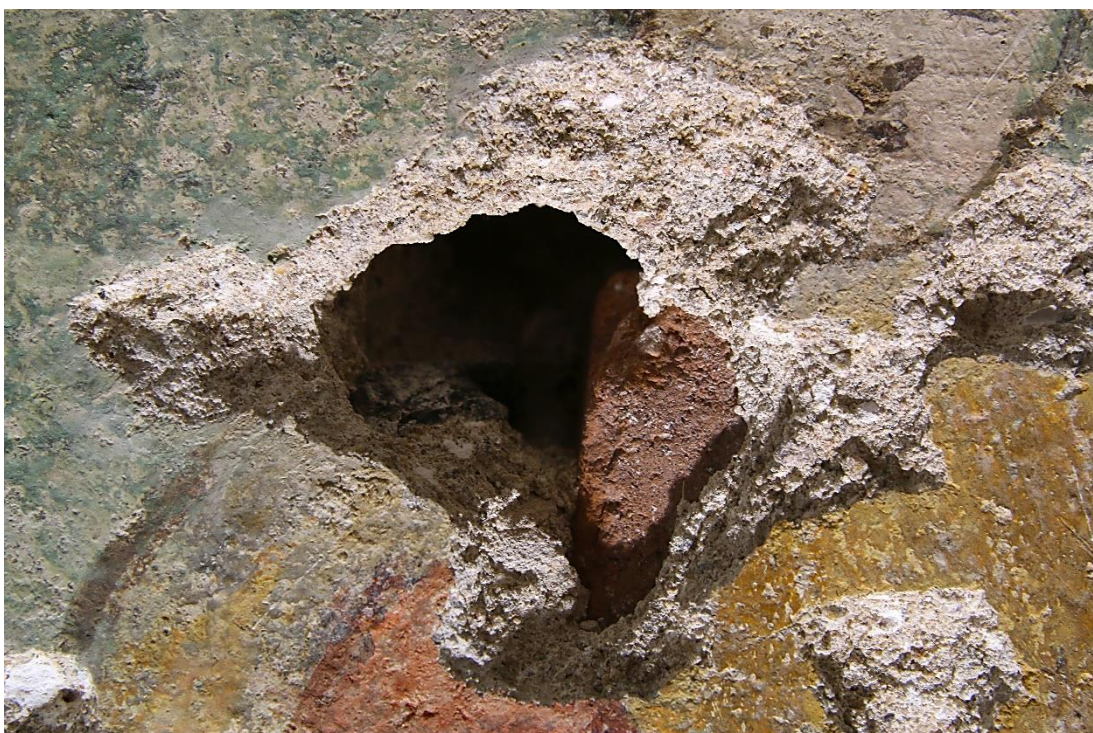
Obr. 42: Detail dutiny ve zdivu způsobené zjevně nedostatečným zaplněním prostoru spáry mezi cihlami. Střední část restaurovaného výjevu v oblasti skupinky lidí vedoucí slepce. Stav po odstranění tmelů.
