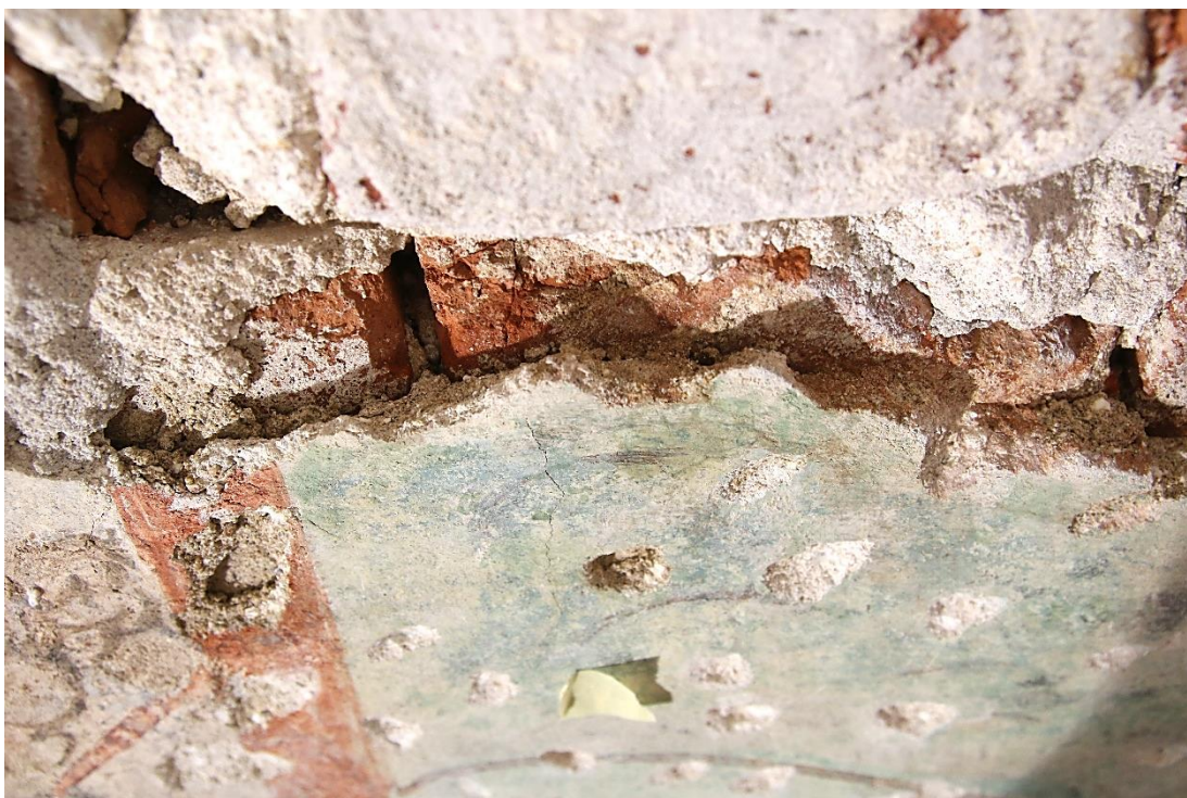
Obr. 45: Vrchní část výjevu po odstranění velkoplošných tmelů. Na fotografii je patrná špatná adheze originální omítkové vrstvy vůči zdivu.
