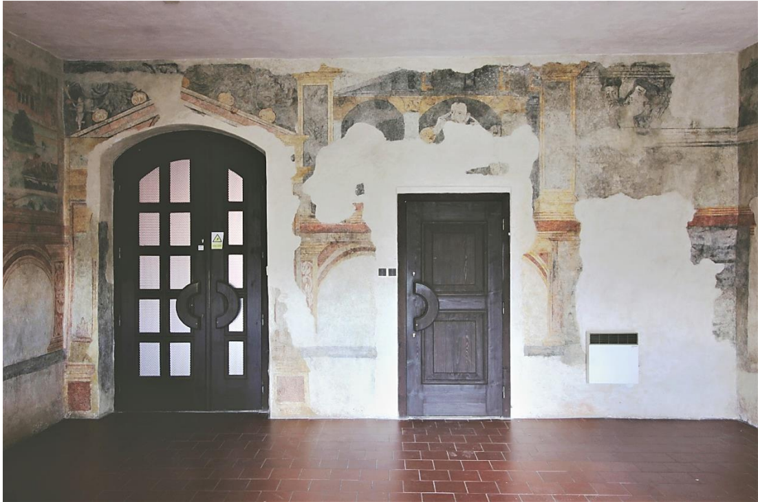
Obr. 8: Celkový pohled na severní stěnu místnosti. (Zdroj: BERANOVÁ, Anežka, Jana WAISSEROVÁ a Zuzana WICHTERLOVÁ. Dokumentace restaurátorského průzkumu: Průzkum nástěnných maleb v 1. patře nám. Míru čp. 480, Slavonice . 2018. Zdroj: soukromý archiv autorů.)
