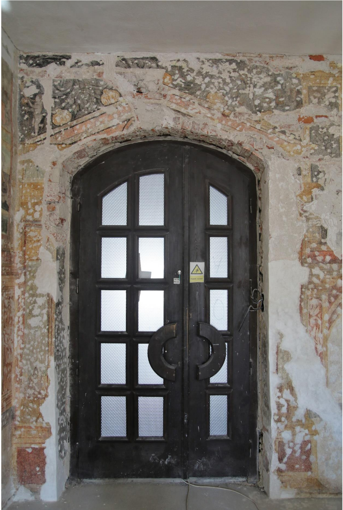
Obr. 96: Celkový pohled na iluzivní portál na severní stěně místnosti. Stav v průběhu tmelení. (Fotografie: Anežka Holečková)
