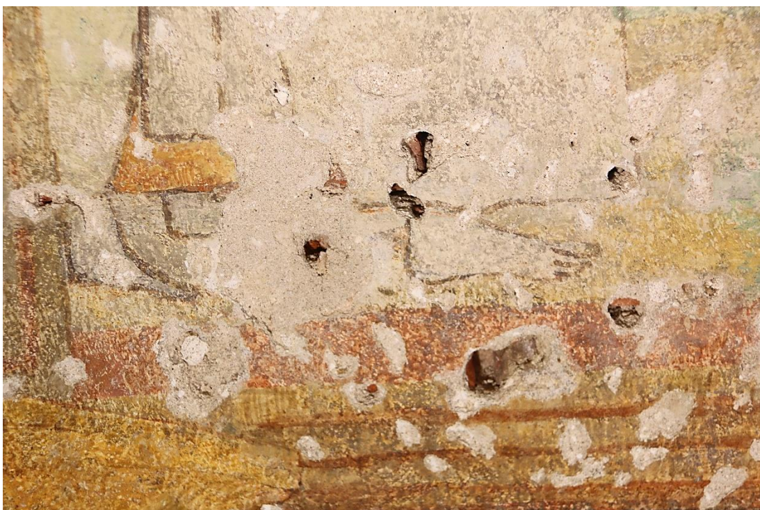
Obr. 62: Detail nohou Krista a apoštolů. Stav po odstranění tmelů. Na fotografii jsou viditelné místa se ztrátou původní omítky a s dutinami ve zdivu.
