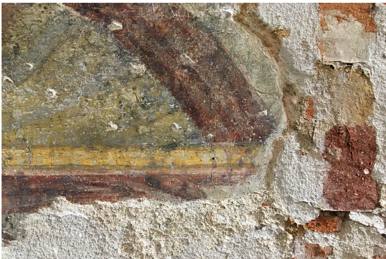
Obr. 30: Postup práce - Detail nevyhovujícího velkoplošného tmelu v oblasti po trámoch. Stav pred restaurovaním.
