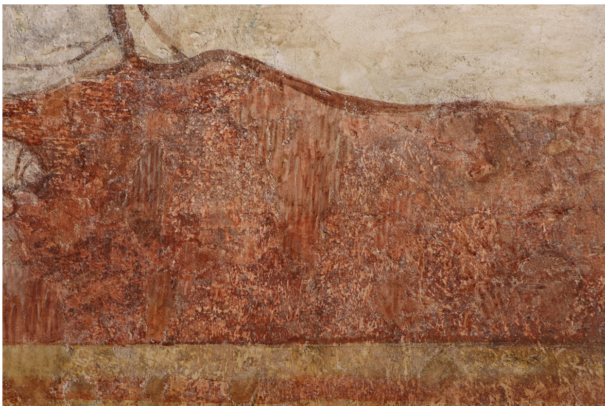
Obr. 25: Detail na čárkovou retuš na původní omítce. Zřejmě provedena v místě ztráty barevné vrstvy. Část se nachází vpravo polovině výjevu Svatba v Káni Galilejské. Tato oblast není předmětem restaurování autorkou dokumentace. Stav před restaurováním.
