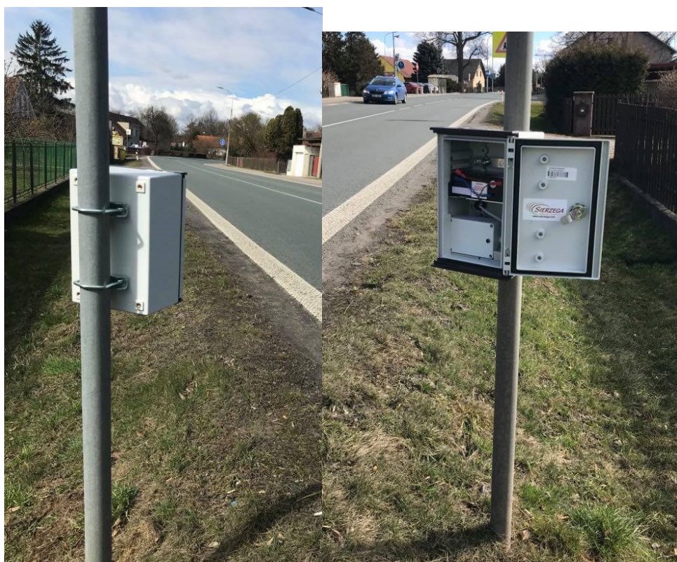
Obrázek 17 Fotografie z instalace detektoru
