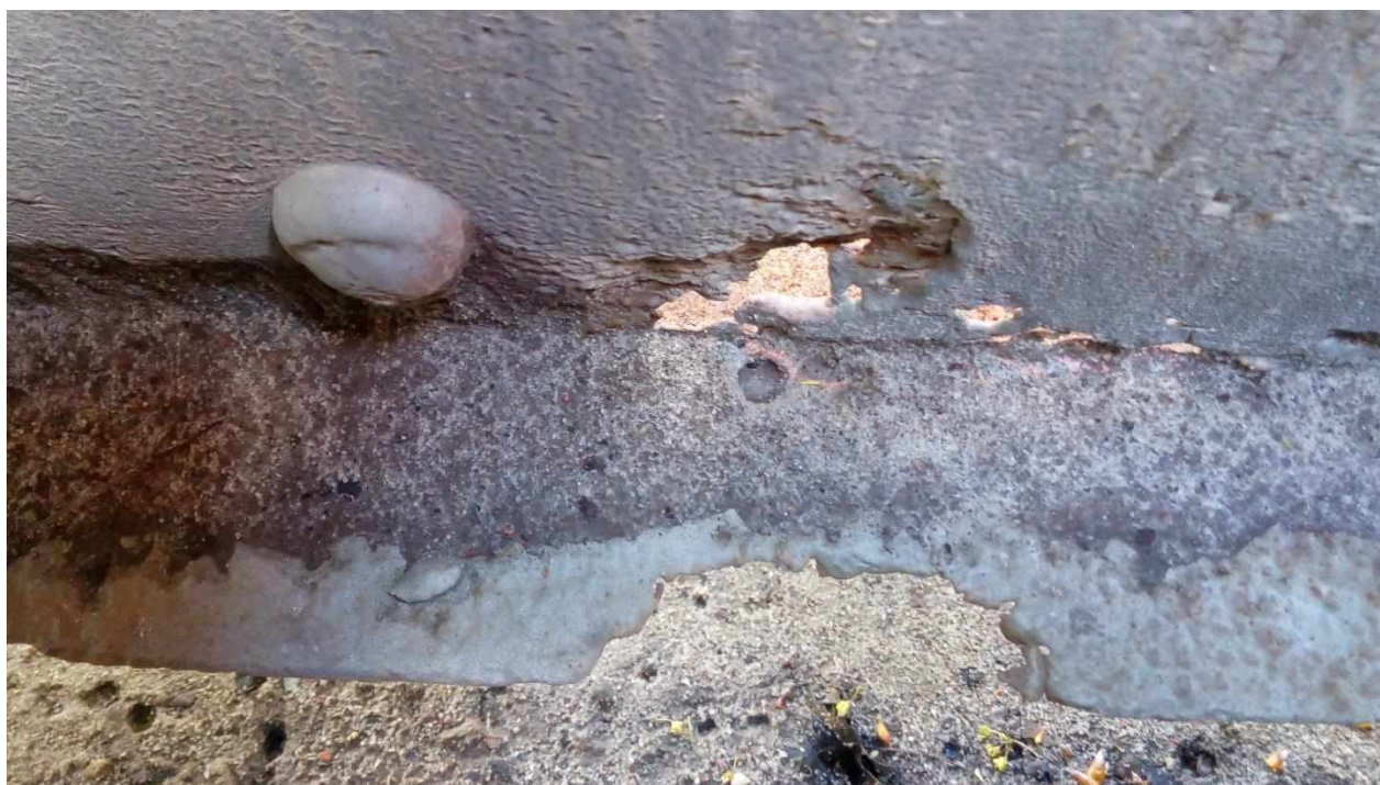
Obrázek 18: Detail největšího oslabení příčniku nad opěrou 01 (1)
