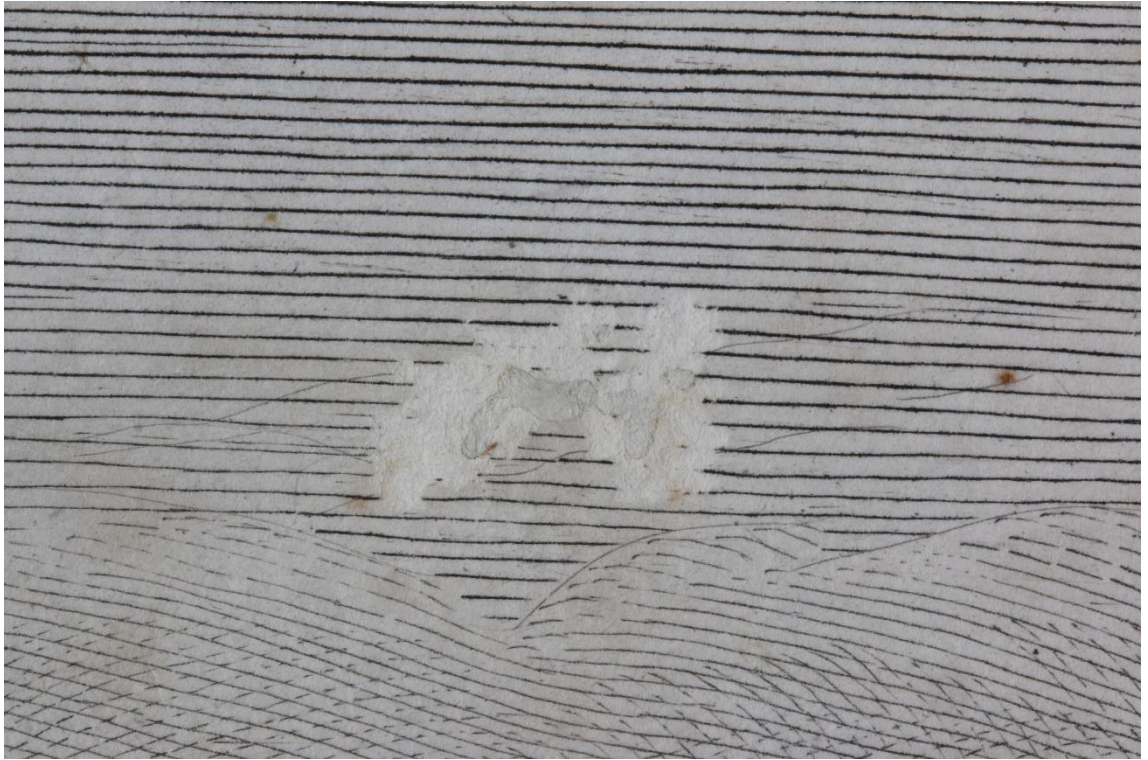
Obr. 22 Detail poškození hmyzem a jeho vysprávka z předchozího restaurování, líc
