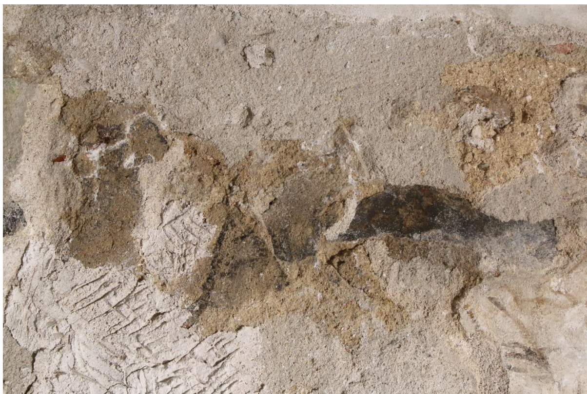
Obrázek č. 32 – Střední část výjevu, nalezené fragmenty odlišné jádrové omítky a kamene se zčernalým povrchem nejasného původu (snad saze).
