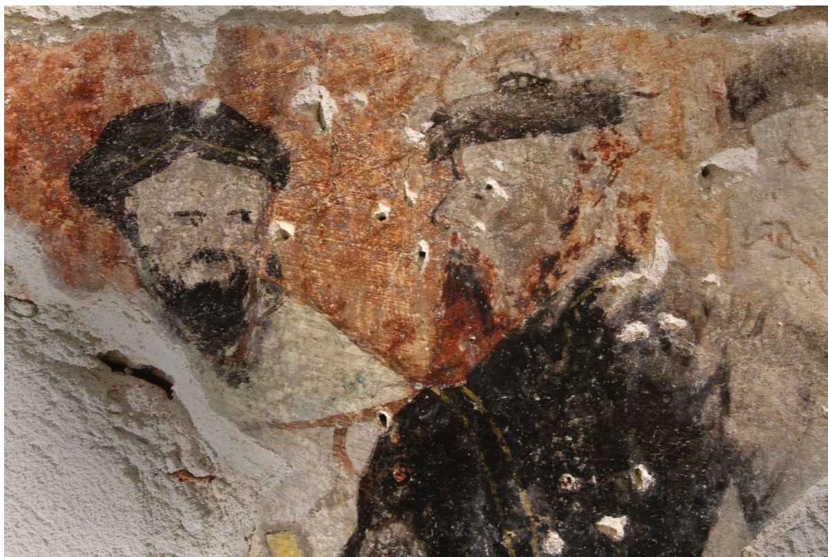
Obrázek č. 30 – Pravá horní část výjevu, původní barevná vrstva, přibližně uprostřed otvory po injektáži z roku 1992 po odstranění tmelů.
