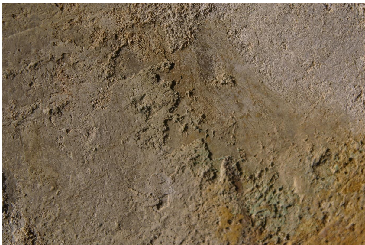
Obrázek č. 18 – Detail „odlišné“ omítky u velkého tmelu v pravé dolní části výjevu, průzkum v bočním nasvícení.
