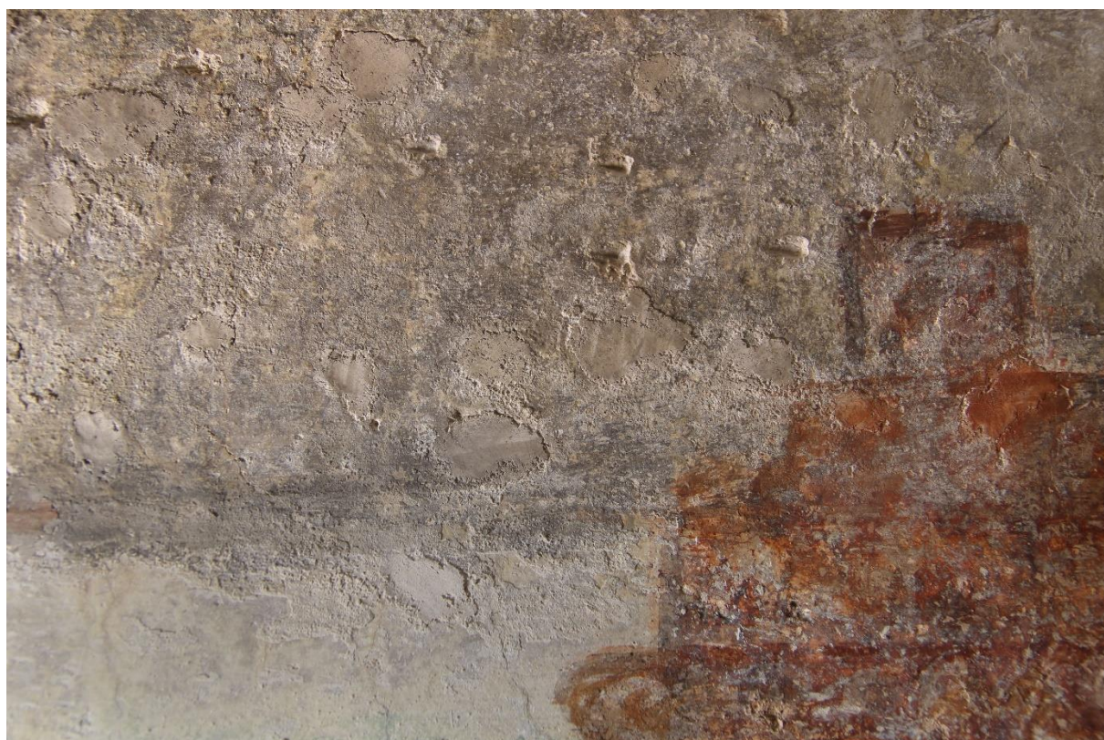
Obrázek č. 20 – Nevyhovující druhotné tmely v pravé horní části výjevu, průzkum v bočním nasvícení.
