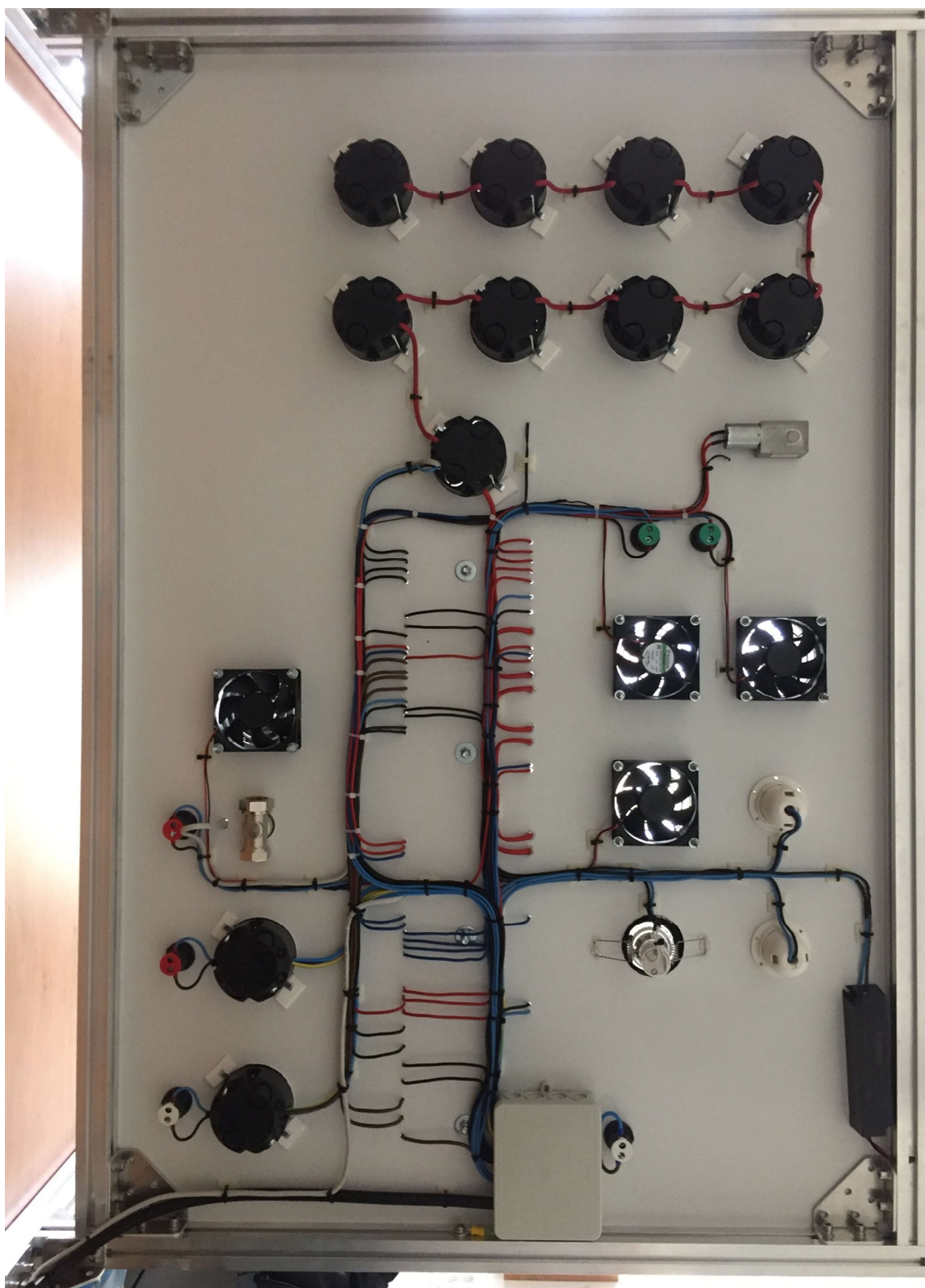
Příloha C Výukový panel inteligentní instalace iNELS II – pohled zezadu
