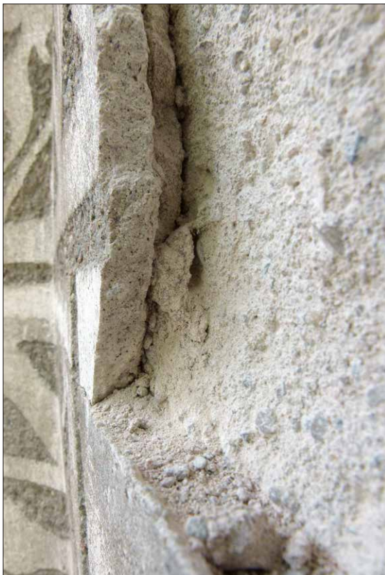
Obr. 242 Jádrová omítka nemá téměř žádnou soudržnost - "sype se" a je odtržená od jádrové omítky.
