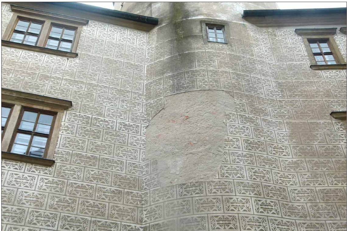
Obr. 229 Celoplošné rekonstrukce sgrafit ze 70. let 20. století na fasádách na II. nádvoří SZ Náchod. Stav 2018 (rozsah odpadlého defektu).
