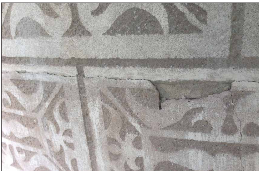
Obr. 236 Rozhraní denních dílů jsou skrytá ve vodorovných páscích (viz obr.). Postup nanášení byl zezhora dolů, v místech překryvů se velice často táhne vlasová trhlina a omítka odděluje. II. nádvoří.
