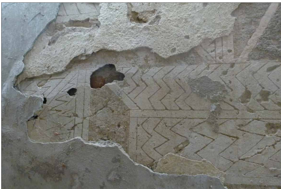
Obr. 280 Poškození původního intonaca. Omítka je ve velkém rozsahu nesoudržné k podkladu, popraskání sítí vlasových trhlin. Odpouknutí původní omítky od podkladu bylo způsobeno velkým tlakem a pnutím novodobých tvrdých cementových vysprávek.
