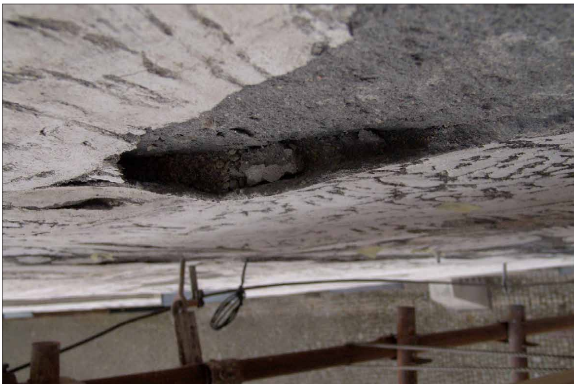
Obr. 57 Původní renesanční intonaco se víceméně v celé ploše fasády odděluje od podkladu, tedy od jádrové omítky.
