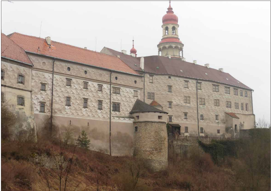
Obr. 228 Celoplošné rekonstrukce sgrafit ze 70. let 20. století na západních fasádách SZ Náchod. Foto 2018. Dobře patrné odmytí bianca.
