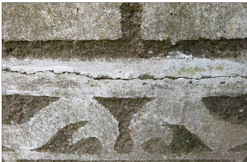
Obr. 235 Rozhraní denních dílů jsou skrytá ve vodorovných páscích (viz obr.). Postup nanášení byl seshora dolů, v místech překryvů se velice často táhne vlasová trhlina a omítka odděluje. II. nádvoří.
