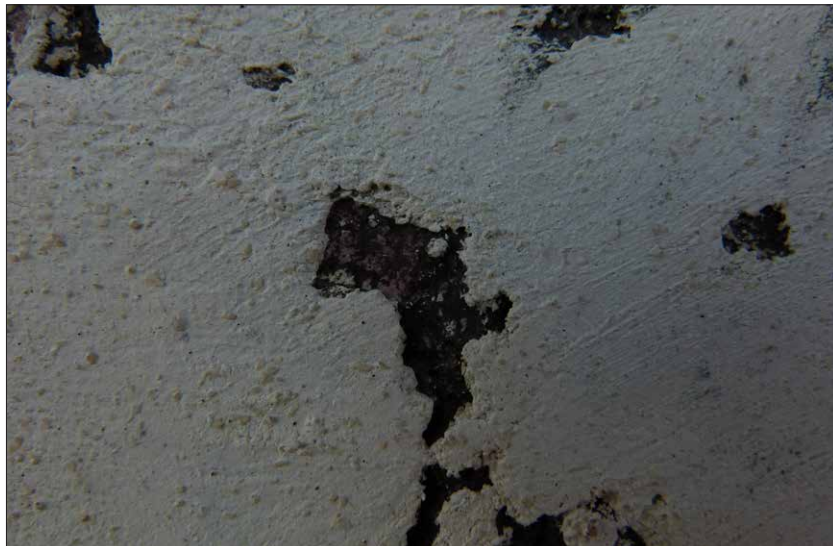
Obr. 174 Fragmenty fasádních nátěrů. Nepatrné nálezy na atice, na vlysu a pod korunní římsou. N2 světle zelená vrstva na bílém podkladu.
