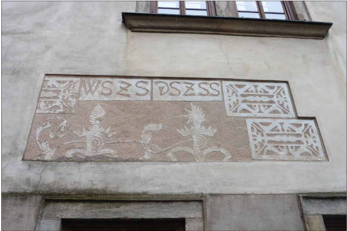
Obr. 211 SZ Náchod. Východní fasáda Piccolominského traktu (2. nádvoří) - v minulosti restaurovaný fragment sgrafita s aliančními erby velikosti cca 6 m 2 .
