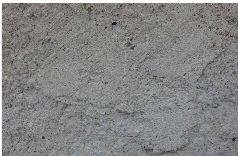
Obr. 233 Detail povrchu jádrové omítky. Je hrubý, zatažený dřevem. Povrch jádra je hrubý, zatažený dřevem a po zaschnutí je nanášeno intonaco. Lokálně jsou použity nahlávané terakotové, hladné, střešní tašky a použité do hlubších defektů. Il. nádvoří.
