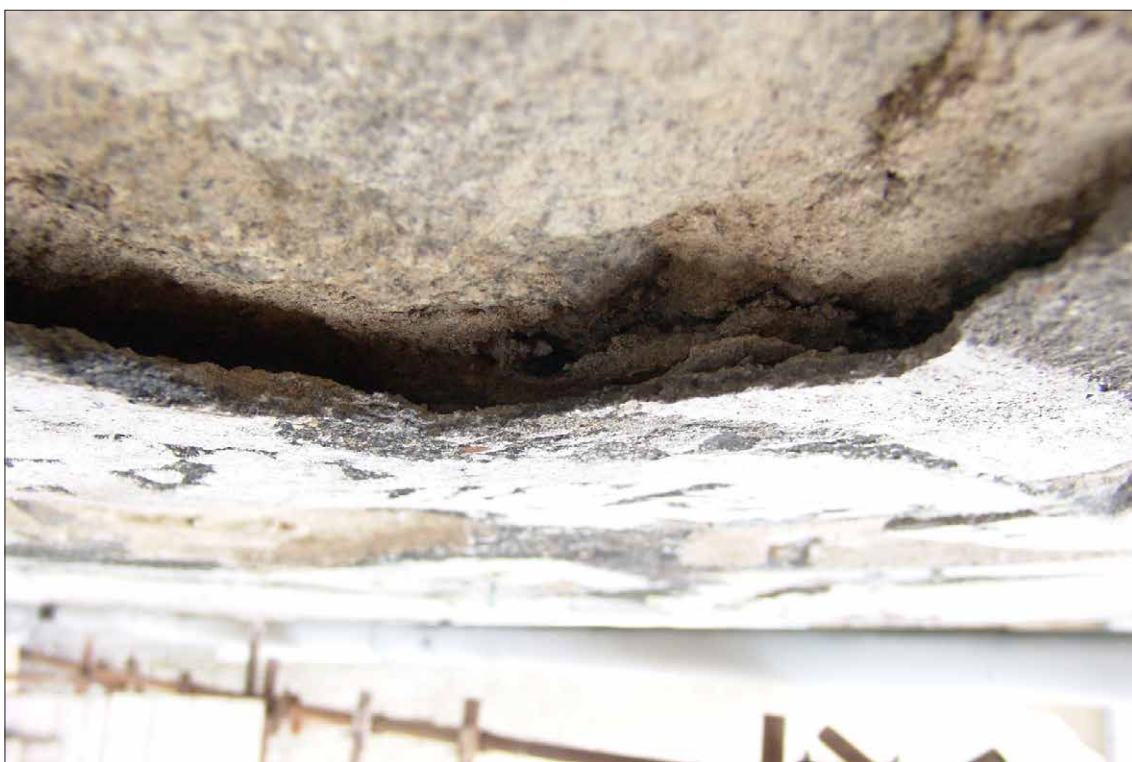
Obr. 58 Na mnoha místech se intonaco odděluje tak, že se plasticky zvedá od podkladu a vytváří "boule".
