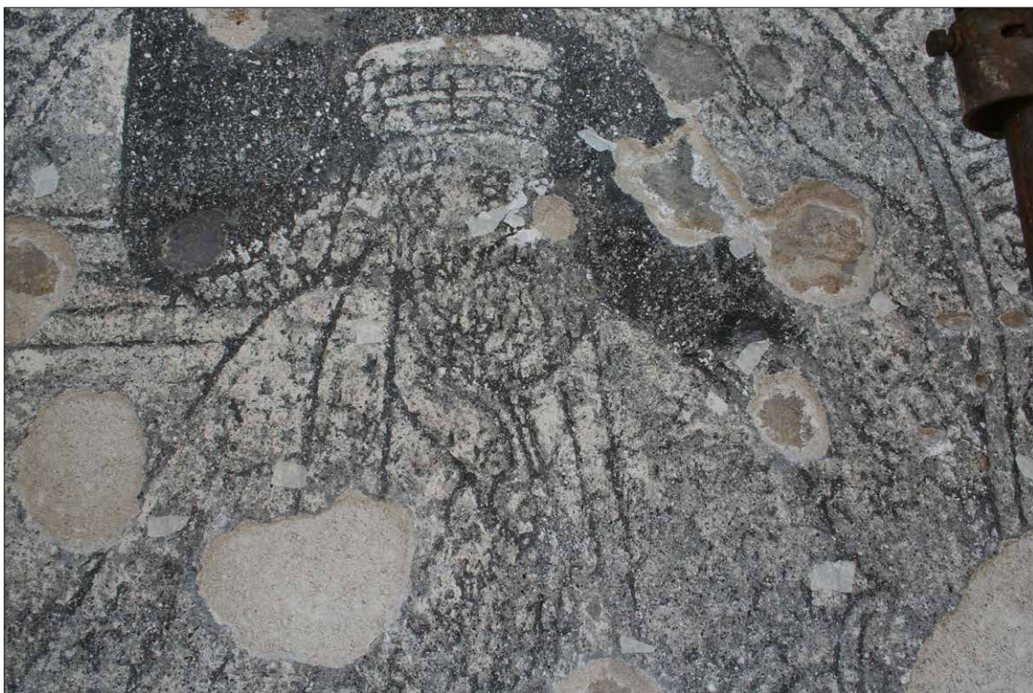
Obr. 122 Medailon č. 4 - Rudolf II. Habsburský, v průběhu tmelení jádrovou omítkou a retuší bianca na původním intonacu.
