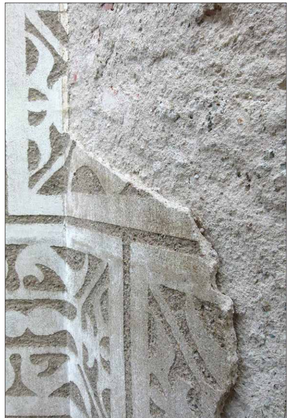
Obr. 243 Omítky intonaca se ve velkých plochách odtrhávají od zdiva a hrozí odpadnutím, či již odpadly.
