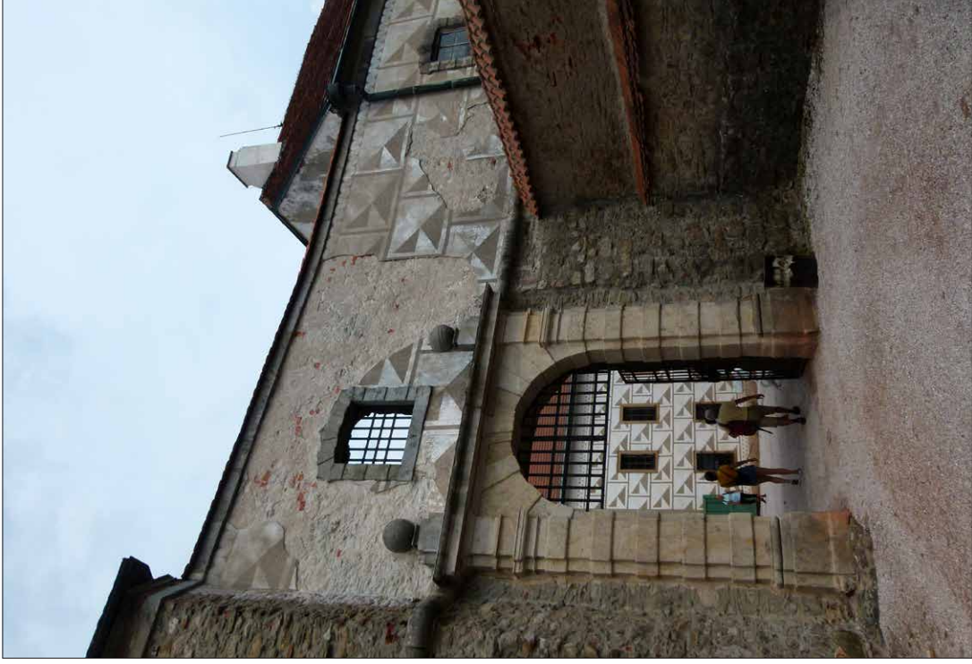
Obr. 231 Celoplošné rekonstrukce sgrafit ze 70. let 20. století byly provedeny i na kulisové bráně SZ Náchod. Z větší část odpadlé. Stav 2019.
