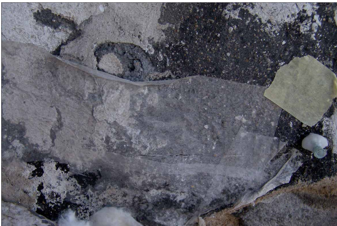
Obr. 98 Detail degradovaného původního intonaca v průběhu hloubkového zpevnění, přelepeného japonským papírem. Spodní okraj intonaca byl odhalen a obtmelen vápeným tmelem. Vpravo je místo injektáže s jehlou. Přelep je naříznut skalpelem pro lepší manipulaci nástrojů při odstraňování sypkého jádra a položení intonaca zpět na podklad.
