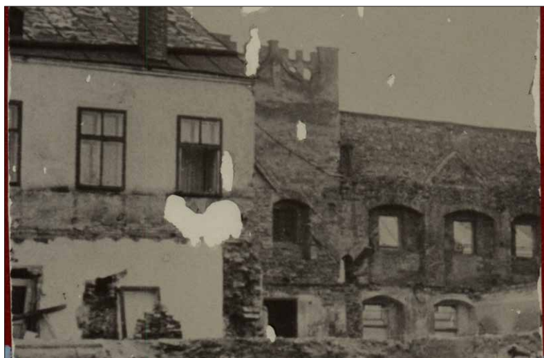
Obr. 11 Pohled zezadu na volně stojící fasádu s ubouraným domem z 50. let 20. století. Zřetelný otisk střechy a zadděný chříč ve druhém patře. ( http://www.slavonice-zlabings.eu )
