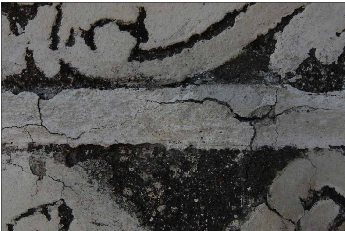
Obr. 59 V místech poškození původních omítek se nachází množství trhlin. Většinou jsou to trhliny v plochách vybouleného intonaca.
