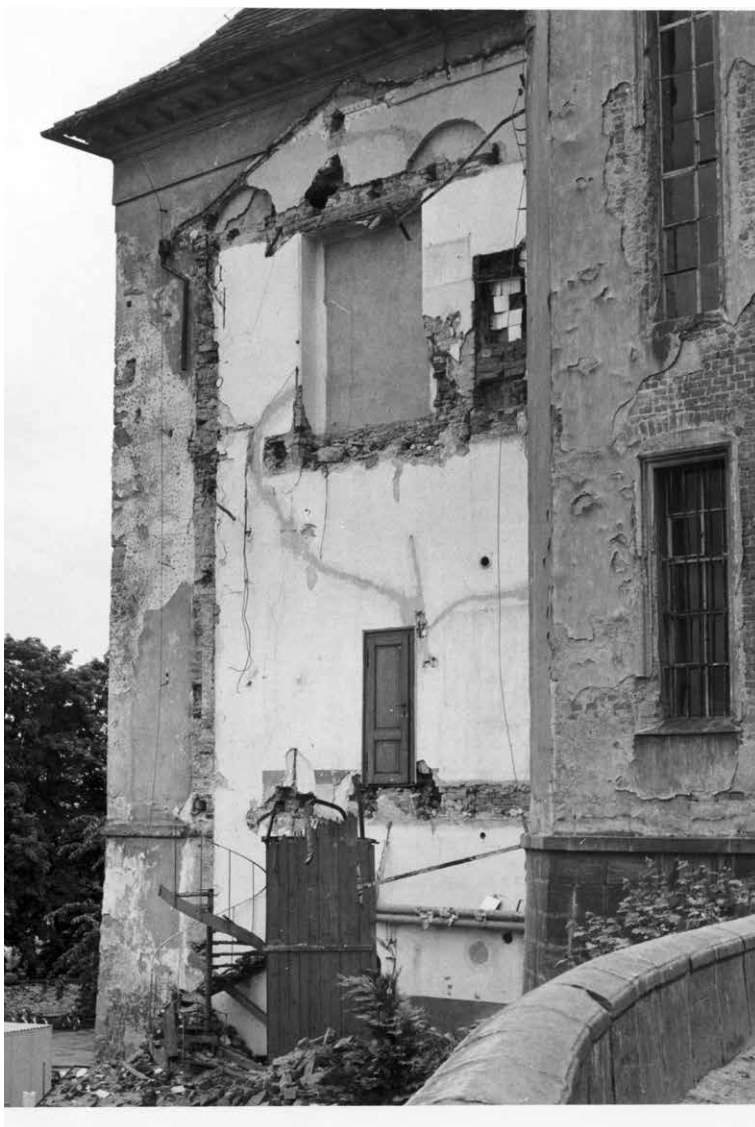
Obr. 247 Pohled na severní část východního křídla po odstranění přístavku z roku 1986. Archiv kastelána Jaroslava Bušty, SZ Slatiňany.
