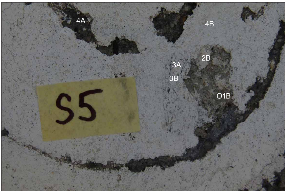
Obr. 41 Detail sondy S5 - O1B intonaco, 1 bianco chybí, 2B bílá lomená okrem, 3A světle šedá lazura, 3B bílá lomená, 4A černá lazura (sjednocující pozadí), 4B bílá silnější.
