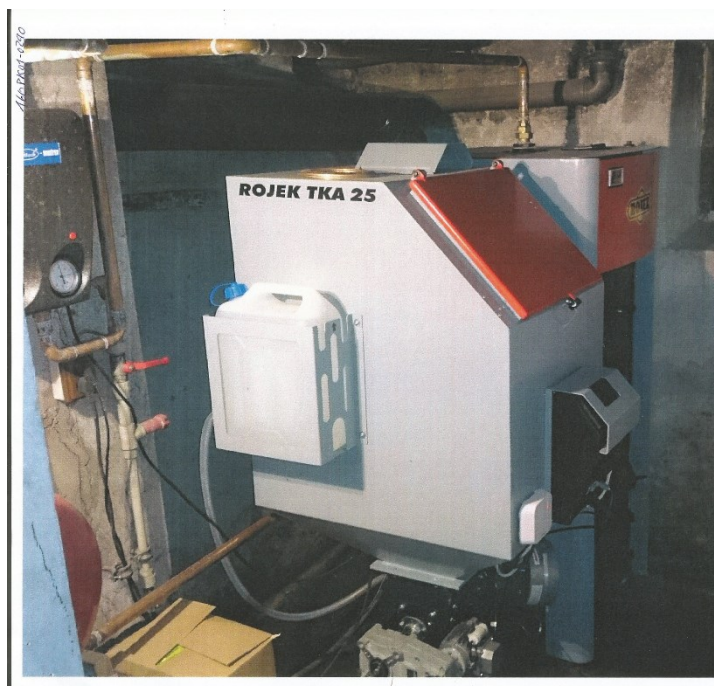
Obrázek č. 9 - Nový typ instalovaného tepelného zdroje
